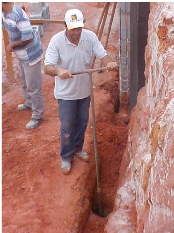
Figura 21 – Imagem de execução de estacas tipo broca empregando trado manual Fonte: Notas de aula disciplina TEC I, UFMG, 2008.
