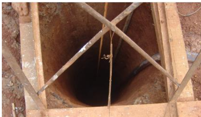
Figura 11 - Imagem do esgotamento de água do tubulão a céu aberto utilizando bombas Fonte: Notas de aula disciplina TEC I, UFMG, 2008.
