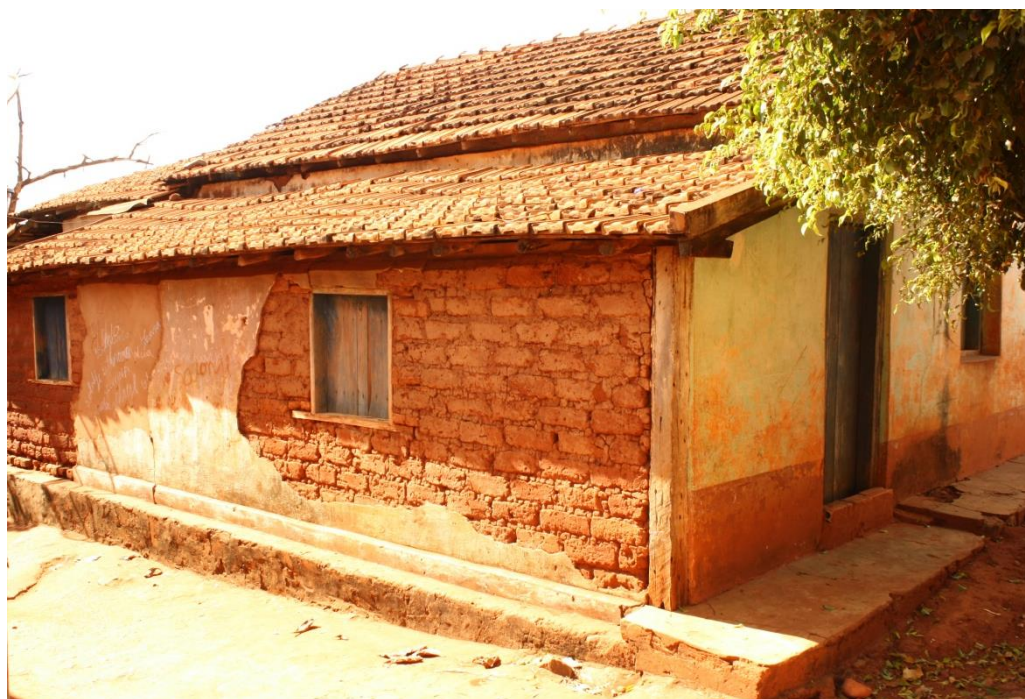
Figura 12- Habitação histórica em adobe, com revestimento das paredes laterais comprometido. Fonte: o autor
