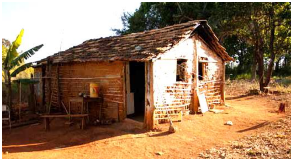
Figura 17- Habitação em pau-a-pique sem manutenção dos revestimentos. Fonte: o autor.
