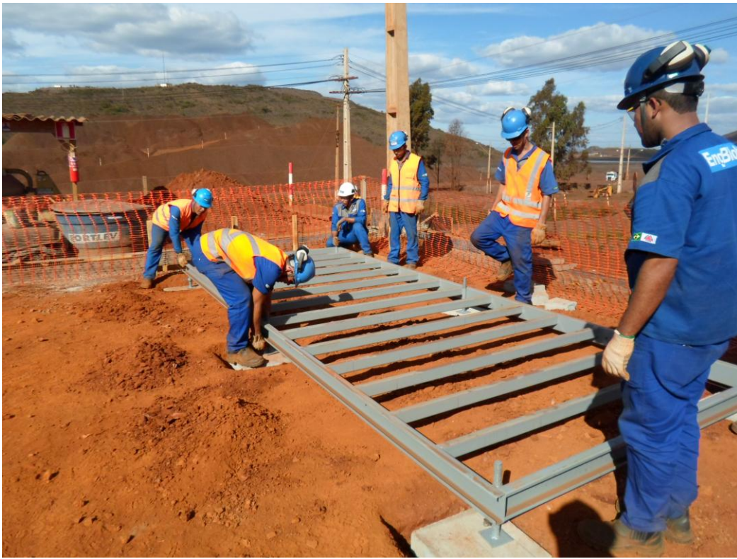
Figura 14 – Montagem de Chassi sobre sapata metálica e bloco. Fonte: Acervo do autor.
