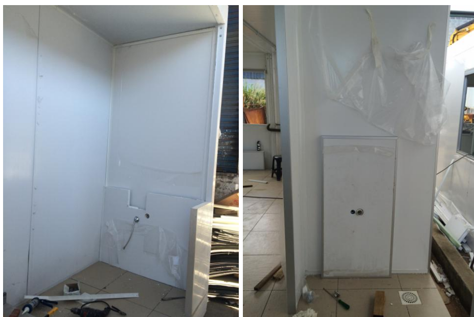
Figura 18 – Shafts em painel escondem a instalação hidráulica. Fonte: Acervo do autor.
