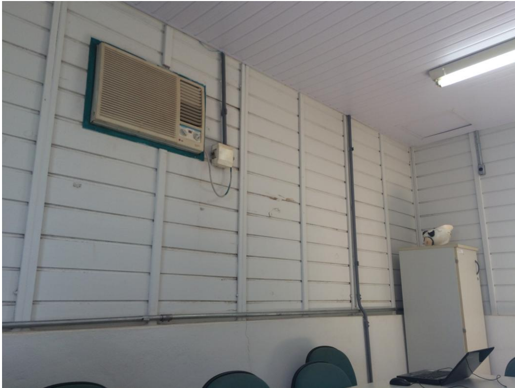
Figura 35 – Detalhe da instalação elétrica em eletroduto galvanizado. Fonte: Acervo do autor.
