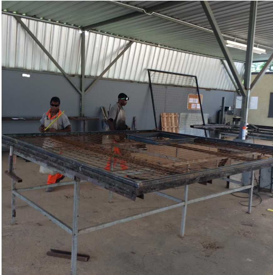
Figura 22 – Mesa de montagem de perfis e telas na fábrica. Fonte: Acervo do autor.
