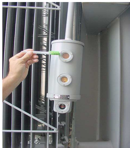
Figura 3.33 - Desumidificador do transformador elevador.
