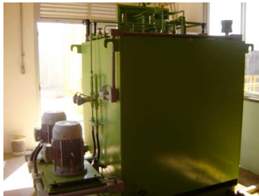
Figura 3.48 - Central óleo-dinâmica do vertedouro.
