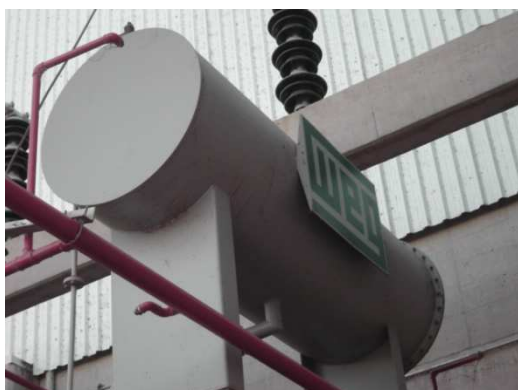
Figura 3.34 - Tanque de expansão do transformador elevador.
