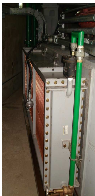
Figura 3.27 - Trocador de calor.
