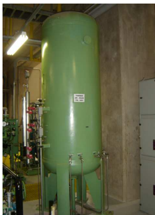
Figura 3.21 - Tanque ar-óleo para o sistema de regulação de velocidade.
