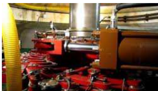
Figura 3.24 - Servomotores do sistema de regulação de velocidade.
