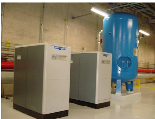
Figura 3.39 - Compressores e tanque de ar comprimido.
