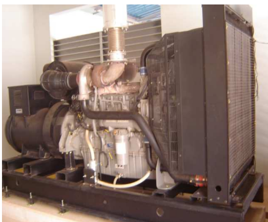
Figura 3.50 - Grupo motor gerador a diesel de emergência.
