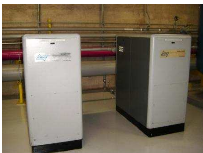
Figura 3.22 - Compressores para o sistema de regulação de velocidade.
