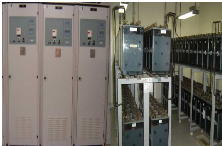
Figura 3.16 - À direita: três carregadores de baterias. À esquerda: baterias.
