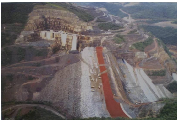
Figura 3.4: Foto de um quadro instalado na UHE Irapé, com imagem da fase final de construção da barragem. Vista geral do maciço. Fonte: Autor, 2014
