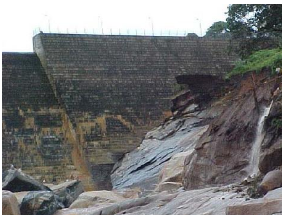
Figura 2.18: Aspecto da ruptura da fundação da barragem, vista de jusante. Fonte: Kanji, 2004.
