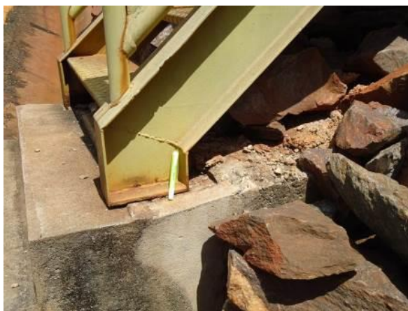
Figura 3.26: Vista de deslocamento em escada de acesso à instrumentação. CEMIG, 2014
