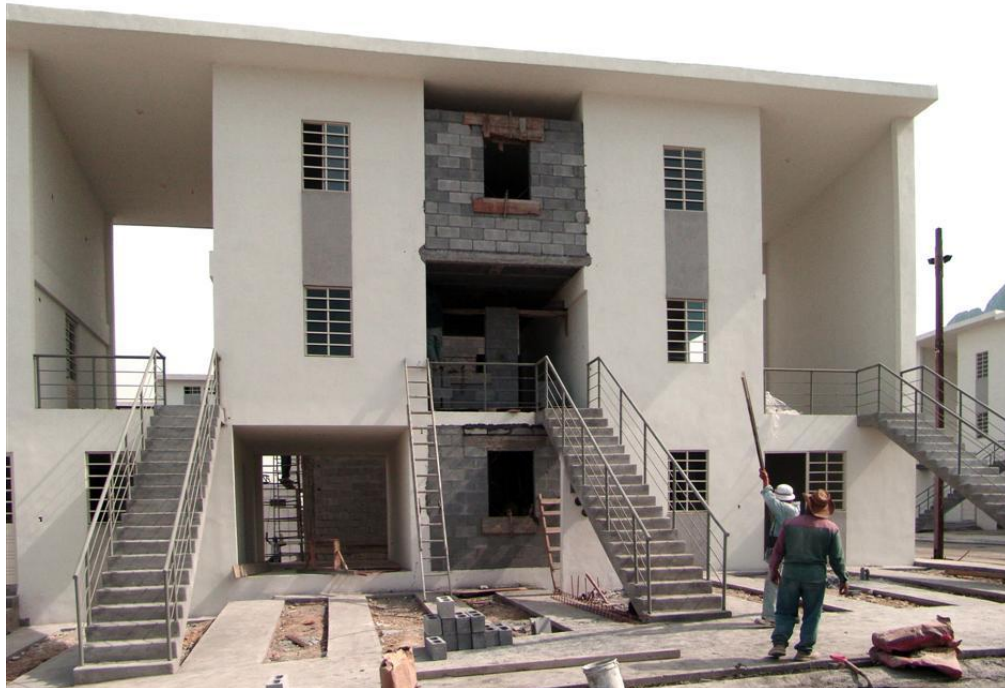
Figura 28– Elemental Monterrey – Elemental – Santa Catarina - Nuevo Leon – México. Ampliação de uma das habitações - Fonte: Archdaily
