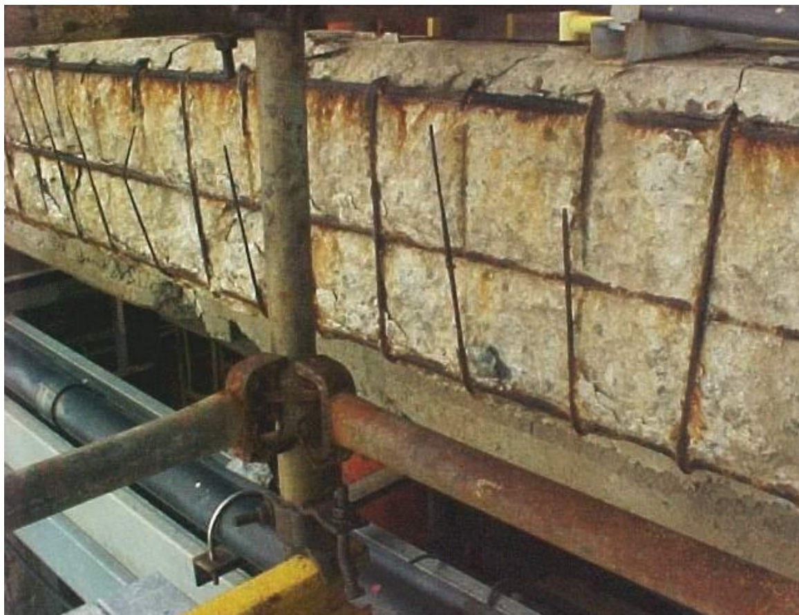
Figura 3.2 – Patologia devido ao cobrimento insuficiente em viga de concreto.
