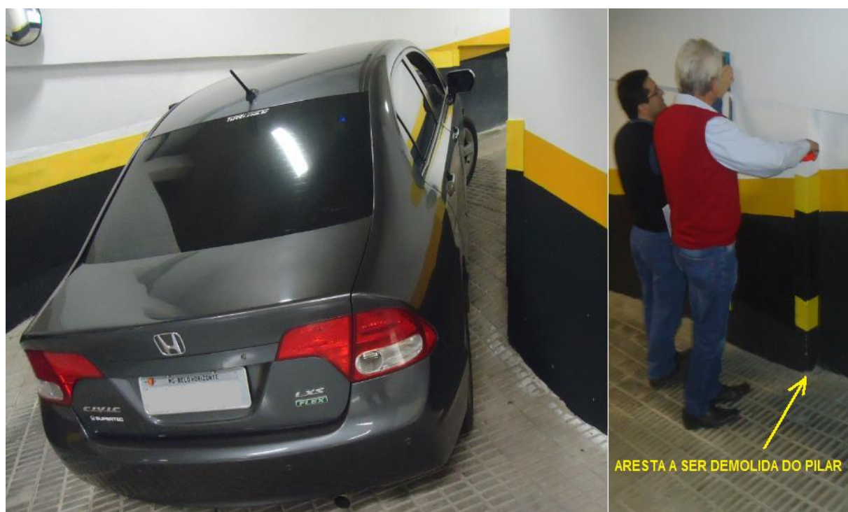
Figura 4.1 – Acessibilidade difícil. Necessidade da retirada de parte do pilar.
