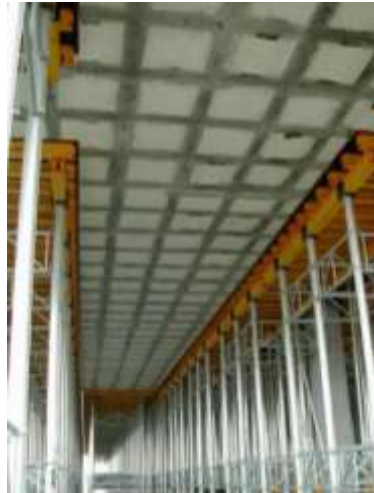
Figura 19: Escoramento do Parque Comercial Nevada, Granada, Espanha, sistema ENKOFORM e ALUPROP Fonte: ULMA Construction
