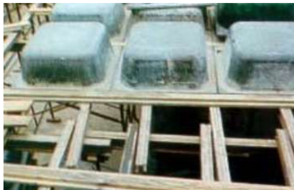
Figura 31: Cubeta apoiadas a vigas metálicas Fonte: ATEX
