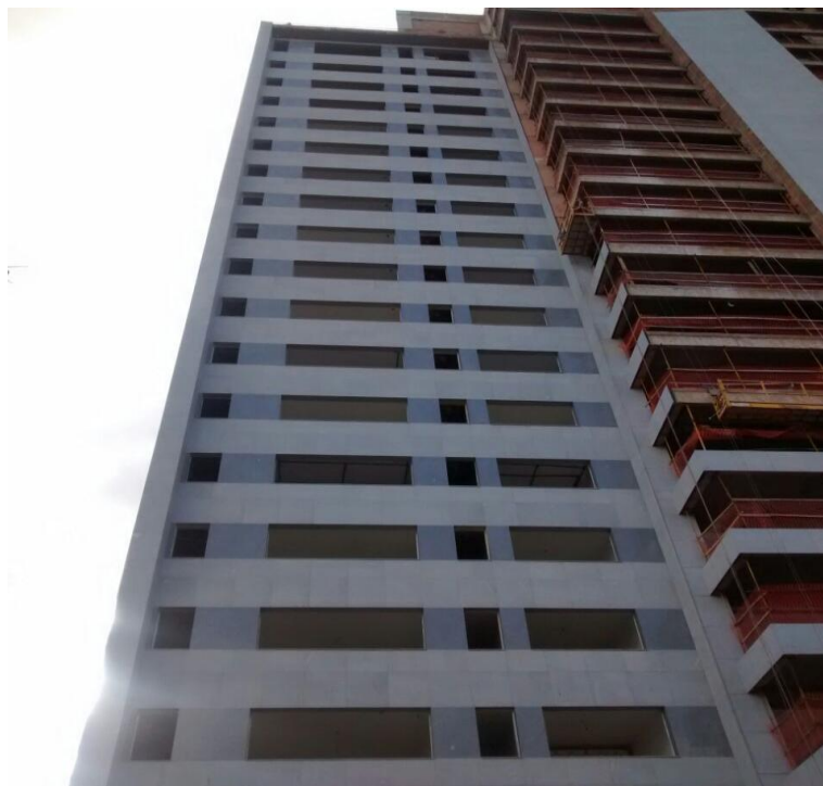
Foto 16 – Vista panorâmica do pano com interrupções das juntas verticais
