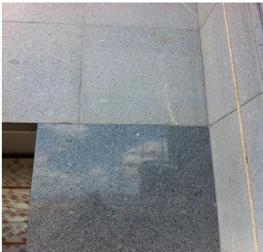
Foto 15 – Detalhe da interrupção da junta
