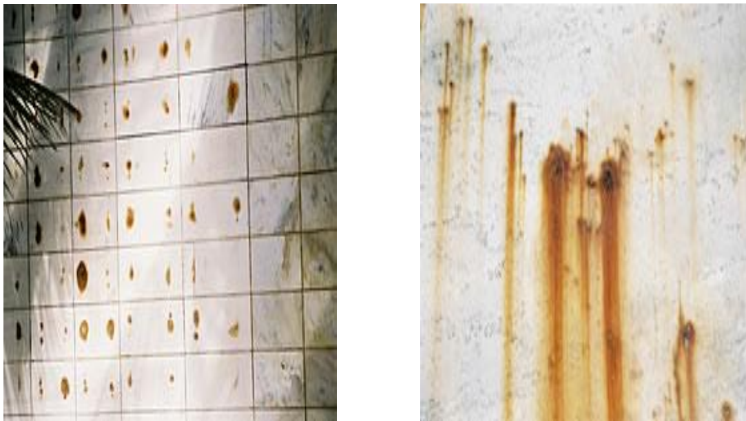
Foto 12 – Manchas de oxidação
