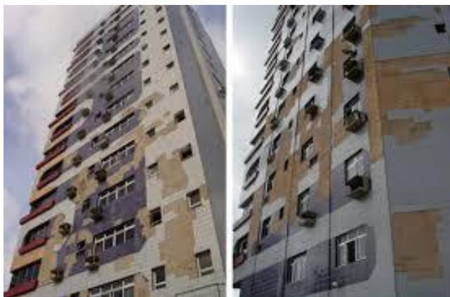
Foto 13 – Desplacamentos devido à falta de juntas
