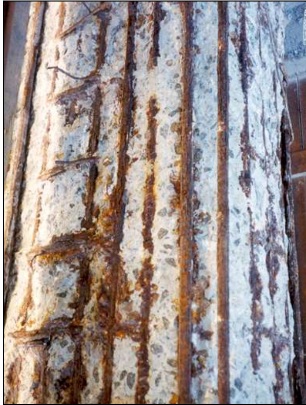
Figura 3.2 – Pilar sobre o mar após 10 anos de construção, deteriorado devido aos efeitos da interação da carbonatação com íons e cloreto
