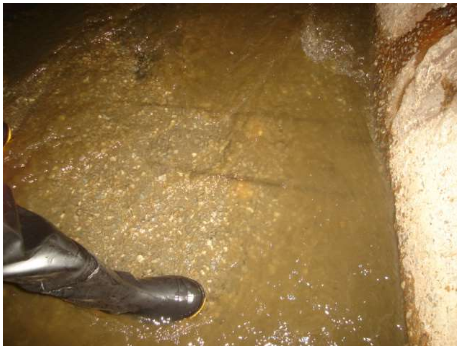
Figura 3.9 – Erosão em galeria de água pluvial (Fonte: RECUPERAÇÃO, 2010)
