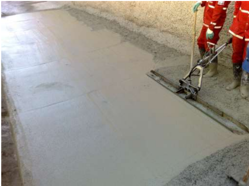
Figura 4.10 – Concretagem da laje de piso, utilização da régua “float” para melhorar o acabamento superficial (Fonte: ACERVO PESSOAL, 2009)
