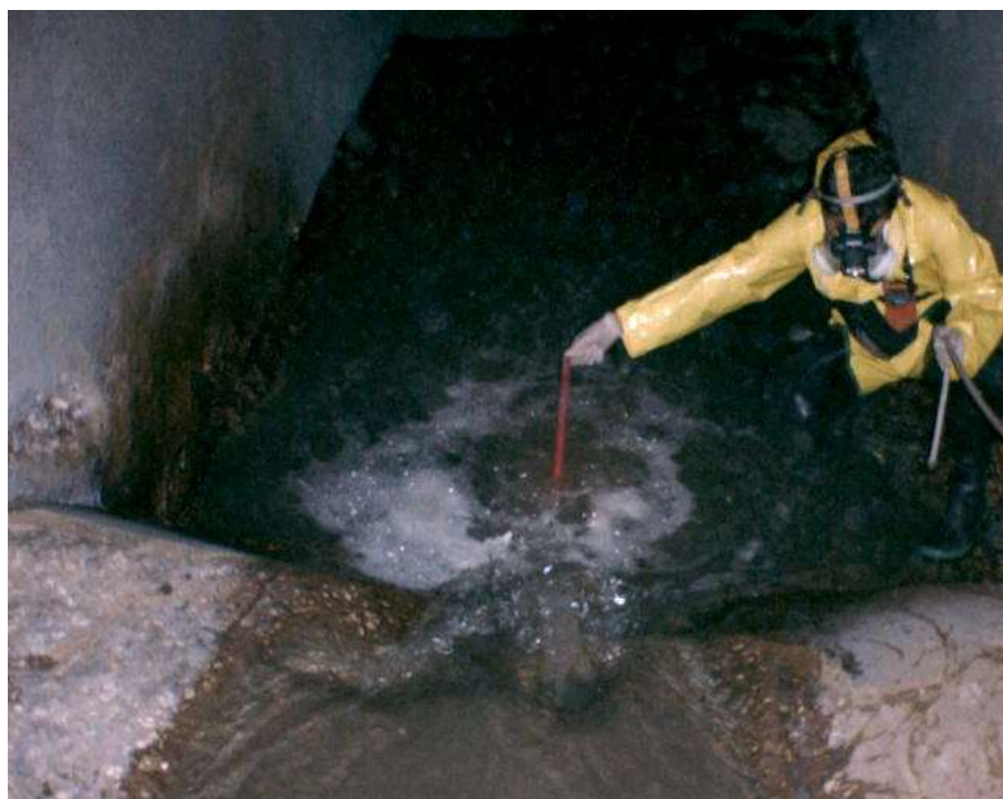
Figura 3.10 – Desgaste por cavitação (Fonte: RECUPERAÇÃO, 2010)
