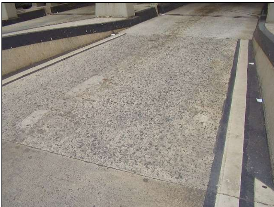
Figura 3.8 – Desgaste superficial por abrasão em pavimento de concreto (Fonte: RECUPERAÇÃO, 2010)
