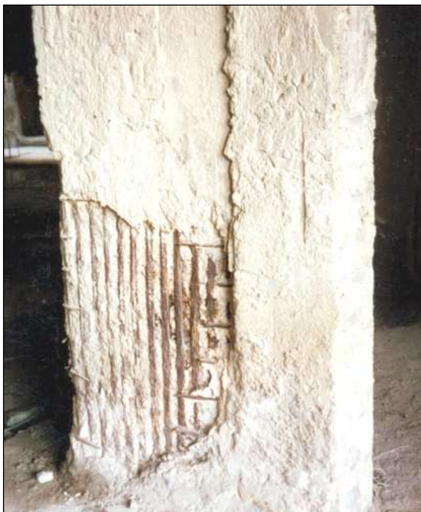
Figura 3.3 - Pilar em indústria com corrosão nas armaduras devido a carbonatação (Fonte: RECUPERAÇÃO, 2010)
