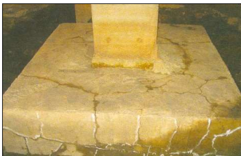
Figura 3.5 – Mapeamento de fissuras em blocos de fundação devido a reação álcali-agregado (Fonte: RECUPERAÇÃO, 2010)
