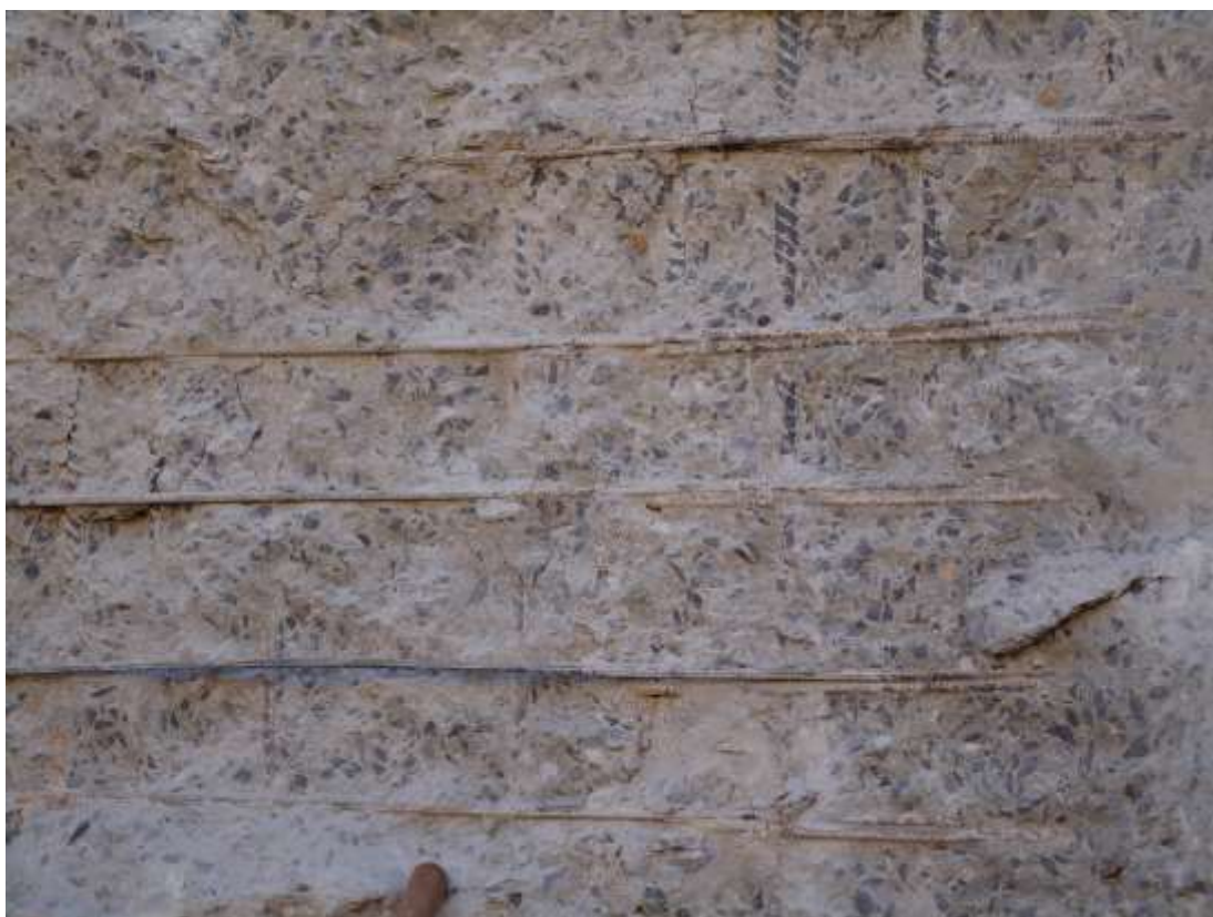
Figura 4.14 – Exposição da armadura e verificação do nível de perda de seção (Fonte: ACERVO PESSOAL, 2009)
