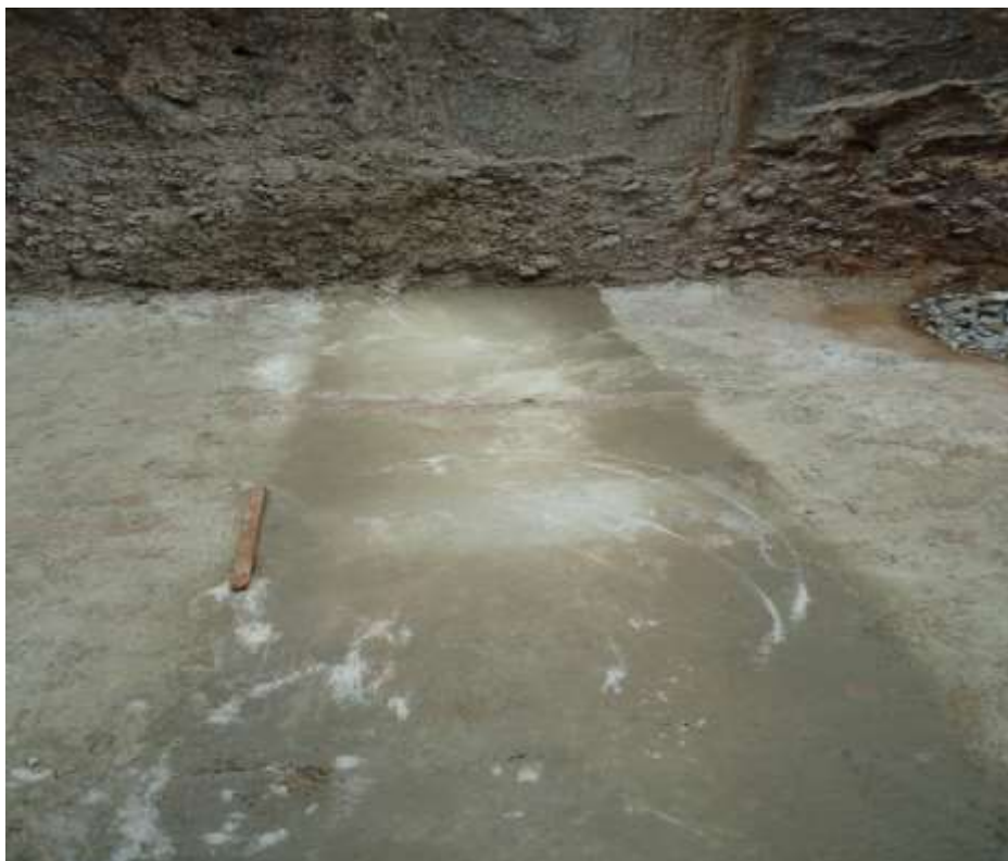
Figura 4.6 – Formação de junta seca entre o contato das duas faces da laje de piso, sem armadura, só argamassa (Fonte: ACERVO PESSOAL, 2009)
