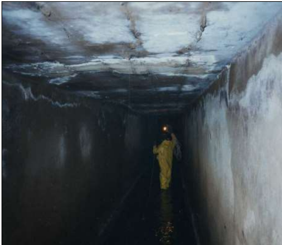
Figura 3.11 – Teto de galeria de águas pluviais contaminadas por esgotos apresenta manchas devido ao ataque biológico (Fonte: RECUPERAÇÃO, 2010)
