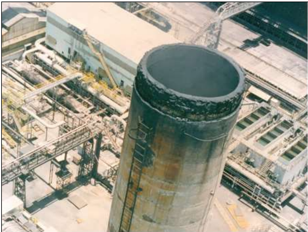
Figura 3.7 – Topo da chaminé de uma siderúrgica, deteriorada pela variação brusca de temperatura (Fonte: RECUPERAÇÃO, 2010)
