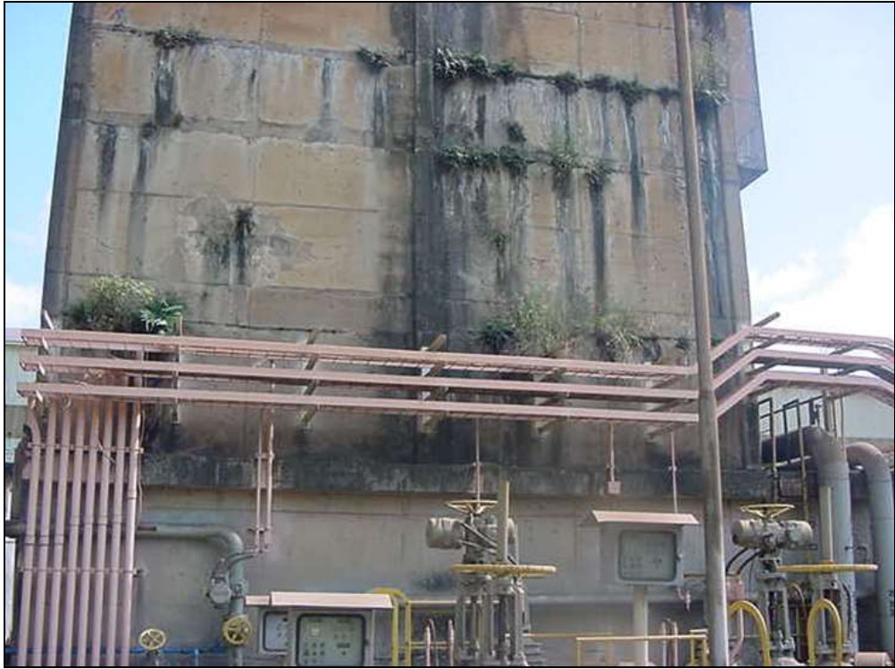
Figura 3.12 – Crescimento de raízes de plantas em fendas do concreto deterioraram a estrutura (Fonte: RECUPERAÇÃO, 2010)
