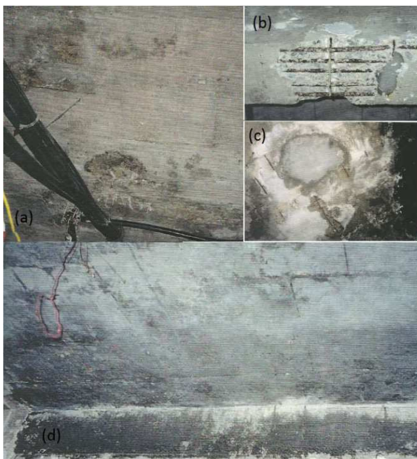
Figura 28- Prédio de Apoio em 2000 – (a) Infiltração e estalactites, (b) Armaduras corroídas, (c) Corrosão de armaduras, manchas e infiltração abaixo da cozinha, (d) Cobrimento quase nulo.
