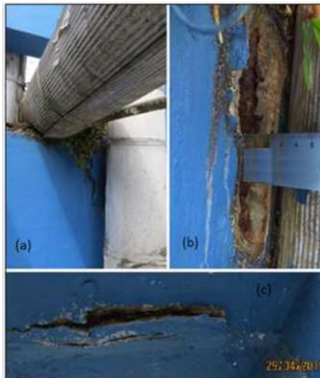
Figura 37- Manifestações patológicas nas vigas Vierendeel de dano muito grave: (a, b) armadura corroída abaixo da tubulação e (c) adjacente à junta de dilatação.
