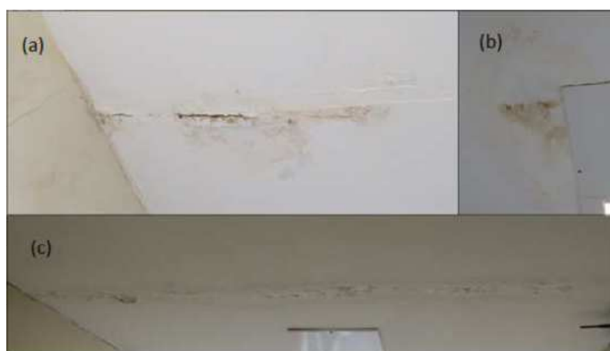
Figura 41- Manifestações patológicas nas lajes do prédio principal de dano médio: (a) fissura com mancha de corrosão, (b) mancha de corrosão e infiltração acentuada próximo à luminária, (c) infiltração com fissura e mancha de corrosão.
