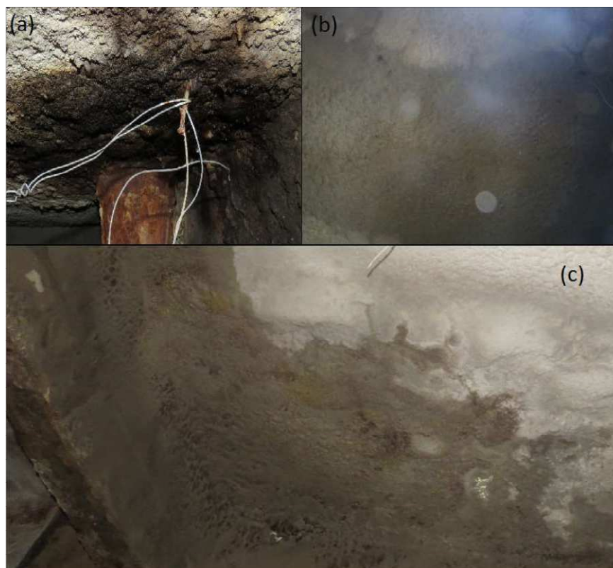
Figura 45- Manifestações patológicas nas lajes do prédio principal de dano muito grave: (a) detalhe de infiltração na passagem da tubulação, (b) infiltração generalizada com manchas de corrosão, (c) infiltração generalizada e viga com armadura exposta e corroída
