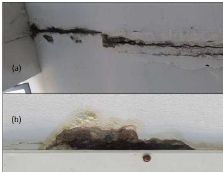
Figura 42- Manifestações patológicas nas lajes do prédio principal de dano grave: (a) armadura exposta adjacente à junta de dilatação e (b) à luminária.
