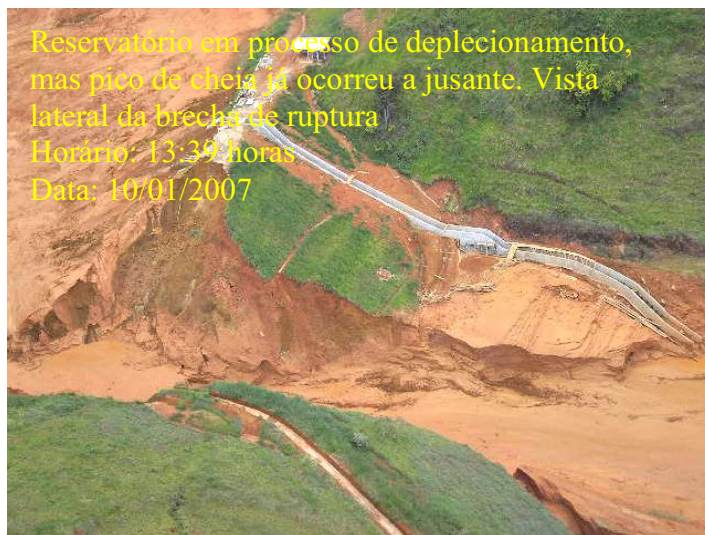
Figura 5.17 – Deplecionamento do reservatório e aspecto da brecha de ruptura
