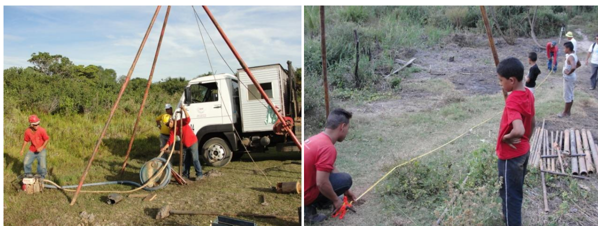
Figura 44 - Sondagem sendo realizada por empresa de Montes claros com acompanhamento da equipe da UFMG e moradores de Lagedo. Fotos: Delmo R. Vilela.
