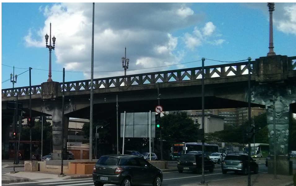
Figura 28 - Grafites em pilastras do Viaduto de Santa Tereza em 20 out. 2014.
