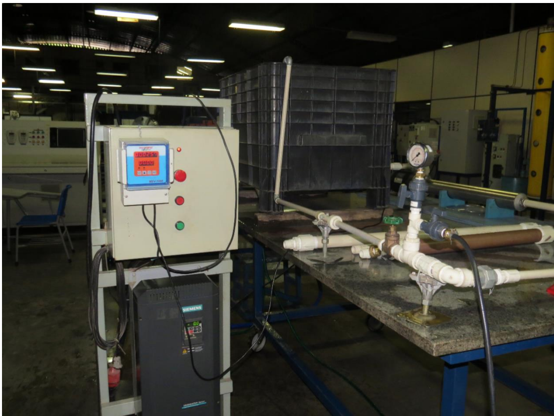
Figura 19 – Quadro de comando do conjunto moto bomba
