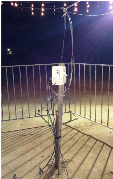
FIGURA 9 - Instalação para captação clandestina de energia elétrica Fonte: Arquivos de pesquisa.
