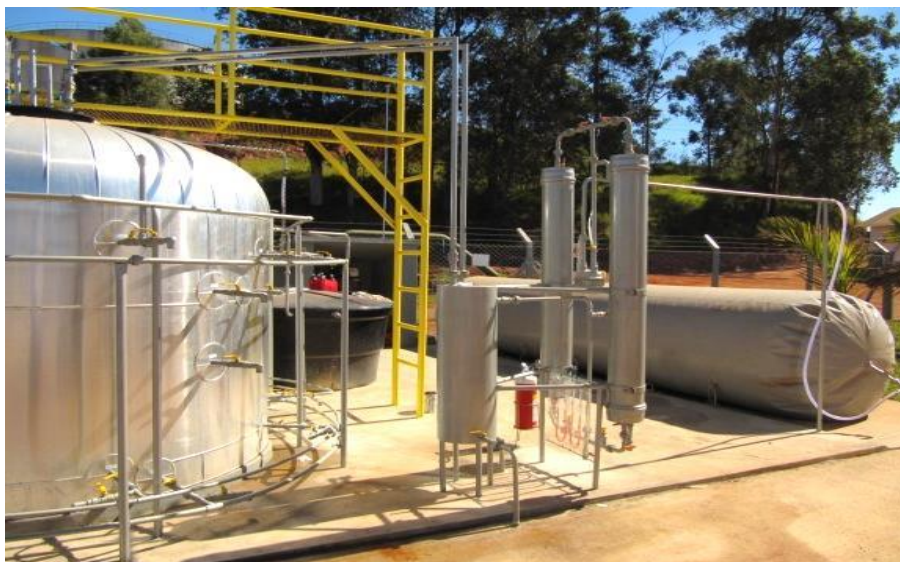
Figura 5.2 - Imagem do Sistema de Metanização da usina Monte Alegre
