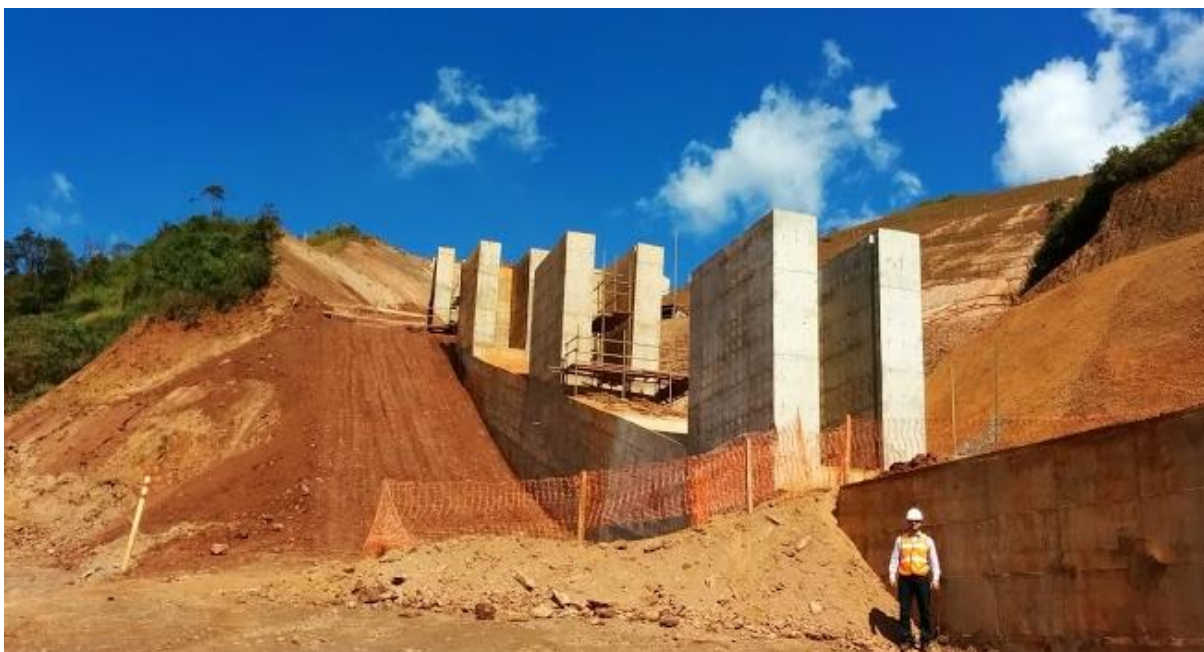
Figura 1.7 - Implantação do sistema extravasor operacional da barragem de rejeitos Forquilha IV - vertedouro tipo flauta de concreto armado.
