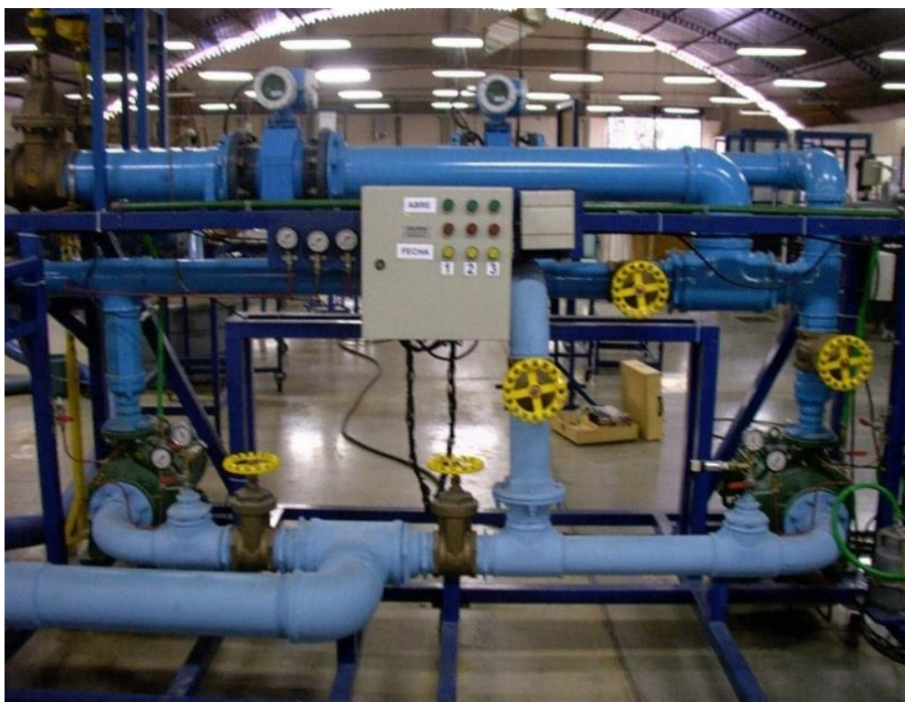
Figura 5.2 -Estação de bombeamento.
