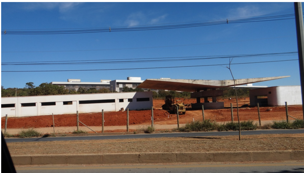
FOTO 16: Construção do CIAAR em andamento no município de Lagoa Santa , 2014. FONTE: França, B. L. P de O. Junho- 2014.
