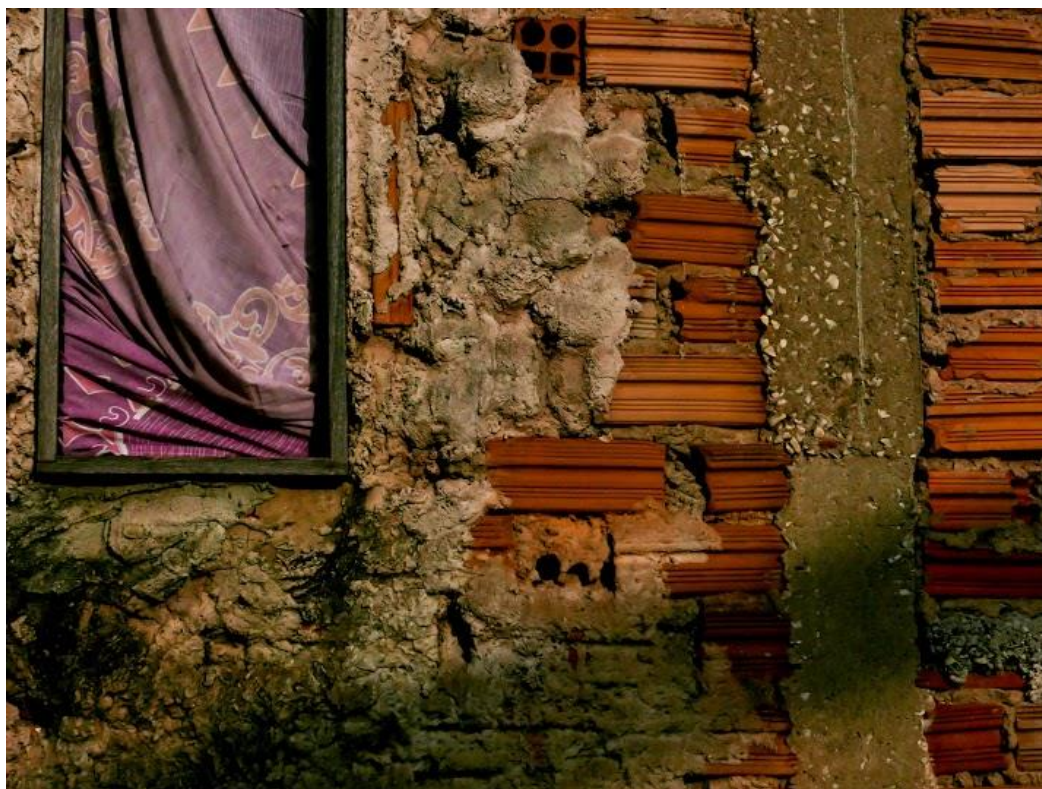
Figura 14 – Detalhe para a falta de acabamento das casas no Morro Santana
