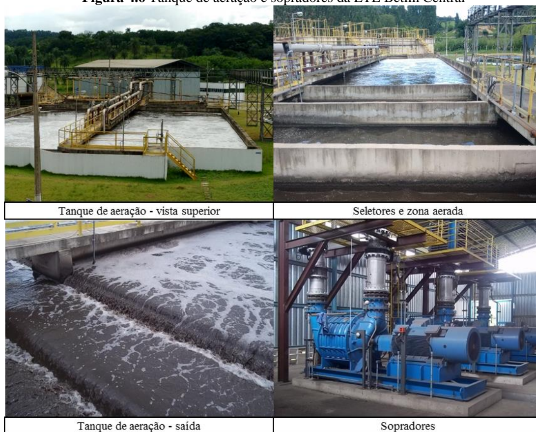
Figura 4.6 Tanque de aeração e sopradores da ETE Betim Central
