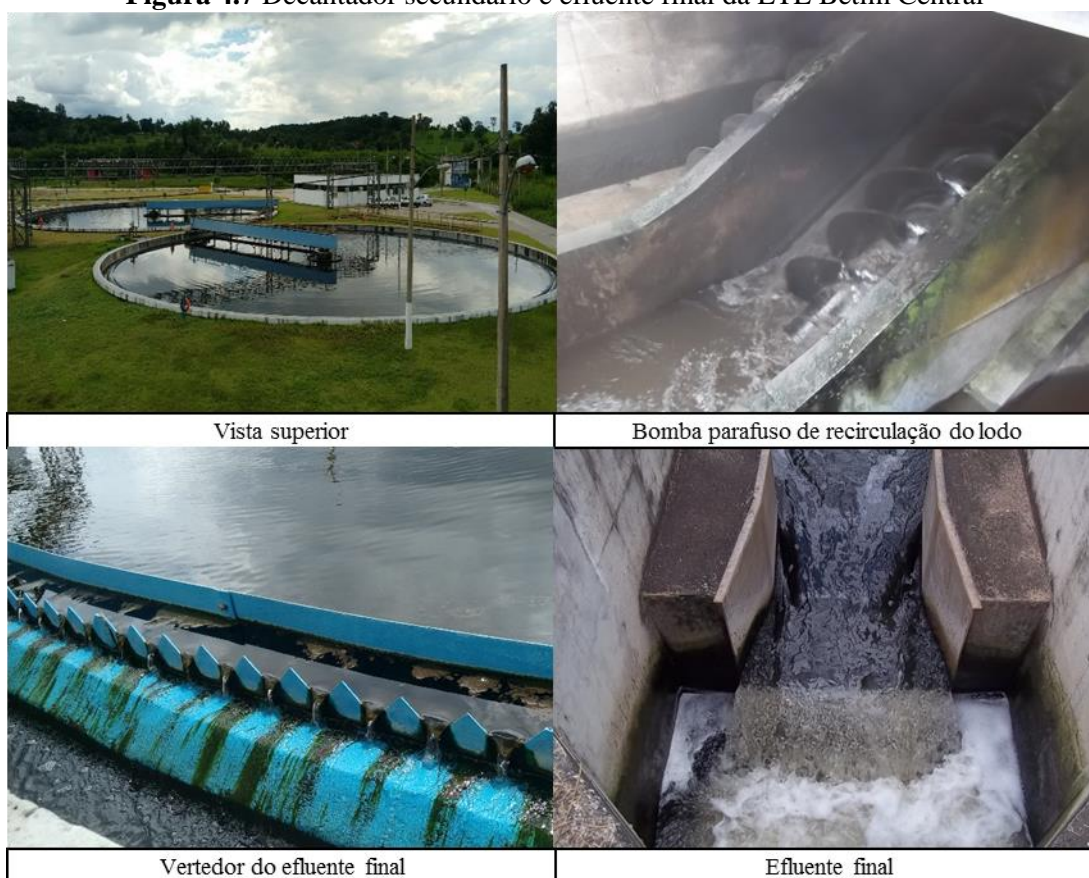
Figura 4.7 Decantador secundário e efluente final da ETE Betim Central
