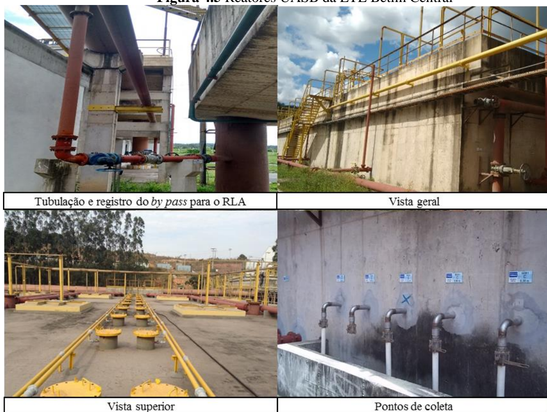
Figura 4.5 Reatores UASB da ETE Betim Central
