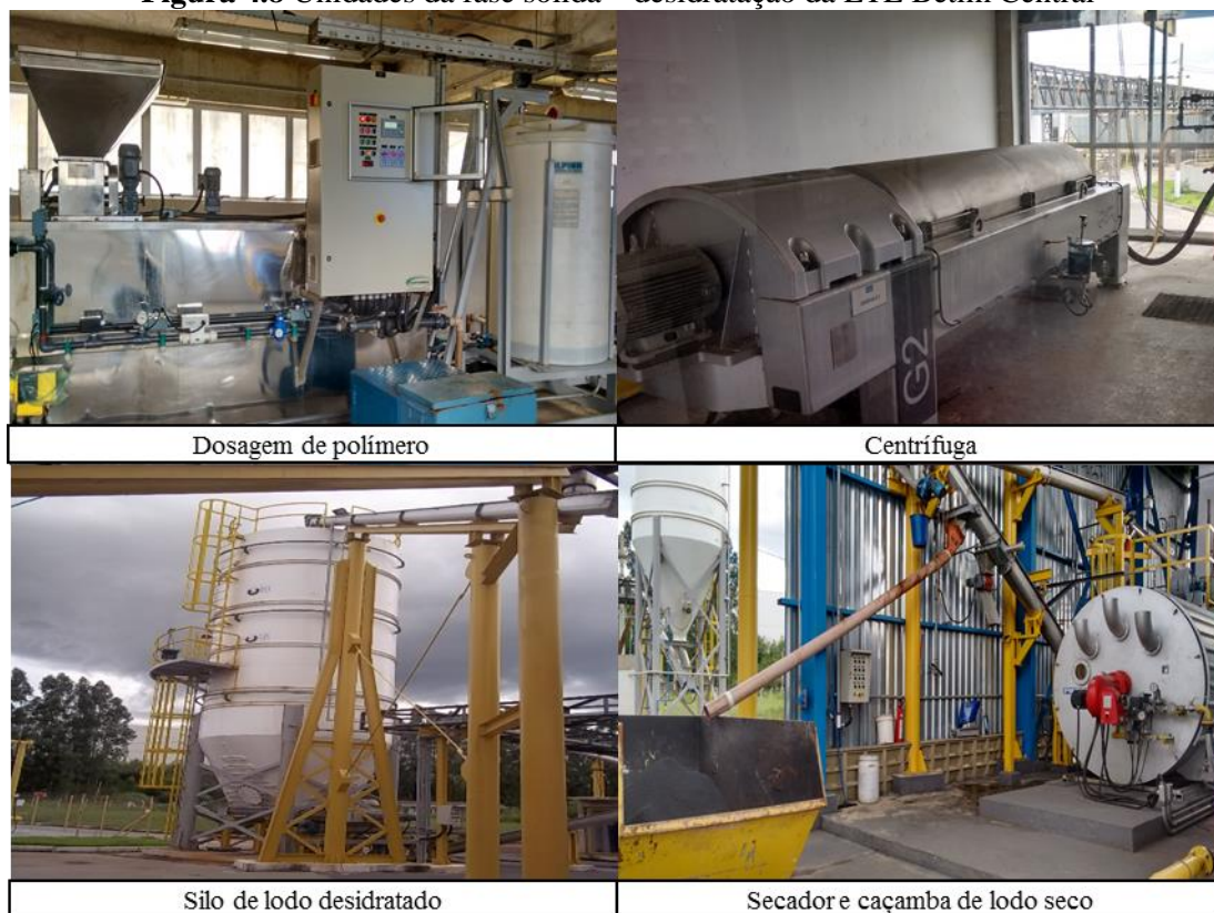
Figura 4.8 Unidades da fase sólida – desidratação da ETE Betim Central
