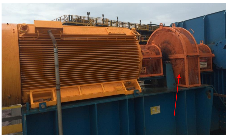
FIGURA 2.15 - Volante de inércia montado entre motor e redutor (Sandvik MGS S/A)
