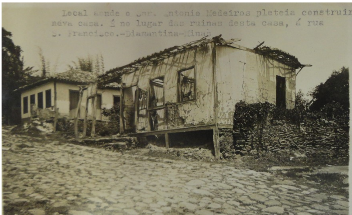
Figura 9: Propriedade de Antônio Medeiros. Solicitação de demolição de ruína (17-12-1946). In: CDI/IPHAN/MG. Diamantina. Pasta: Rua São Francisco (1946-1990); Caixa: 180.
