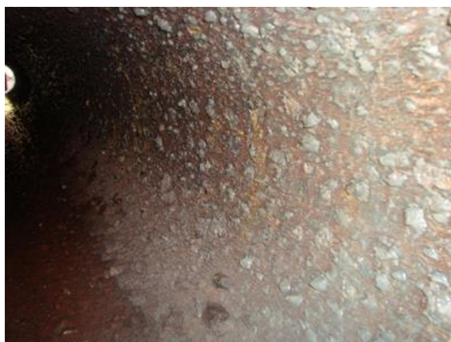
Figura 5. 107 - Tubérculos no interior da tubulação de descarga/recalque da EB2.
