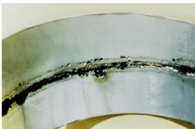
Figura 3. 14 - Corrosão em torno do cordão de solda com formação de pites e/ou alvéolos (GENTIL, 2003).
