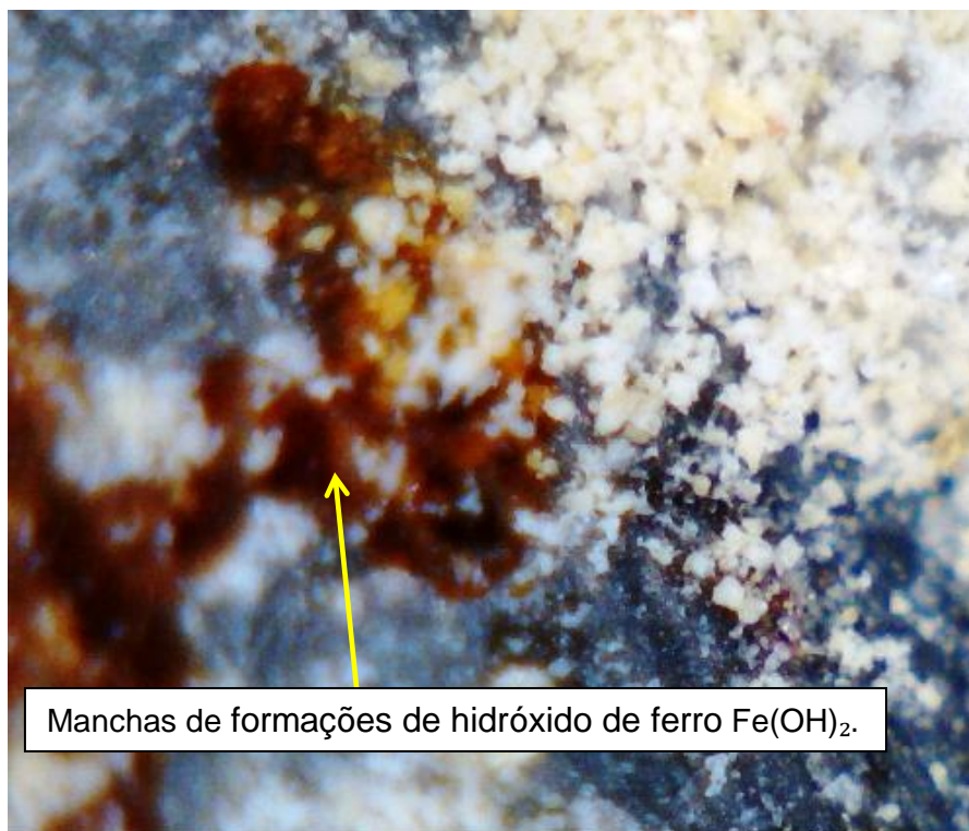
Figura 5.2.3.2.13 - Corpo de prova referência armado 5. Armadura já com processo de corrosão instalado. Ampliação 400X com lupa estereoscópica.
