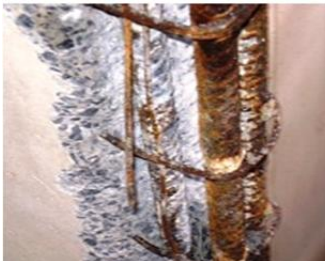
Figura 3.3.2 - Estrutura atacada por cloretos, apresentando alta concentração de armaduras e baixa espessura de recobrimento.
