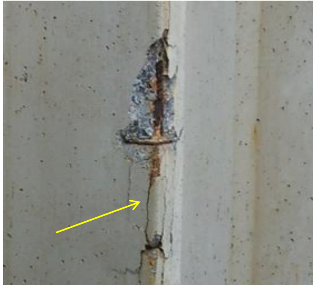
Figura 3.3.4 - Delaminação do concreto devido ao ataque por cloretos.
