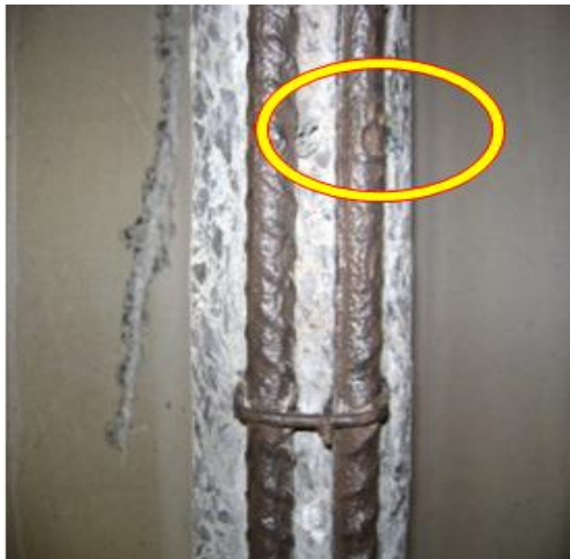
Figura 3.3.5 Corrosão do aço por pitting.
