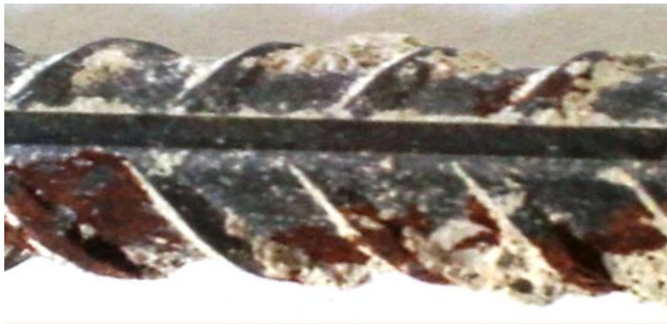
Figura- 5.2.3.3.18- Seção da armadura do corpo de prova referência armado 8 após 150 dias de ataque.
