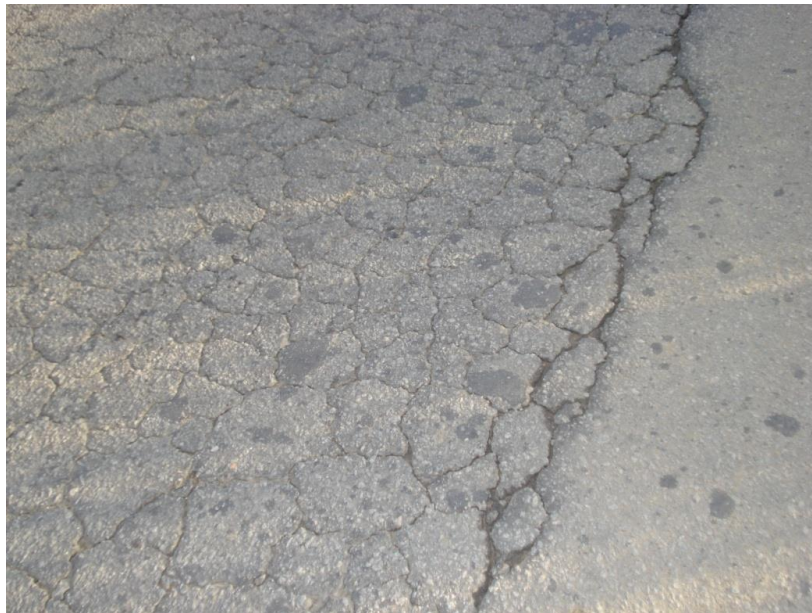
Figura 3 - Trincamento associado ao tráfego
