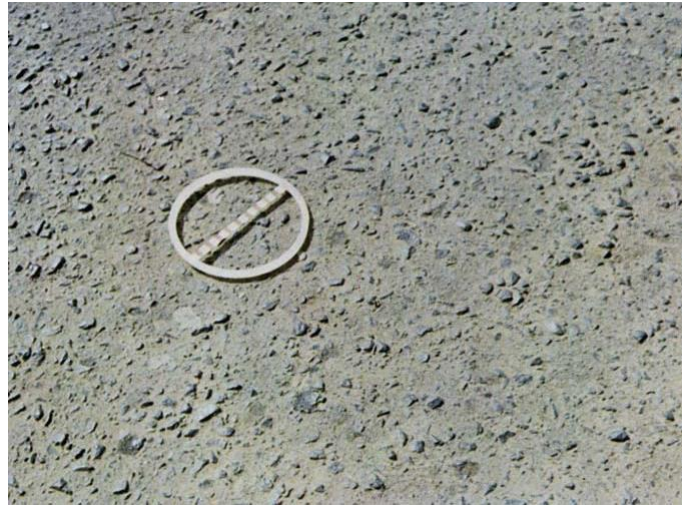
Figura 8 - Desgaste do pavimento
