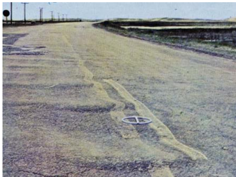
Figura 5 - Ondulação ou corrugação
