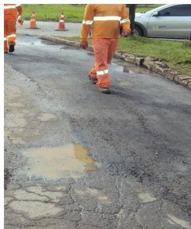
Figura 19 - Fissuras em pavimento asfáltico
