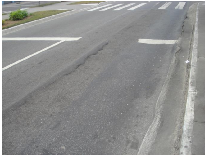
Figura 4 - Afundamento associado ao tráfego
