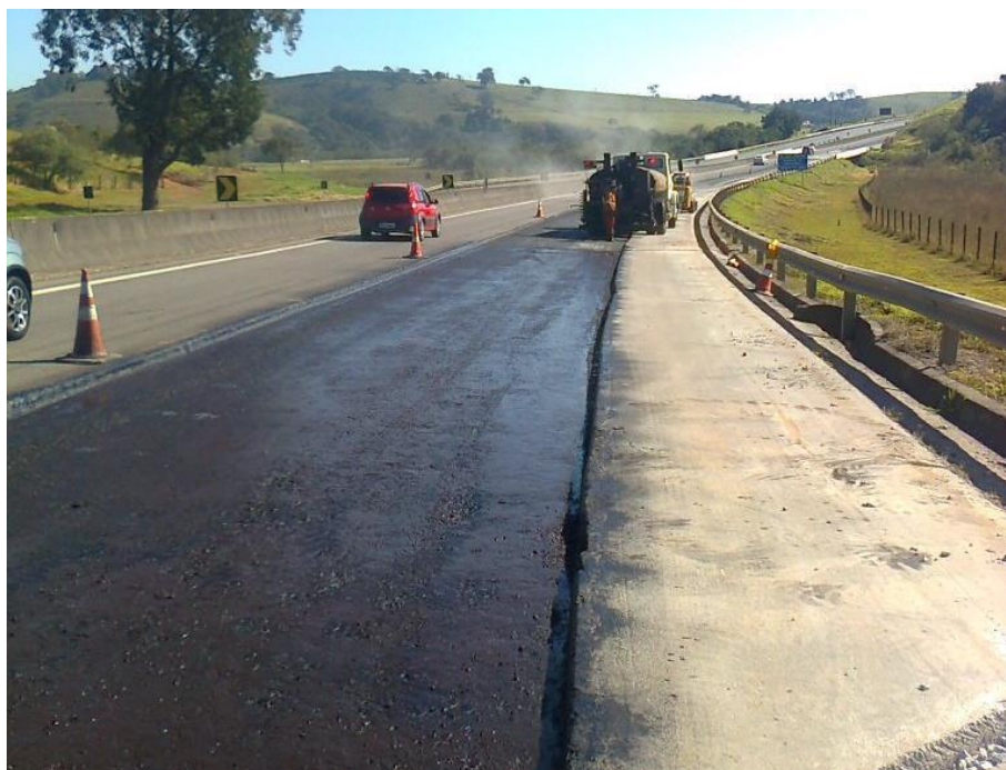
Figura 29 - Pintura de ligação - aplicação do ligante para receber a segunda camada de capeamento
