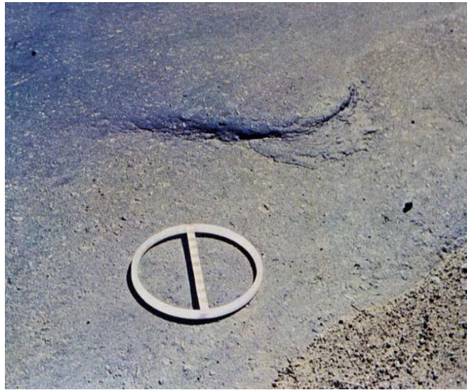
Figura 6 - Escorregamento do revestimento
