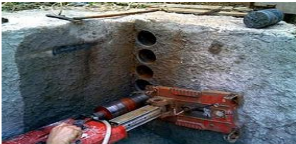
Figura 11 – Furos Em Concreto
