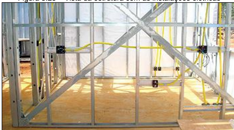
Figura 3.25 – Vista da estrutura com as instalações elétricas
