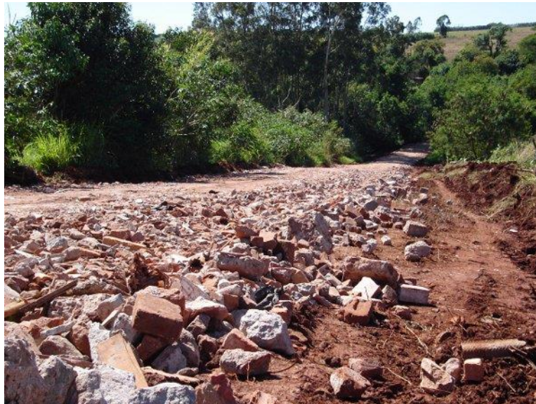
Figura 8 – Entulho utilizado em via sem concreto asfáltico.
