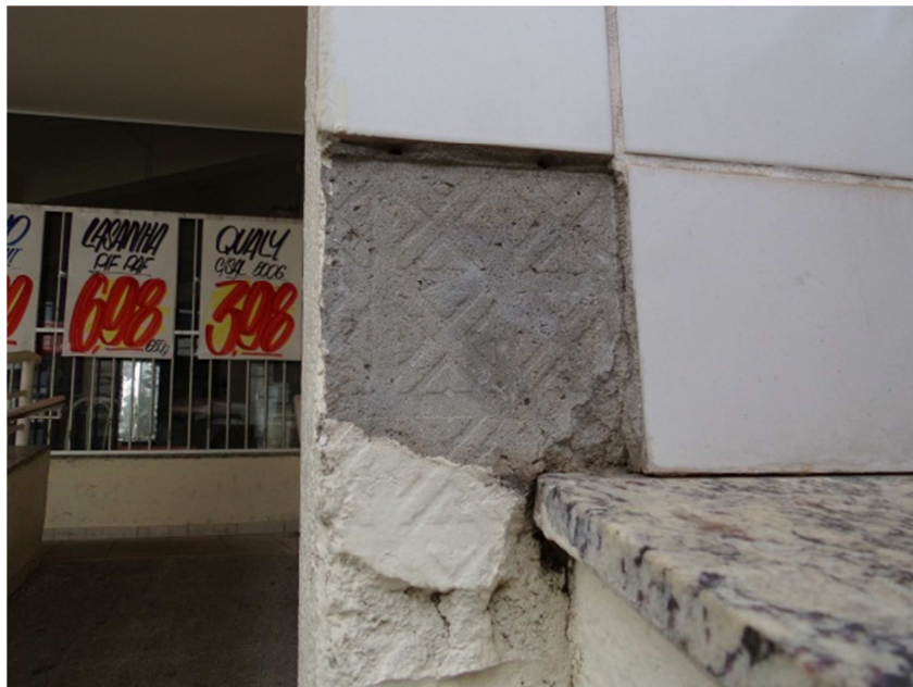
Figura 2.5: Descolamento de Placa do Edifício B
