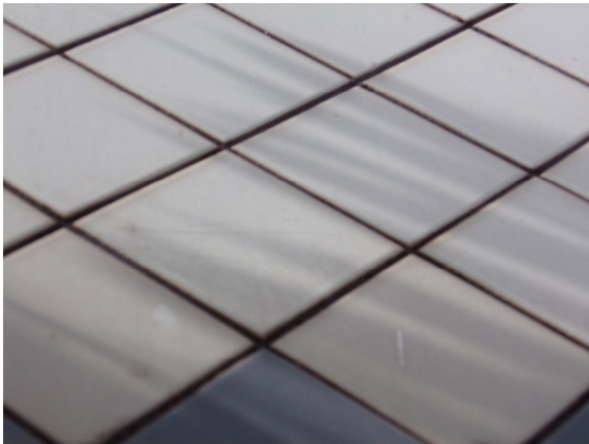
Figura 3.2: Juntas Sem a Presença de Rejunte no Edifício C.
