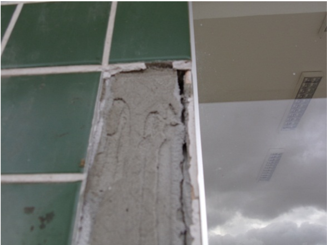
Figura 1.1: Destacamento no Edifício A
