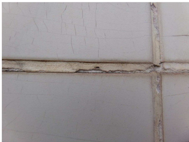
Figura 2.1: Falha no Rejunte e Gretamento nas Placas no Edifício B
