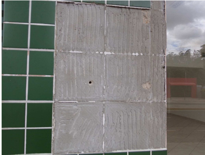
Figura 1.4: Descolamento Edifício A
