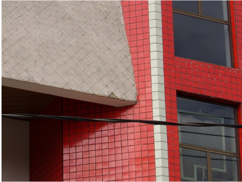
Figura 3.1: Descolamento no Edifício C.
