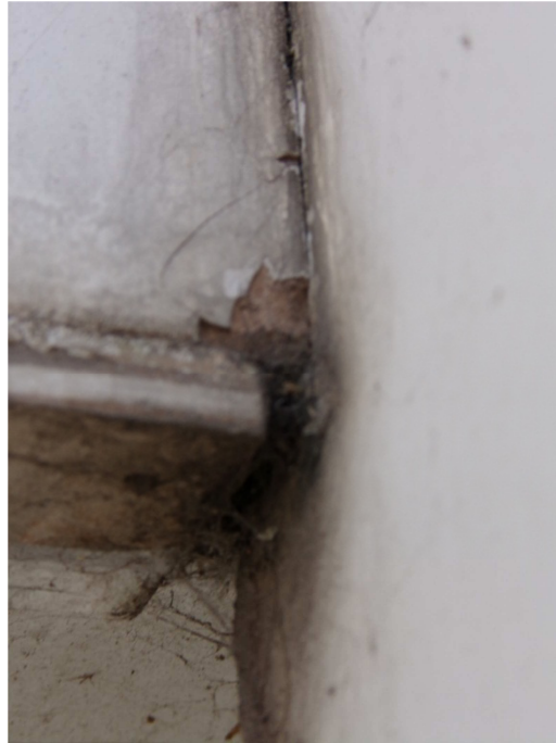
Figura 2.4: Falha na Superfície de uma Placa do Edifício B
