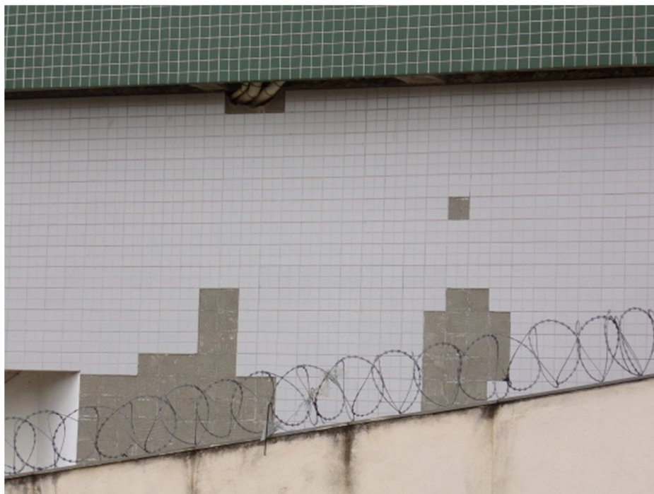
Figura 1.3: Descolamento do Tipo Mapa no Edifício A
