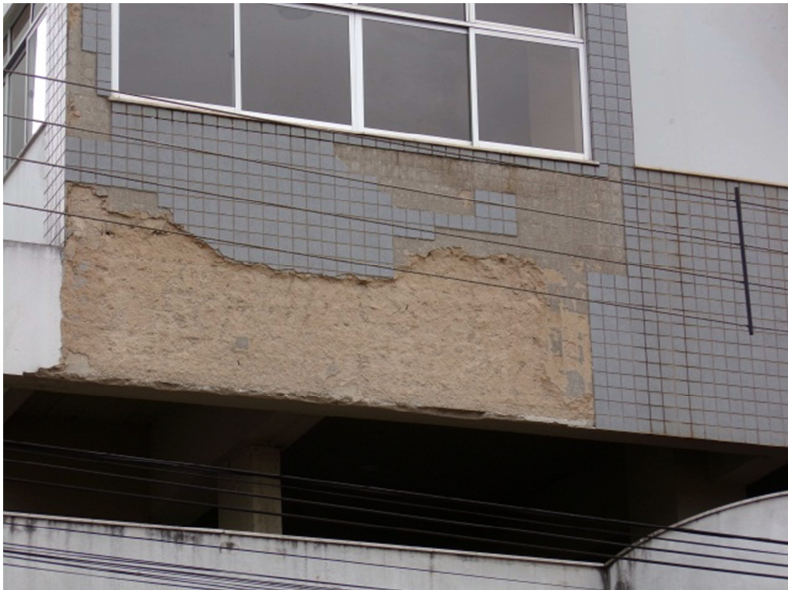
Figura 4.1: Pulverulência e descolamento no edifício D.
