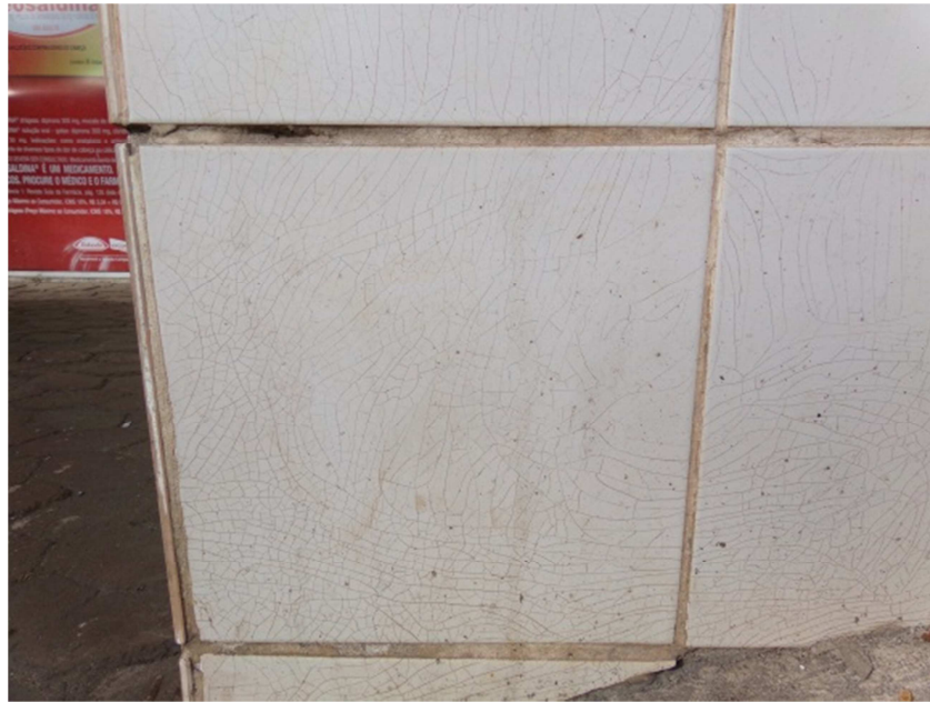
Figura 2.2: Falha nas Juntas e Gretamento nas Placas no Edifício B
