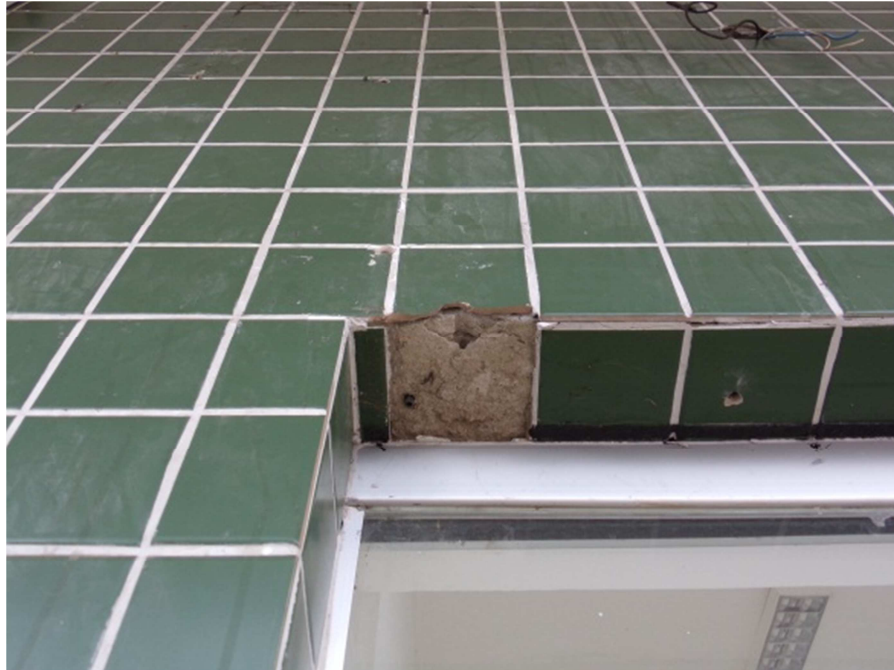
Figura 1.2: Pulverulência no Edifício A
