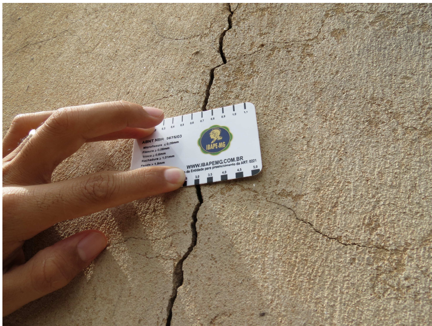
Figura 4.17: Fenda de 3mm na elevação lateral direita do 1º pavimento.
