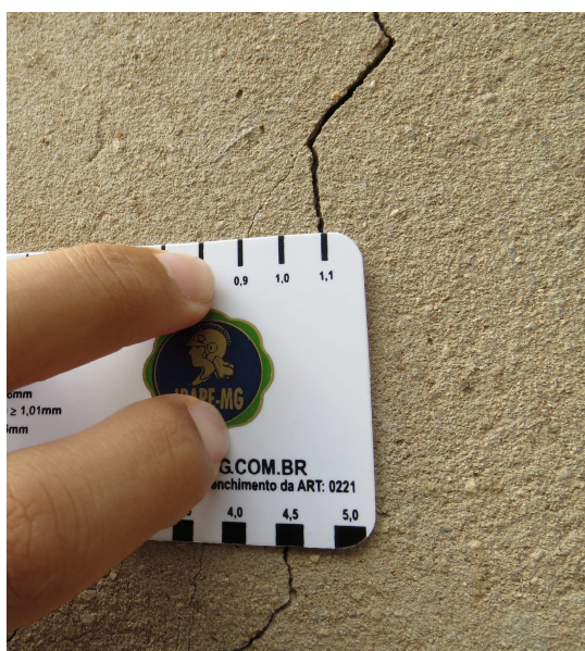
Figura 4.13: Trinca de 1,1mm na elevação lateral esquerda do 2º pavimento.
