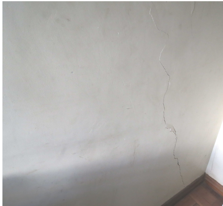
Figura 4.7: Trinca no quarto da área de serviço no 2º pavimento.
