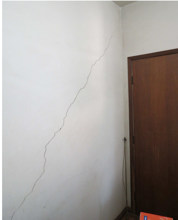
Figura 4.5: Rachadura no quarto da área de serviço no 2º pavimento.
