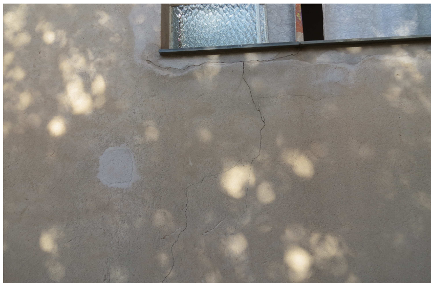
Figura 4.12: Trinca na elevação lateral esquerda do 2º pavimento.
