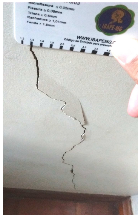
Figura 4.8: Trinca de 1,4mm no quarto da área de serviço no 2º pavimento.
