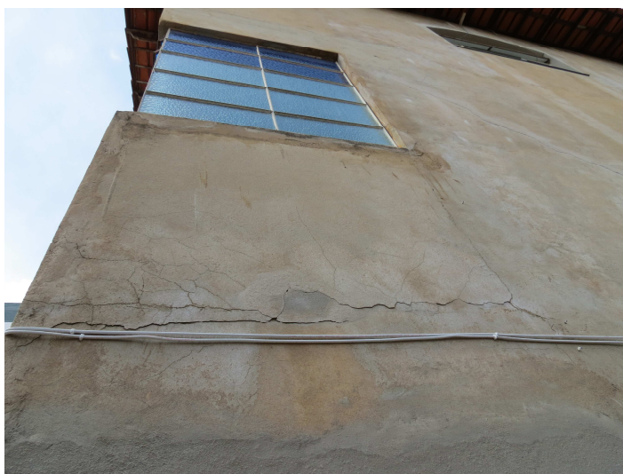
Figura 4.18: Parede degradada na elevação lateral esquerda entre o 1º e o 2º pavimento.
