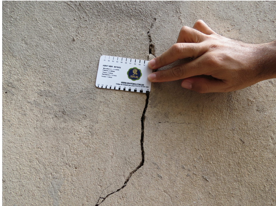
Figura 4.16: Fenda de 5mm na elevação lateral direita do 1º pavimento.
