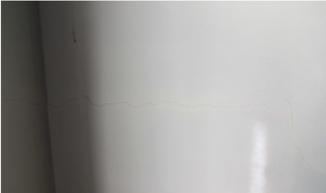
Figura 4.10: Fissura no quarto do 3º pavimento.
