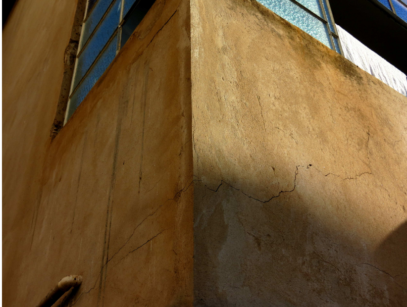
Figura 4.14: Trinca na elevação lateral direita do 2º pavimento.
