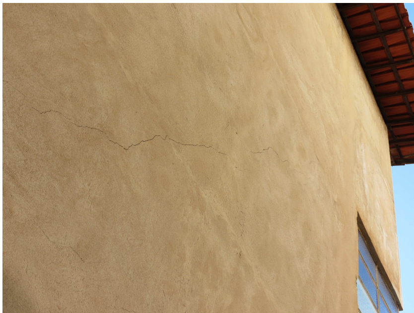
Figura 4.15: Trinca na elevação lateral direita do 2º pavimento.
