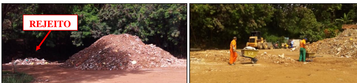
Figura 5.37 – Triagem e separação manual dos contaminantes na CTRS BR-040
