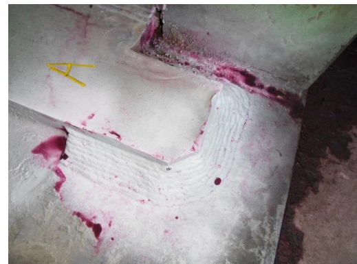
Figura 4.8: Descontinuidade R4 – d6
