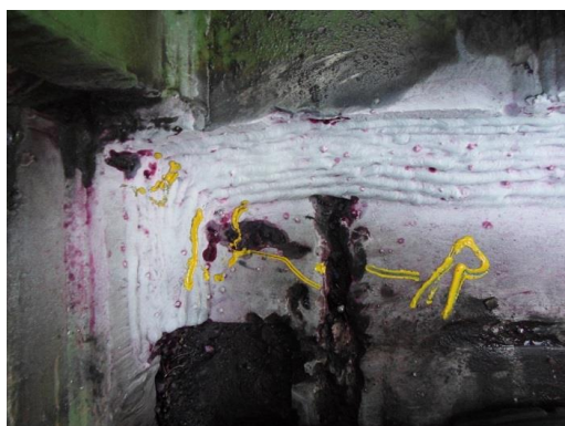
Figura 4.11: Descontinuidade R5 – d11.
