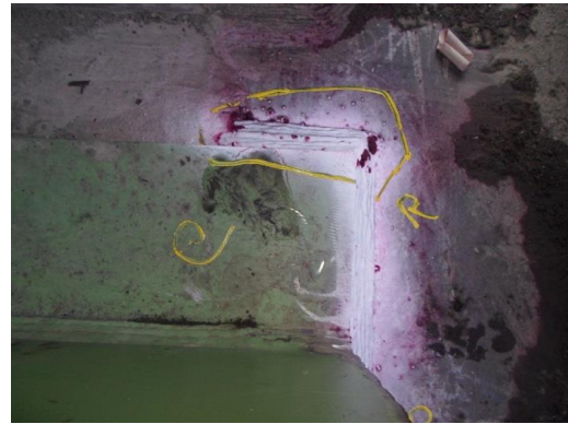
Figura 4.6: Descontinuidade R2 – d4
