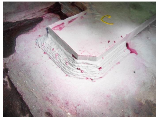
Figura 4.9: Descontinuidade R4 – d7.
