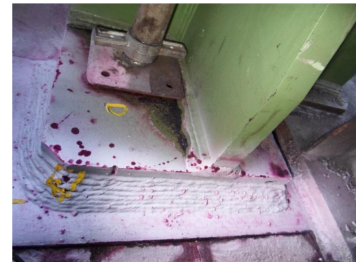
Figura 4.10: Descontinuidade R4 – d8
