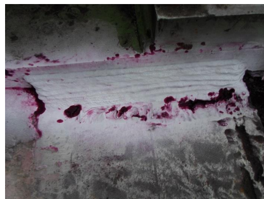
Figura 4.4: Descontinuidade R2 – d2.
