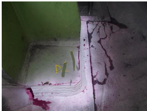
Figura 4.7: Descontinuidade R3 – d5.
