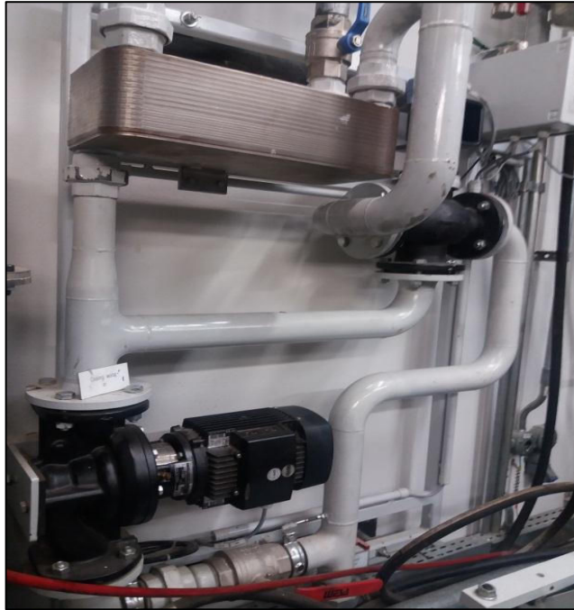
FIGURA 3.4 - Sistema de condicionamento de água
