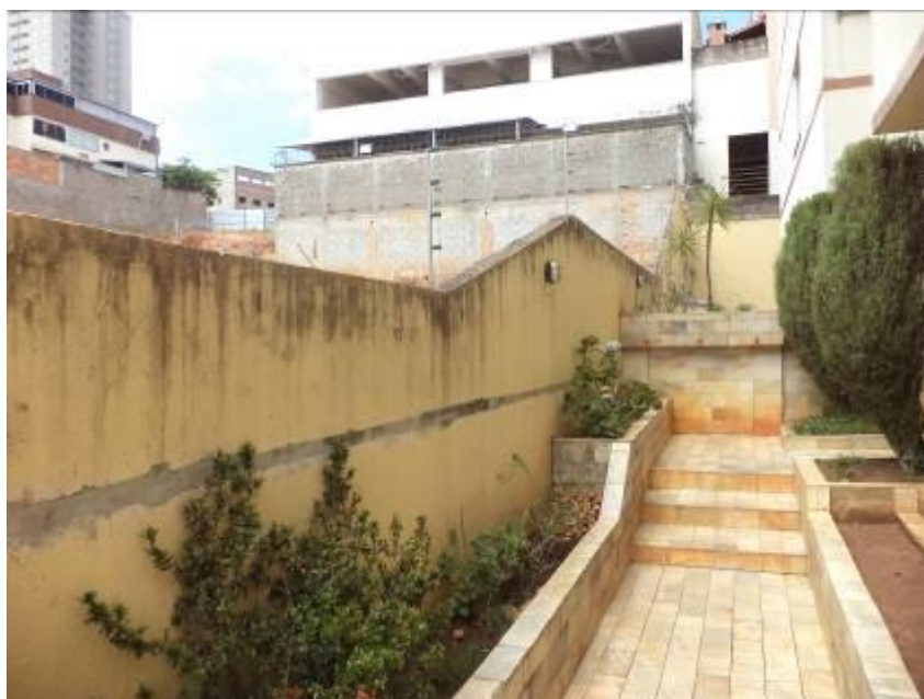
Figura 19: Vista do muro de divisa do imóvel 1 com o terreno da obra na parte intermediária – presença de trincas.
