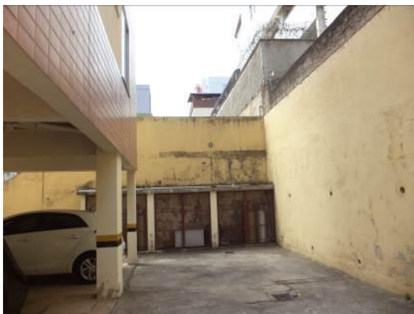
Figura 27: Vista do depósito de gás e dos danos no revestimento do muro de divisa ao fundo.
