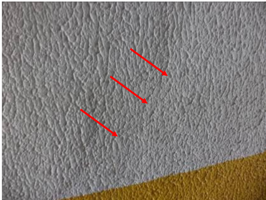
Figura 36: Vista aproximada das fissuras na parede da garagem.
