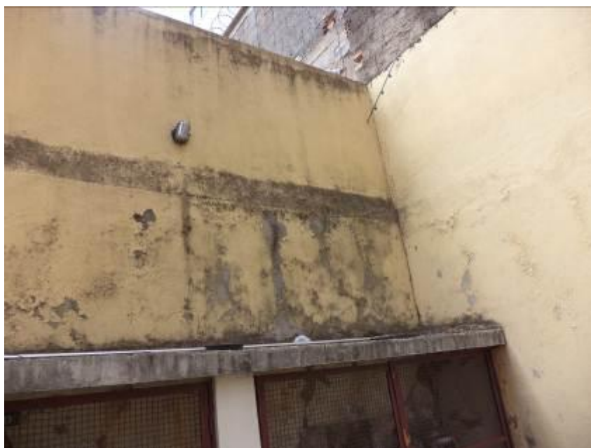
Figura 26: Vista de danos diversos no revestimento do muro, acima do depósito de gás.
