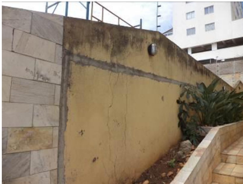
Figura 17: Vista aproximada das rachaduras.
