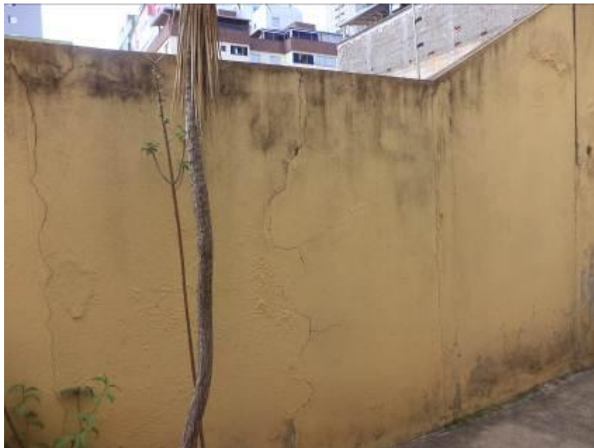
Figura 23: Vista aproximada das trincas.
