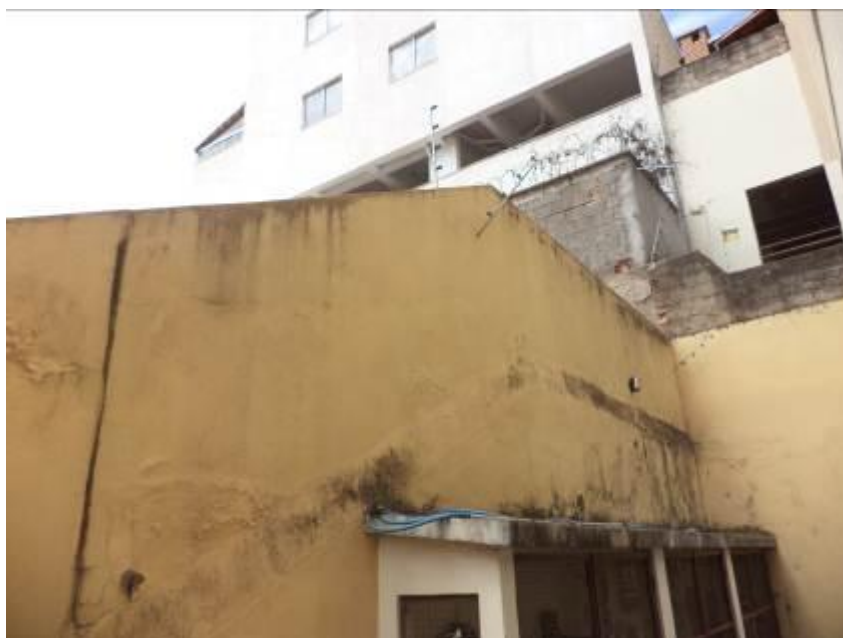
Figura 24: Vista do muro de divisa do imóvel 1 com o terreno da obra na parte de fundos – presença de depósito de gás junto ao muro.
