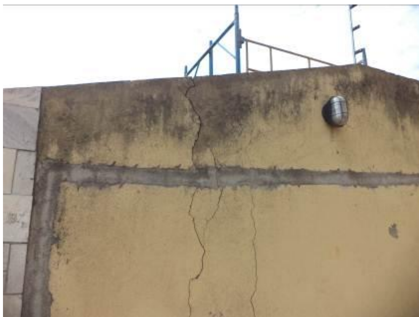
Figura 18: Vista aproximada das rachaduras.
