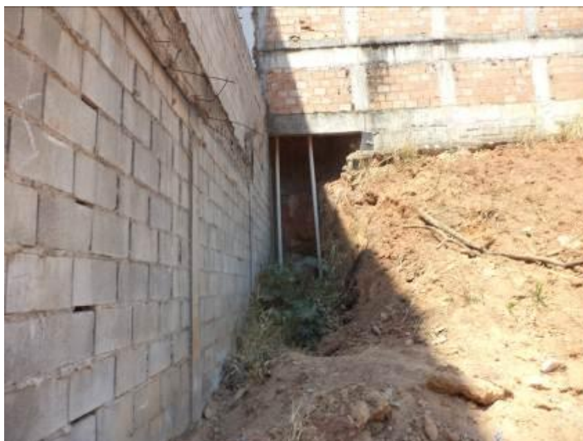
Figura 13: Vista aproximada da divisa do terreno da obra com o imóvel 3, águas pluviais do imóvel vizinho passando no terreno da obra.
