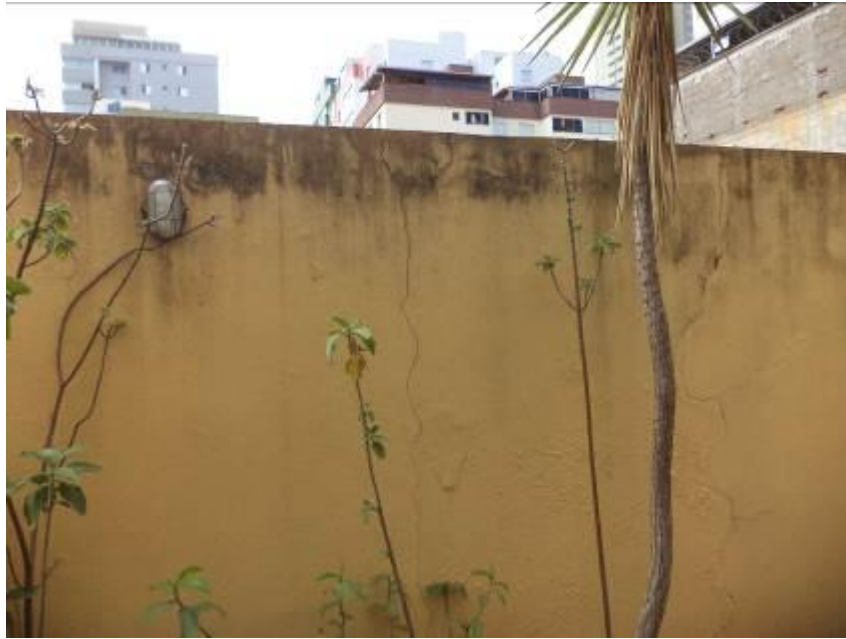
Fotografia 22: Vista aproximada das trincas.
