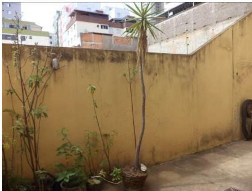
Figura 21: Vista do muro de divisa do imóvel 1 com o terreno da obra na parte de fundos – presença de trincas.
