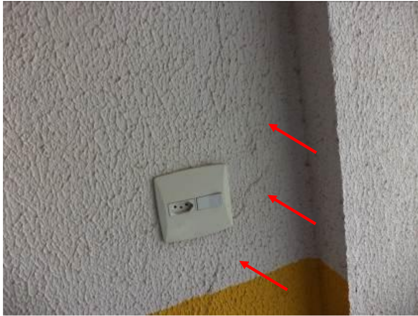
Figura 35: Vista aproximada das fissuras na parede da garagem.
