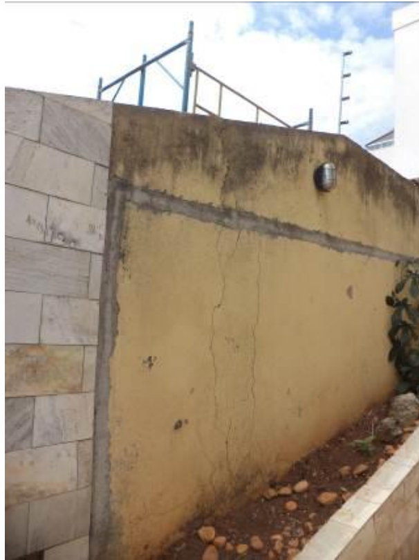
Figura 16: Vista do muro de divisa do imóvel 1 com o terreno da obra na parte frontal – presença de rachaduras.
