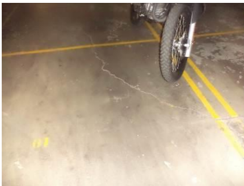
Figura 32: Vista do piso da garagem próximo à divisa – presença de rachaduras que se prolongam na parede de divisa com a obra.
