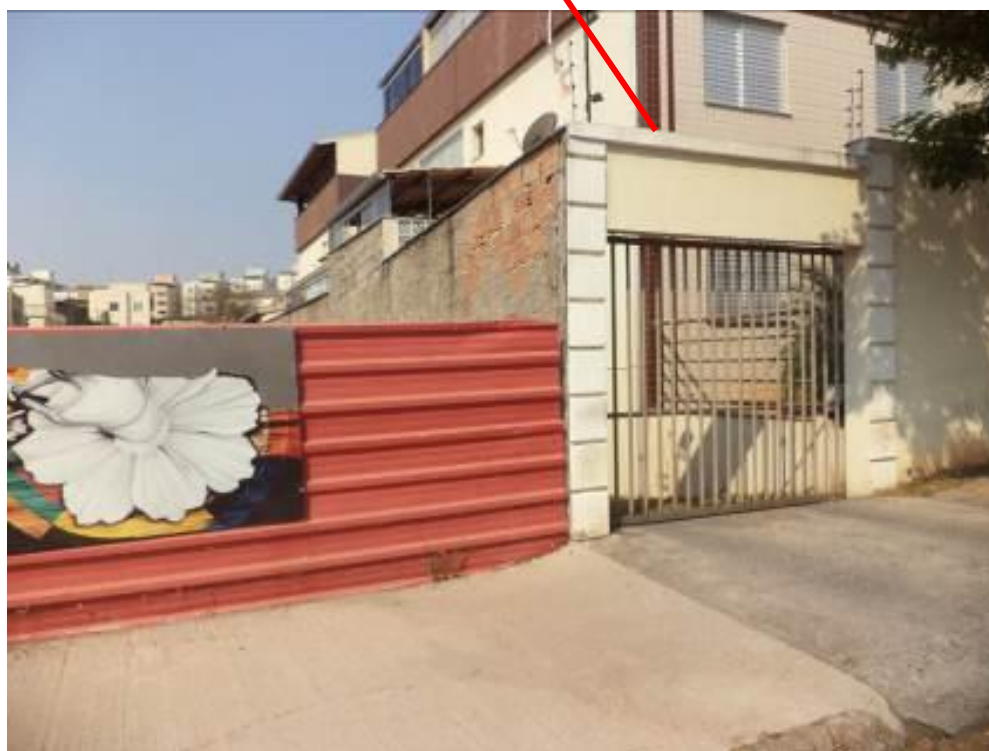
Figura 45: Vista da frente do imóvel 3 junto à divisa com o terreno da obra.
