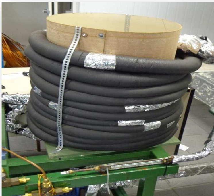
Figura 3.10 – Condensador do circuito principal.
