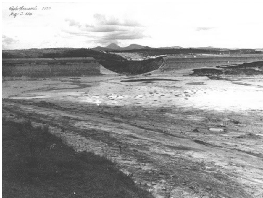
Figura 5.19 – Ruptura do maciço da barragem da Pampulha – detalhe da brecha de ruptura: vista frontal de montante para jusante.
