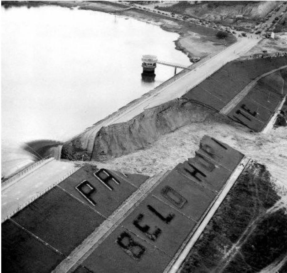
Figura 5.18 – Ruptura do maciço da barragem da Pampulha – detalhe da brecha de ruptura: vista lateral.
