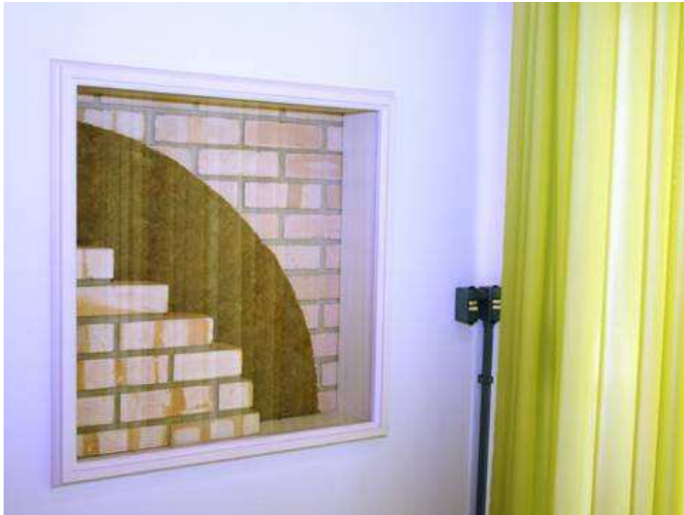
Figura 23 - Visor localizado na parede da sala de jantar - Camadas constituintes da parede externa - tijolo maciço + lã de rocha + tijolo maciço.
