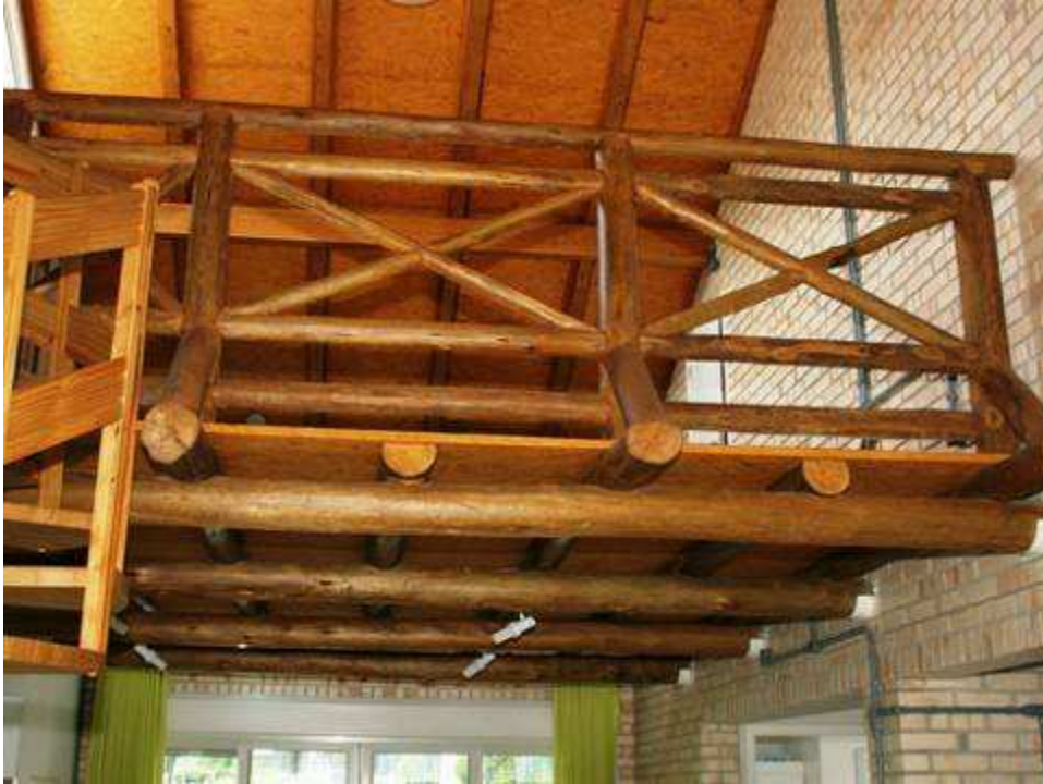
Figura 31 - Detalhe dos materiais construtivos utilizados na Casa Eficiente- Fôrro em madeira de pinus e eucalipto autoclavado.
