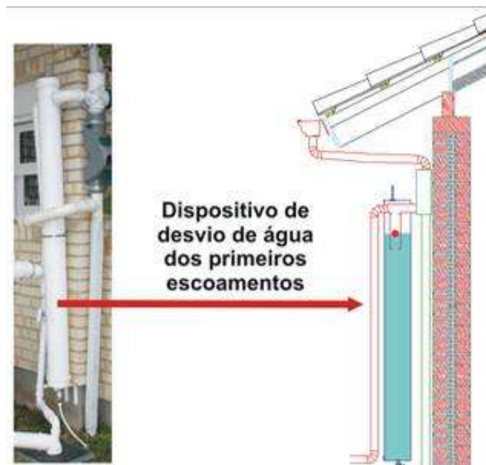
Figura 33 - Dispositivo de descarte de água das primeiras chuvas, fabricado com tubos e conexões de PVC.
