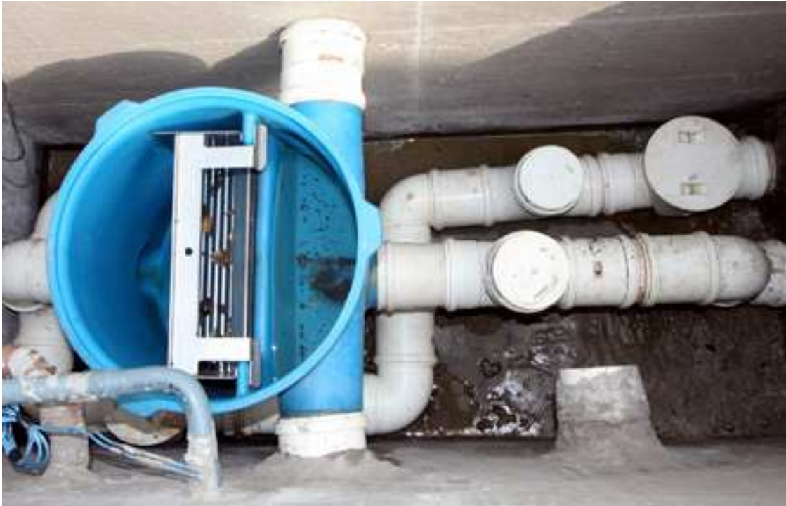
Figura 34 - Dispositivo de Descarte de sólidos instalado do interior da cisterna.
