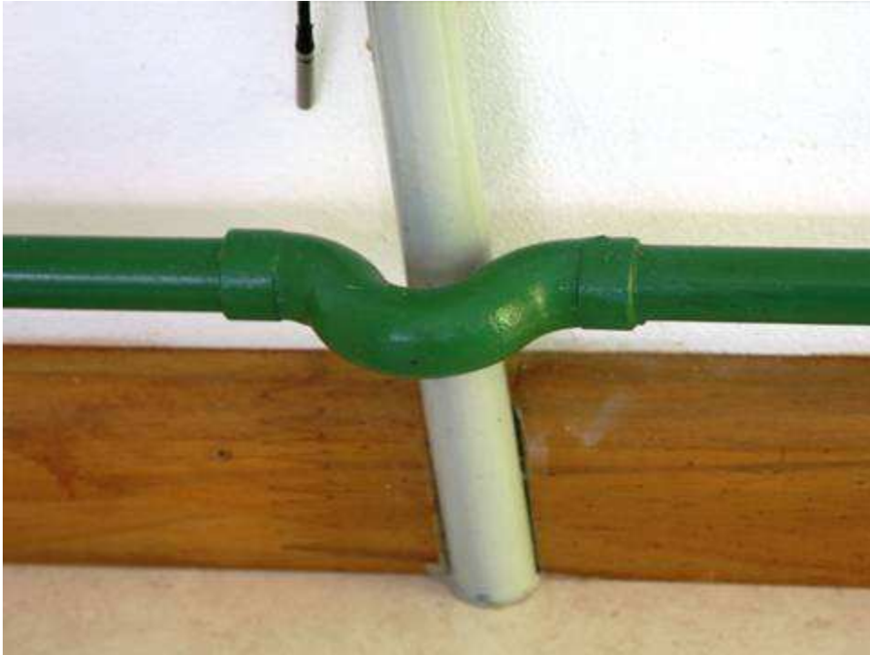
Figura 28 - Tubulação de cobre presa ao rodapé do quarto de solteiro.
