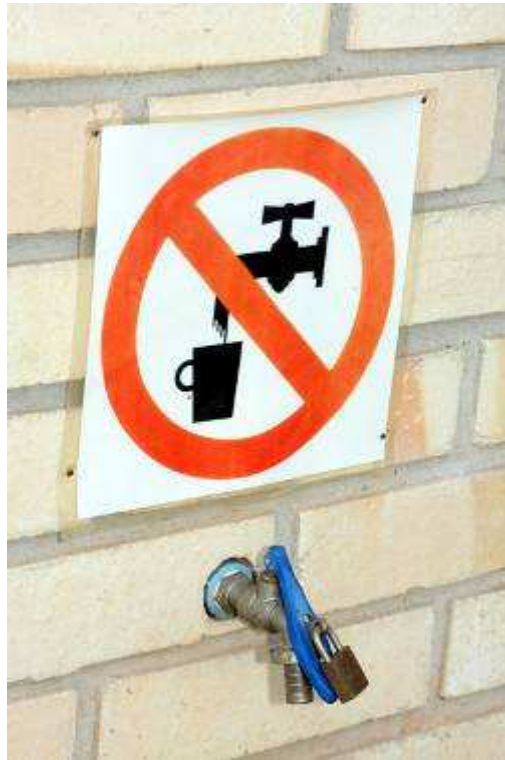
Figura 37 - Torneira externa com acionamento restrito, destinada à irrigação e abastecida com água de reúso.
