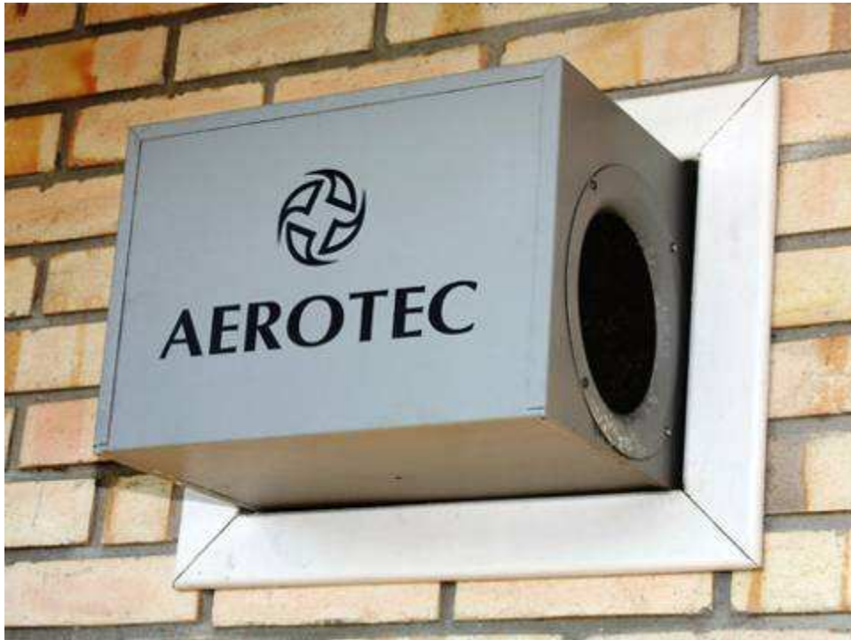
Figura 27 - Insuflador instalado no quarto de solteiro.
