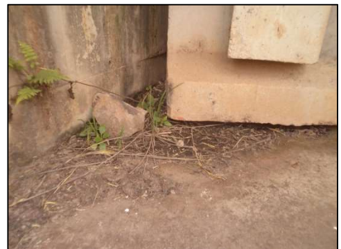
(f) Detritos e umidade no apoio de uma longarina no encontro.
