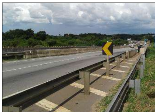
(c) Estreitamento de pista na ponte.
