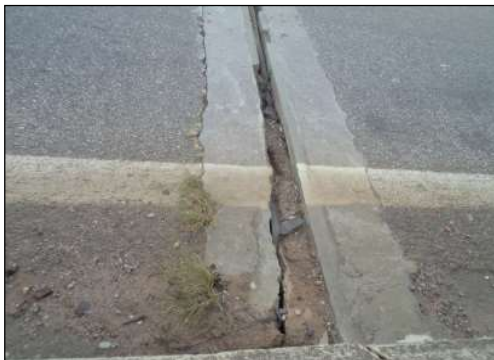
(g) Junta deteriorada e acúmulo de detritos e vegetação no local.
