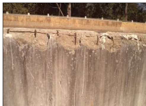
(f) Concreto desagregado e armadura exposta na barreira New Jersey
