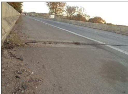
(e) Detalhe do desnível existente na junta de dilatação.
