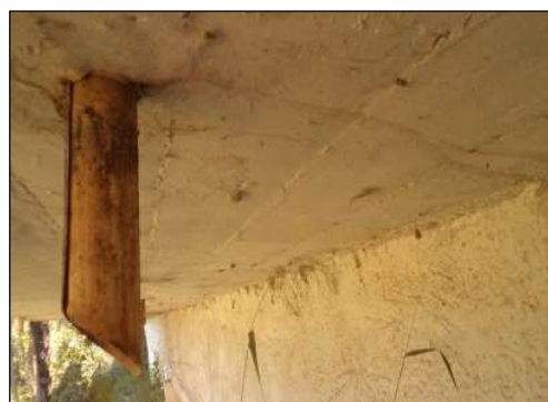
(h) Dreno danificado, permitindo a percolação de água pela laje.
