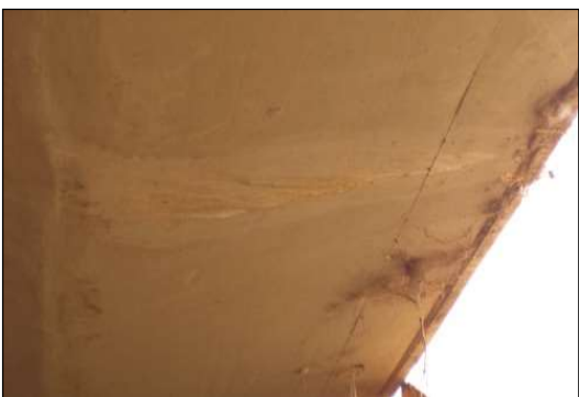
(e) Falha na pingadeira, com água percolando pelo balanço lateral da laje.
