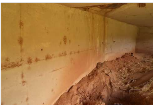
(c) Umidade na longarina, provocada por falha no dreno e aterro apoiado na viga.
