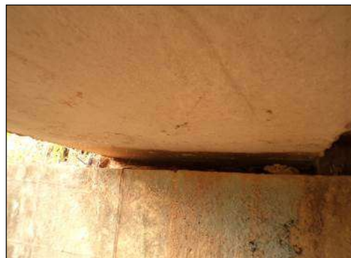
(d) Sujeira e umidade no apoio de uma longarina no encontro.
