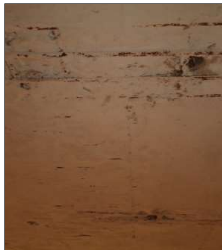
(f) Falha de concretagem no vão da laje, com armadura exposta.
