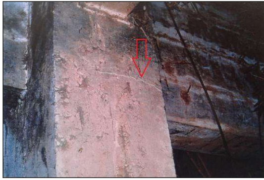
(i) Detalhe de fissura no topo de um pilar.
