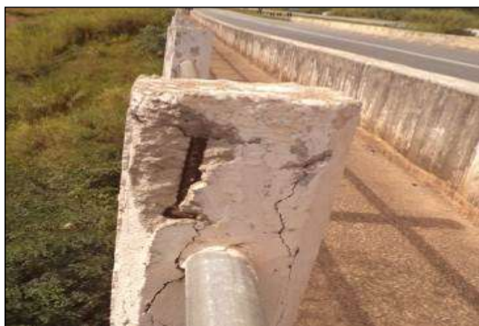
(g) Deslocamento do concreto no guarda-corpo.
