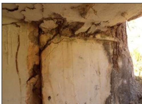
(c) Ruptura do concreto na extremidade da laje, devido ao deslocamento vertical da cortina alargada.
