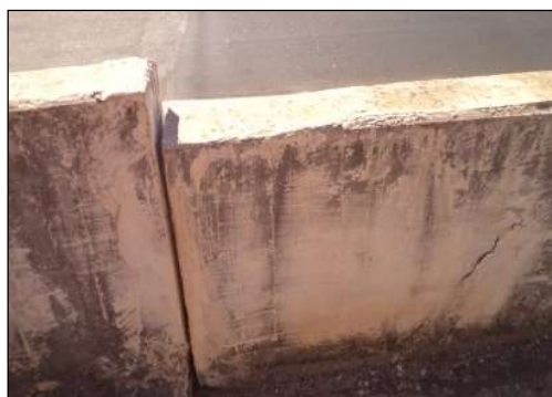
(e) Desalinhamento vertical da barreira New Jersey, na saída da ponte.
