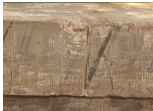
(d) Deslocamento causado por colisão de veículo na face inferior da longarina.
