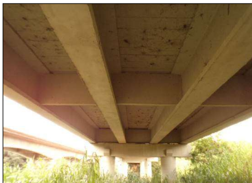
(a) Vista inferior do tabuleiro.
