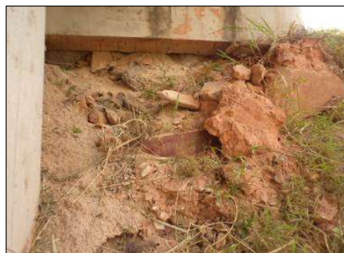
(b) Erosão no talude da pista na extremidade da cortina 2.
