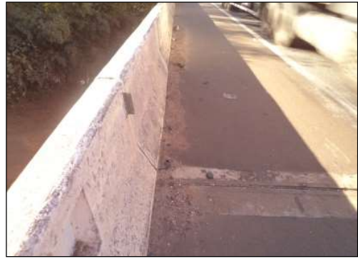
(h) Acúmulo de detritos sobre a junta de dilatação.
