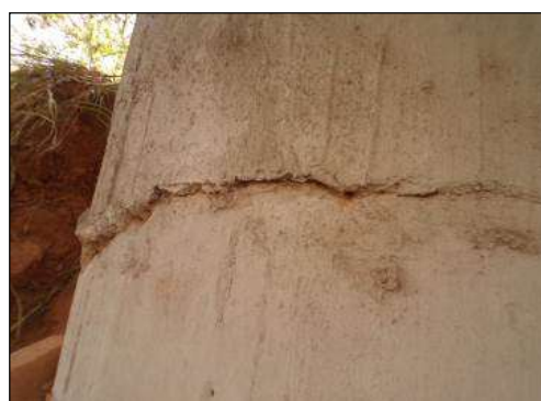
(b) Falha de concretagem no pilar P9.
