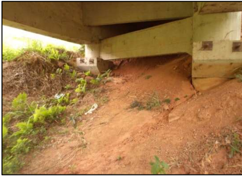
(a) Ausência de proteção vegetal nos taludes dos encontros.
