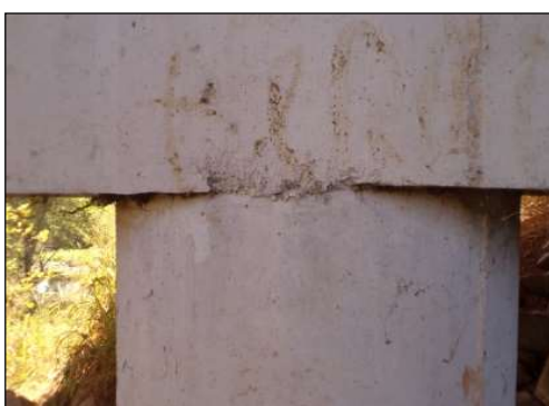
(d) Presença de argamassa ao redor do aparelho de apoio.
