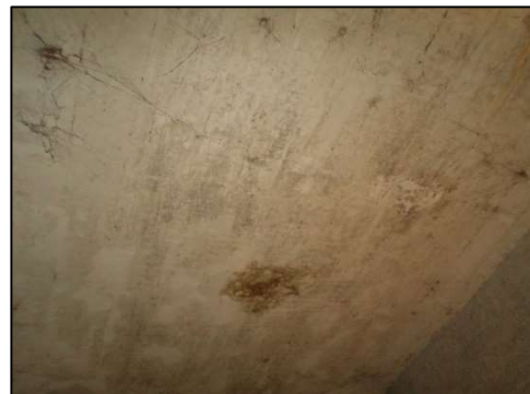
(j) Manchas de eflorescência na face inferior da laje.
