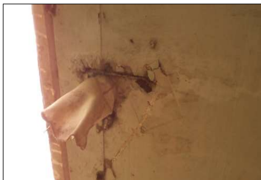
(d) Concreto desagregado ao redor de um dreno na laje, com armadura exposta.
