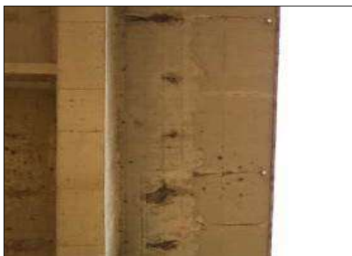
(g) Manchas de infiltração na laje oriunda de drenos antigos.
