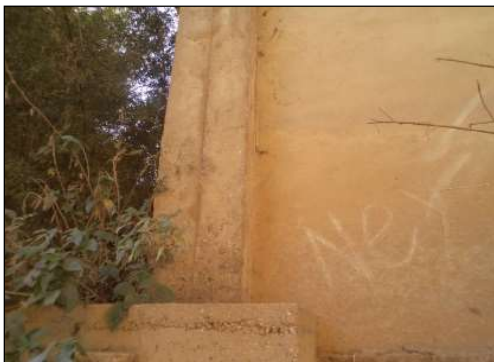
(c) Desgaste superficial do concreto do pilar P8, devido à erosão.
