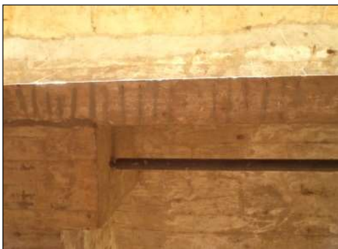
(c) Cobrimento deficiente na face inferior da longarina.
