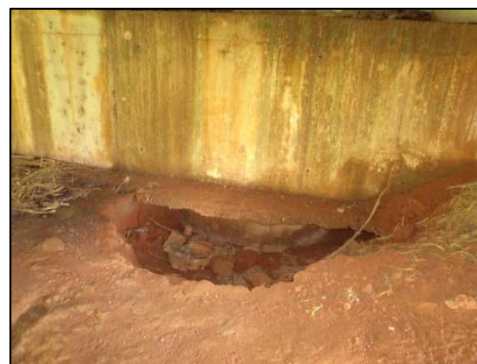
d) Erosão no talude do lado de Bom Despacho, deixando exposta parte do tubulão.
