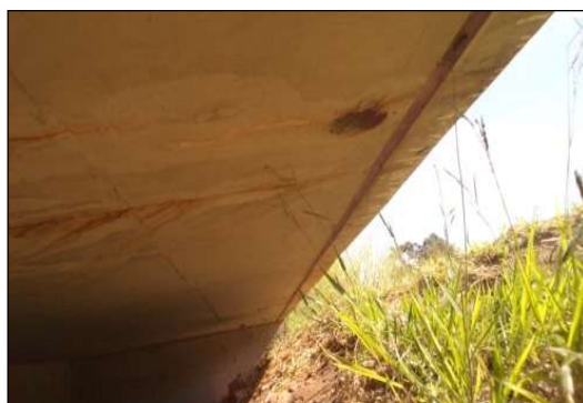
(d) Falha no funcionamento da pingadeira, com água percolando pela laje.
