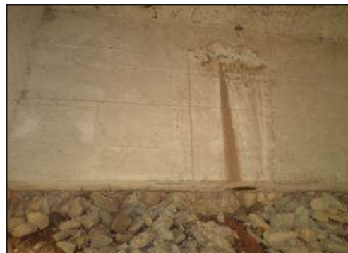
(l) Infiltração de água na cortina 2.
