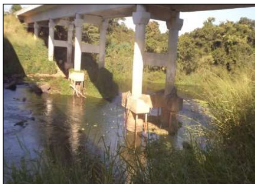
(a) Acúmulo de detritos nos blocos de reforço e partes expostas das estacas raiz nos apoios sobre o rio.
