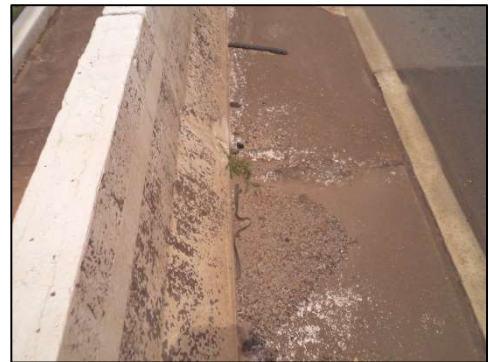
(n) Acúmulo de detritos no acostamento.
