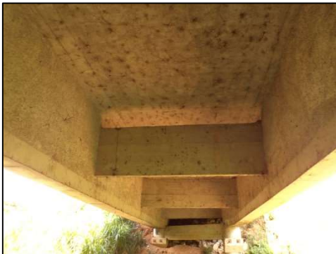
(a) Vista inferior do tabuleiro.
