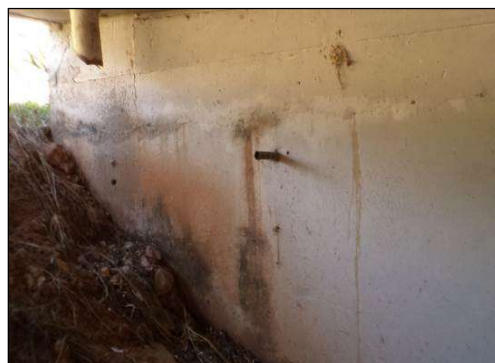
(j) Manchas de infiltração de água em uma cortina.
