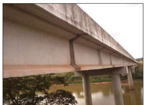
(e) Manchas de infiltração na laje e na longarina, decorrentes de falhas na drenagem.
