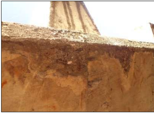
(g) Concreto deteriorado na extremidade lateral da laje, devido à percolação de água nesse local.
