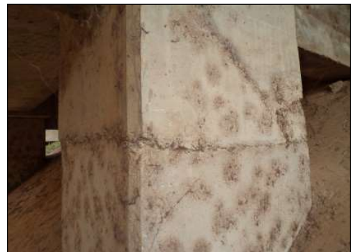
(d) Falha de concretagem na execução do reforço do pilar P12.
