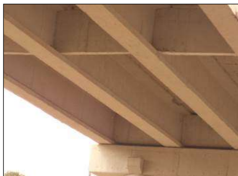
(h) Falha de concretagem, com armadura exposta na mesa superior de uma das longarinas.
