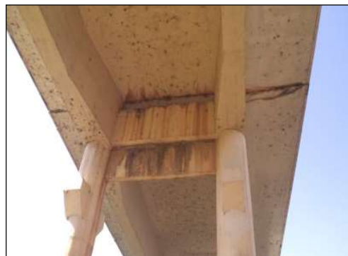
(f) Manchas de infiltração devido à falha na vedação da junta de dilatação.
