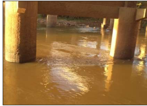
(b) Desgaste superficial por erosão dos elementos de fundação e formação de redemoinhos próximos aos tubulões.
