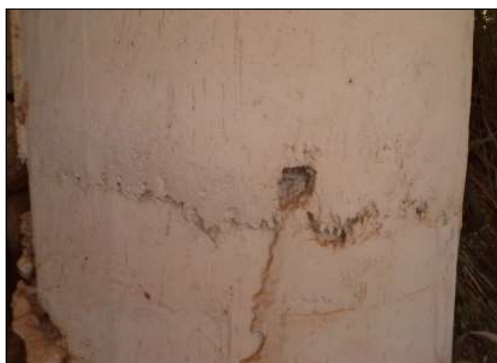
(c) Falha de concretagem em um pilar.
