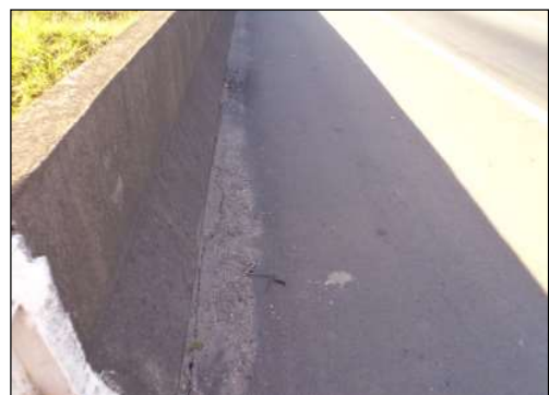
(f) Trinca longitudinal no pavimento, ao lado da barreira de segurança.
