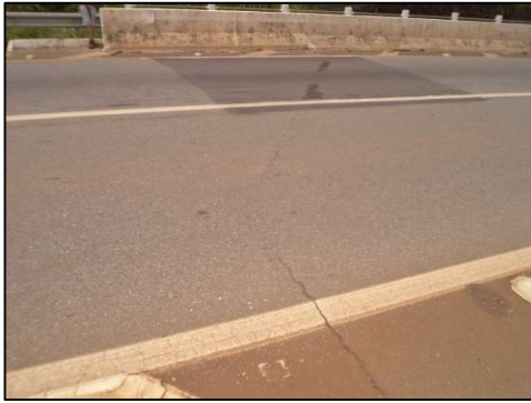
(i) Junta de dilatação obstruída pelo revestimento asfáltico e remendo no pavimento sobre a junta.
