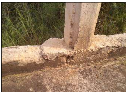
(g) Falha de concretagem no guarda-corpo.
