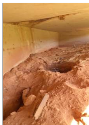
(b) Erosão no talude da pista provocada pelo mau posicionamento de um dreno.
