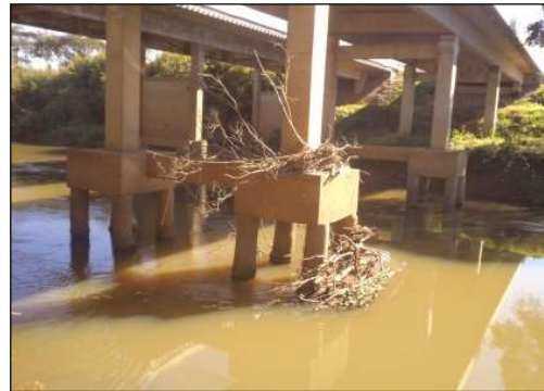
(b) Acúmulo de galhos e detritos nos blocos de fundação.
