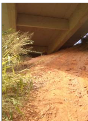
(a) Talude sem proteção vegetal.
