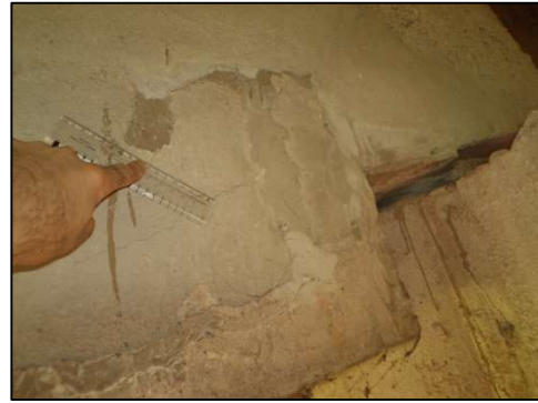
(f) Fissura horizontal no reforço da longarina, com abertura de 0,3 mm.
