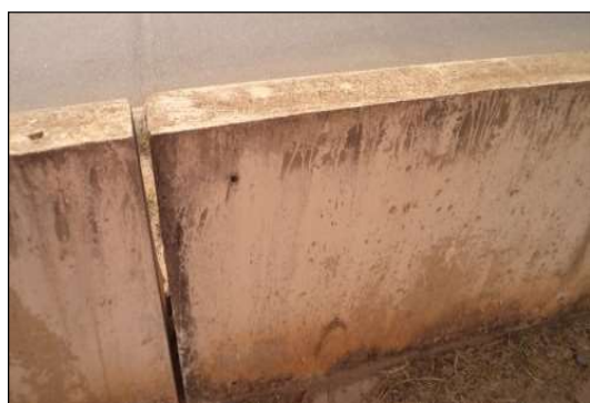
(c) Desalinhamento vertical da barreira New Jersey.
