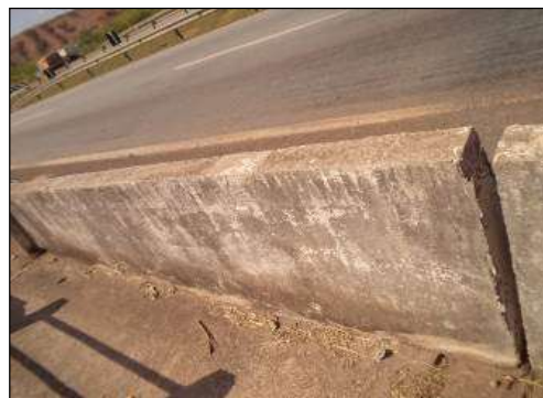
(d) Desalinhamento da barreira New Jersey.
