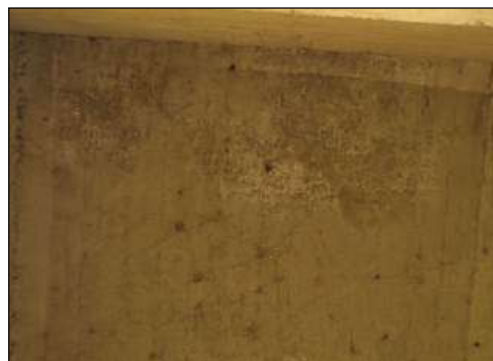
(j) Manchas de infiltração e lixiviação na face inferior da laje.
