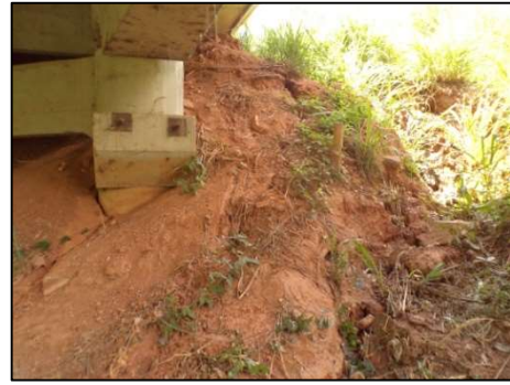
(b) Erosão no talude ao lado da ponte no encontro próximo à cortina 2.
