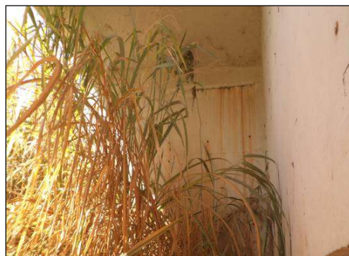
(l) Infiltração de água em trinca horizontal na cortina.
