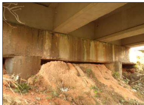
(f) Excesso de umidade e eflorescências no encontro do lado de Betim.
