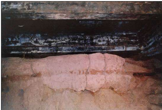
(e) Talude erodido e desprotegido
