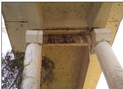
(a) Sinais de infiltração nos pilares situados abaixo da junta de dilatação.
