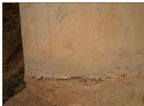
(j) Falha de concretagem em um pilar.
