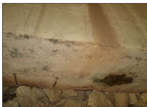
(m) Corrosão de armadura na face inferior da cortina 2.
