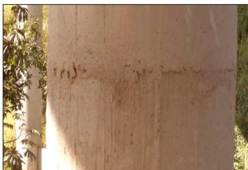
(c) Falha de concretagem em um pilar.
