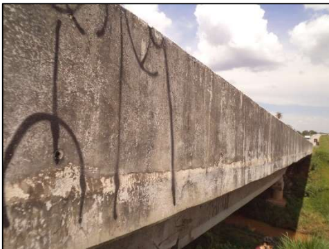
(g) Manchas escuras na barreira New Jersey.
