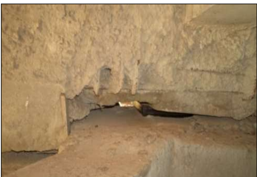
(c) Falha de concretagem, com armadura exposta em uma longarina.
