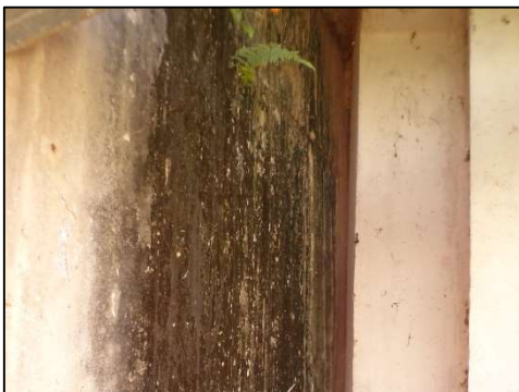
(e) Umidade, manchas escuras e vegetação na parede de contenção de um encontro.
