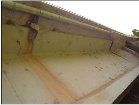
(c) Mancha na laje e na viga principal decorrente do mau funcionamento de um dreno.
