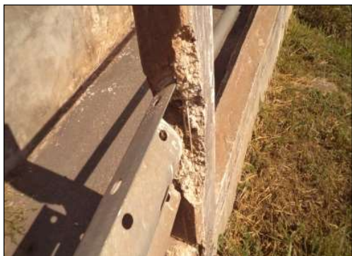
(e) Guarda-corpo danificado por colisão de veículo, com armadura exposta.
