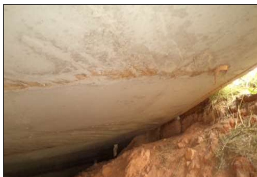
(f) Falha no funcionamento de um dreno, com água percolando pela laje.
