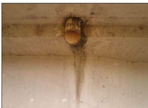
(c) Mancha de infiltração ao redor de um dreno.
