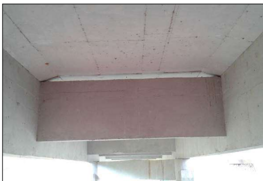
(a) Vista inferior do tabuleiro.
