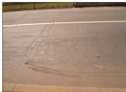
(d) Irregularidades no pavimento na pista de acesso à ponte.
