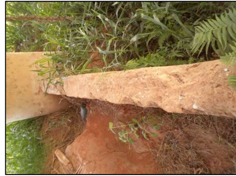
(h) Falha de concretagem na viga de contraventamento dos pilares.
