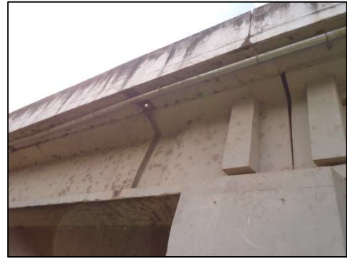
(d) Mancha na laje e na viga principal decorrente do mau funcionamento de um dreno e ausência de pingadeira.
