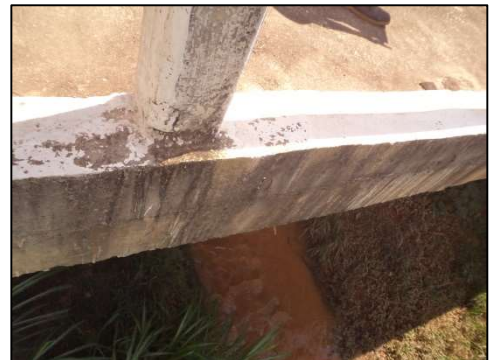
(d) Falha de concretagem no guarda-corpo.
