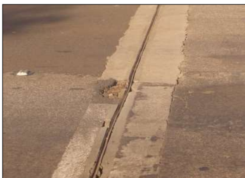
(e) Junta de dilatação indevidamente reparada com massa asfáltica.
