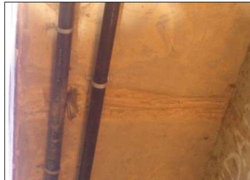
(h) Percolação de água pela face inferior da laje, devido à falha no dreno.
