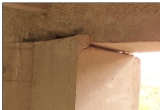
(d) Deslocamento do concreto no topo do pilar.
