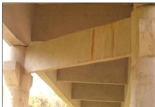
(b) Marcas de infiltração na viga de contraventamento.
