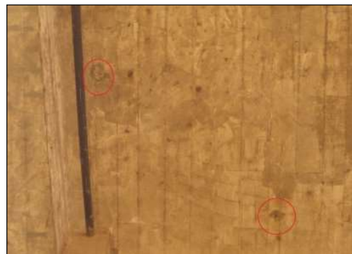
(j) Pontos de corrosão de armadura, com deslocamentos na laje.
