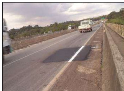
(d) Remendo no pavimento e sinalização horizontal desgastada (zebrado).
