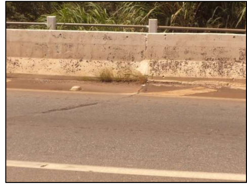
(j) Acúmulo de detritos e crescimento de vegetação sobre a junta de dilatação obstruída pelo revestimento.
