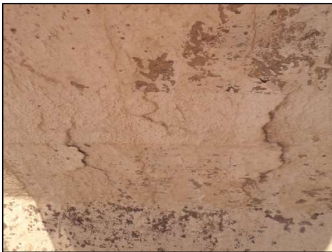
(e) Deslocamentos pontuais na barreira New Jersey.
