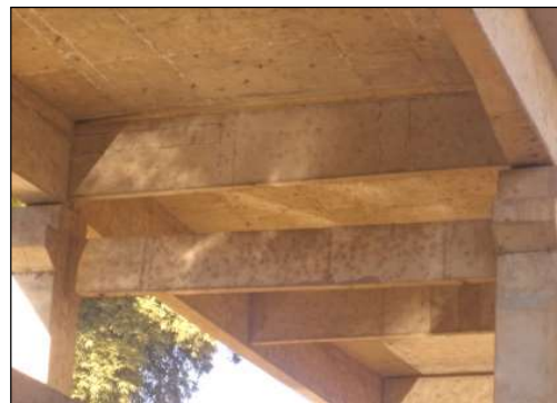
(d) Marcas de infiltração em viga de contraventamento dos pilares.
