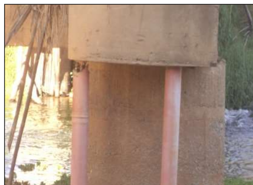
(d) Detalhe da ausência de concreto no topo de uma estaca raiz.
