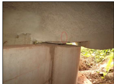
(d) Fissura vertical na camada de reforço da longarina, sobre o aparelho de apoio.
