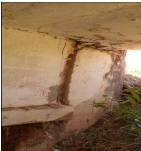
(e) Vista frontal da parte da cortina deslocada, causando a flexão da laje e a ruptura do concreto.
