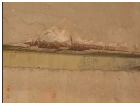
(d) Falha de concretagem, com armadura exposta em uma transversina.
