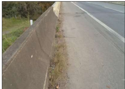
(h) Acúmulo de detritos e vegetação nos bordos da pista.
