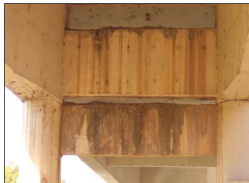
(b) Manchas de infiltração na viga de contraventamento dos pilares situados abaixo da junta de dilatação.
