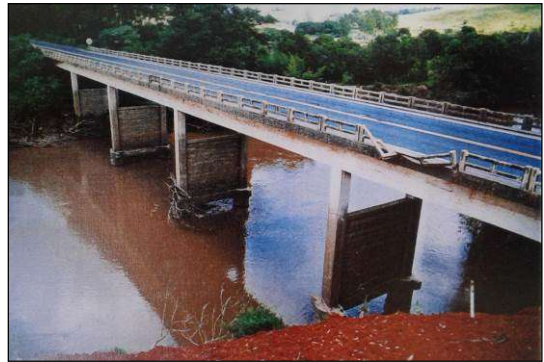
(d) Guarda-corpo danificado
