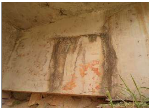
(k) Trinca horizontal na cortina 1, com infiltração de água.
