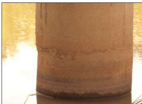
(i) Falha de concretagem, manchas e desgaste superficial por erosão em um pilar parcialmente submerso.
