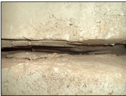
g) Deformação do aparelho de apoio de neoprene.
