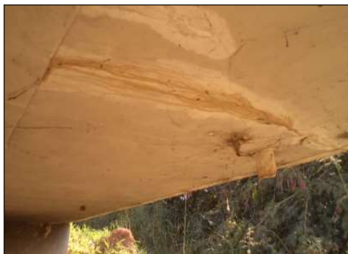
(e) Falha no funcionamento de drenos e da pingadeira
