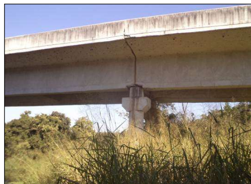
(b) Vista lateral do pilar afetado pela falha de vedação da junta de dilatação.
