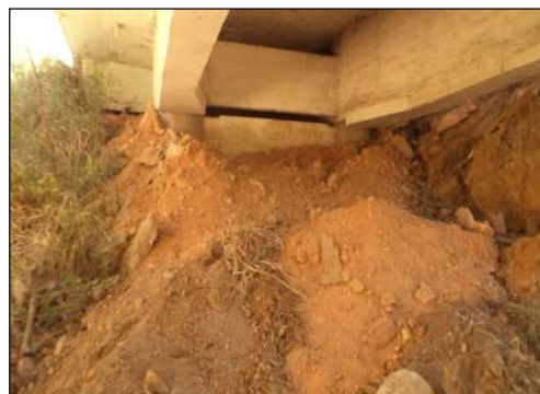
(b) Erosão e falta de proteção vegetal no talude.
