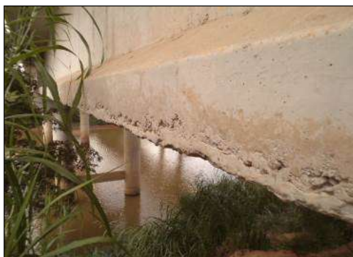
(g) Falha de concretagem na face inferior de uma longarina.
