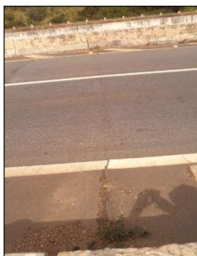
(i) Junta de dilatação obstruída pelo revestimento asfáltico, com acúmulo de detritos e vegetação.
