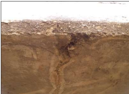
(i) Concreto deteriorado na extremidade lateral da laje.
