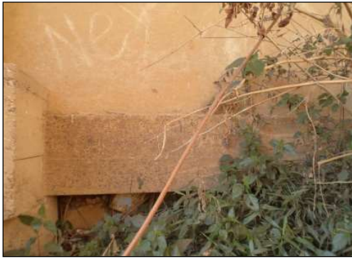
(a) Desgaste superficial por erosão, da cinta que liga os tubulões T2 e T8.
