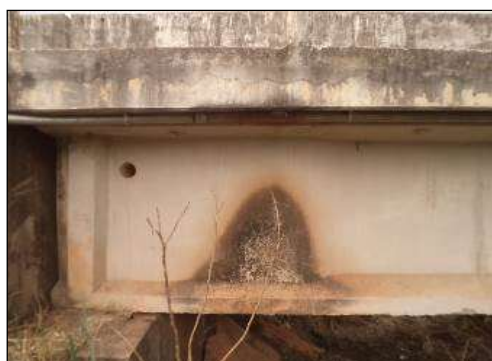
(d) Mancha na viga principal decorrente do mau funcionamento de um dreno.
