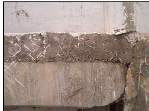
(f) Falha de concretagem no guarda-corpo.
