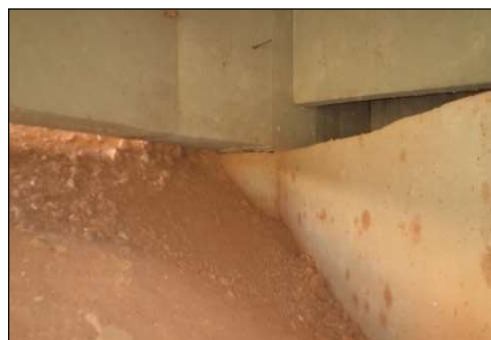
(d) Soterramento do aparelho de apoio pelo aterro do encabeçamento da ponte.
