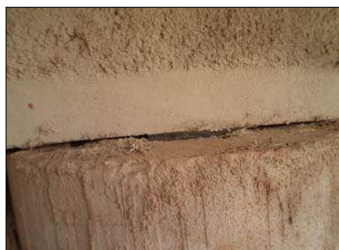
(d) Presença de restos de argamassa próximos a um aparelho de apoio.
