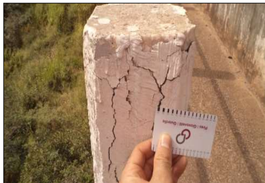
(f) Fissuras provocadas por corrosão de armadura no guarda-corpo.
