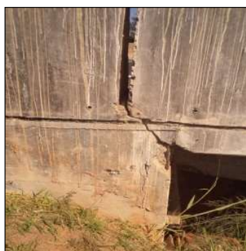
(m) Rachadura, desagregação do concreto e armadura exposta no lado direito da cortina.
