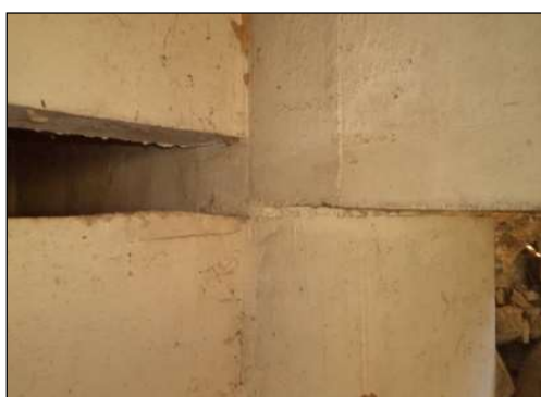
(c) Aparelho de apoio obstruído por isopor, que impede a sua inspeção.
