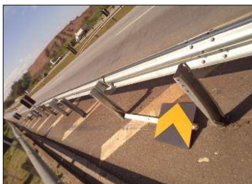
(e) Placa de sinalização danificada.
