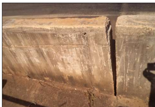
(d) Desalinhamento vertical da barreira New Jersey.
