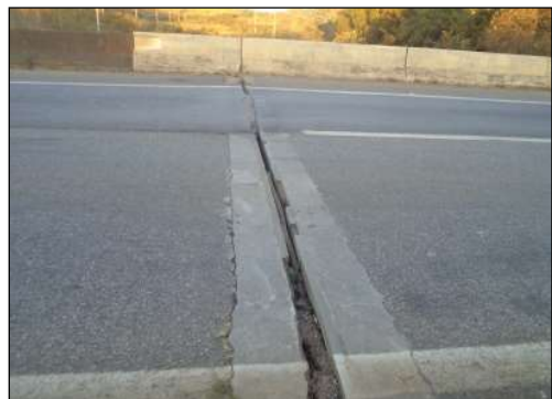
(f) Material de vedação deteriorado e reparo indevido com revestimento asfáltico.
