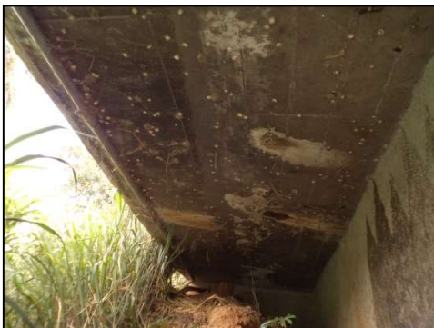
(i) Manchas escuras e infiltração no balanço lateral da laje.
