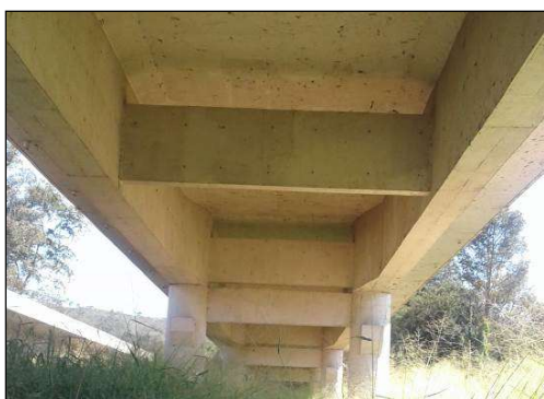
(a) Vista inferior do tabuleiro.
