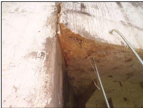
(g) Corrosão de armadura exposta em função do deslocamento.
