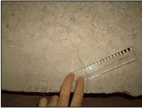
(e) Fissura vertical no reforço da longarina, com abertura de 0,5 mm.
