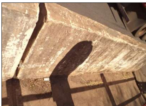
(c) Desalinhamento vertical da barreira New Jersey.
