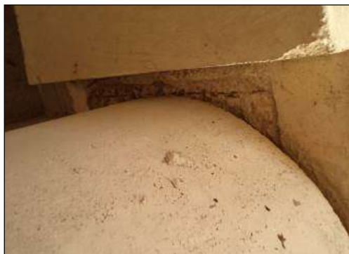
(c) Falha de concretagem, com armadura exposta em uma longarina.
