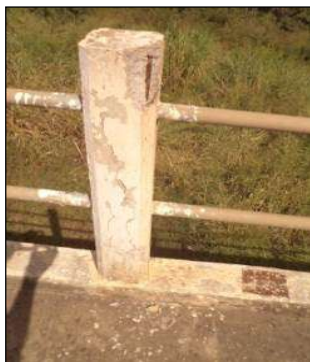
(e) Corrosão de armadura no guarda-corpo.
