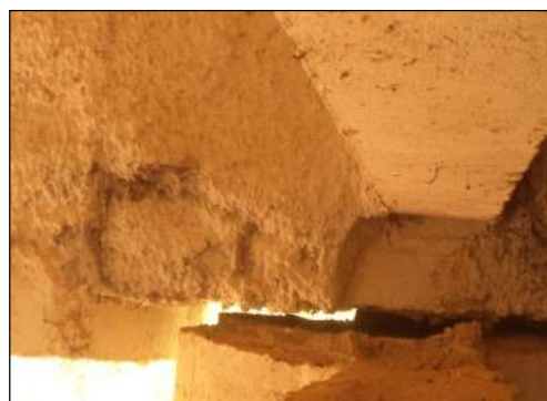
(j) Falha de concretagem, com armadura exposta em uma longarina.
