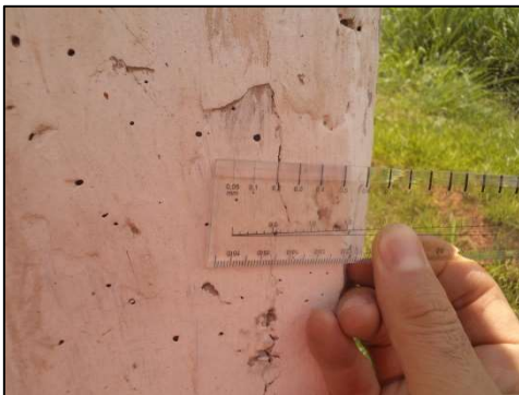
(e) Fissura no guarda-corpo com abertura de 0,2 mm.
