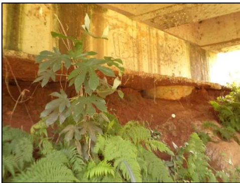
(a) Erosão no talude do lado de Horizonte, provocando o solapamento do solo sob o encontro.
