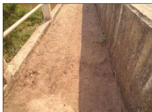
(n) Acúmulo de detritos na passarela, provocando a obstrução dos drenos.
