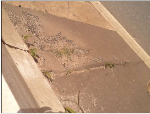
(i) Acúmulo de detritos e vegetação sobre a junta de dilatação.
