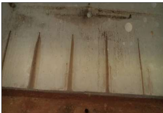
(h) Manchas de infiltração de água em uma cortina.
