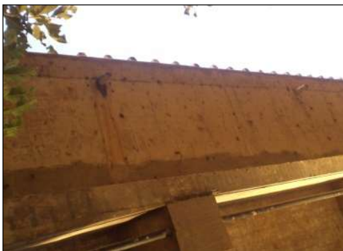
(i) Percolação de água pela face inferior da laje, devido à falha no dreno.
