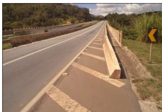
(b) Vista da ponte no sentido Bom Despacho - Belo Horizonte. No detalhe, estreitamento de pista na ponte.
