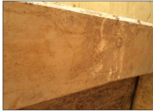
(f) Manchas de eflorescência na face inferior de uma longarina.
