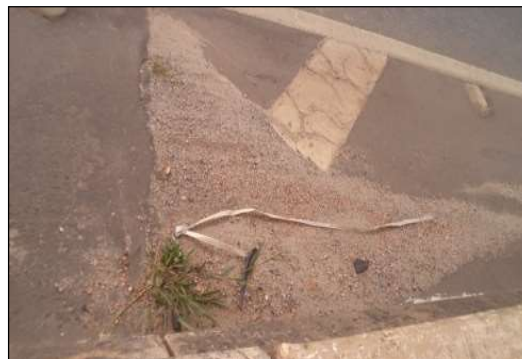
(j) Acúmulo de detritos e crescimento de vegetação sobre a junta de dilatação.
