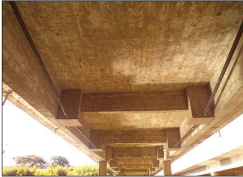
(a) Vista inferior do tabuleiro.
