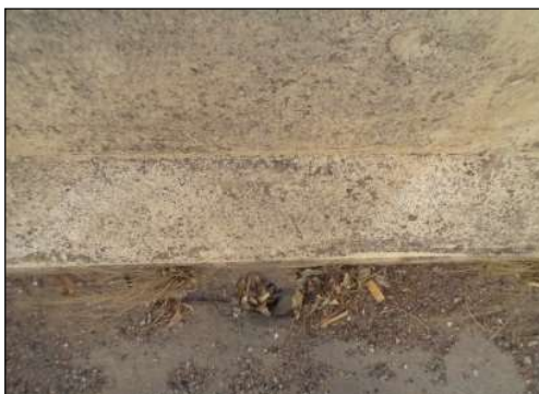
(i) Dreno obstruído por detritos.
