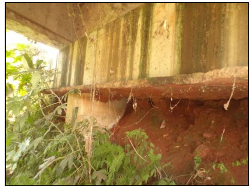
(b) Excesso de umidade e manchas de eflorescência no encontro do lado de Belo Horizonte.
