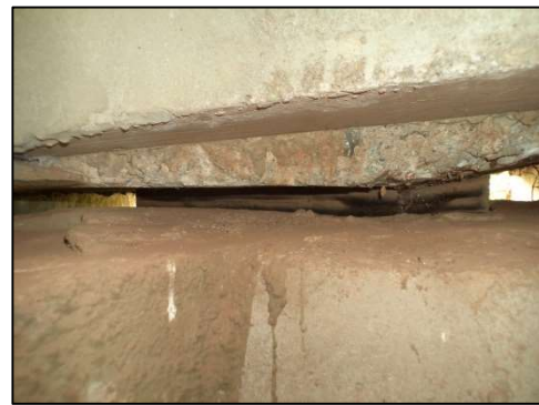
h) Deformação do aparelho de apoio de neoprene.
