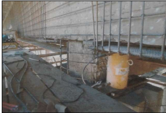
Figura 4.27 – Detalhes da execução da troca de aparelhos de apoio e do reforço dos pilares da ponte sobre o Ribeirão Mateus Leme.
