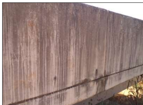
(d) Marcas de infiltração e manchas no concreto da Barreira New Jersey.
