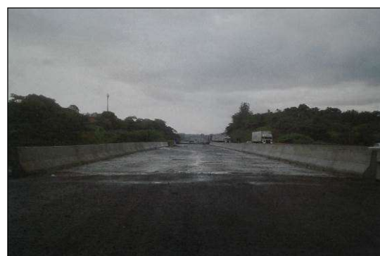
(d) Alargamento e reforço da laje concluídos, além da troca dos antigos guarda-rodas e guarda-corpos pelas barreiras New Jersey.
