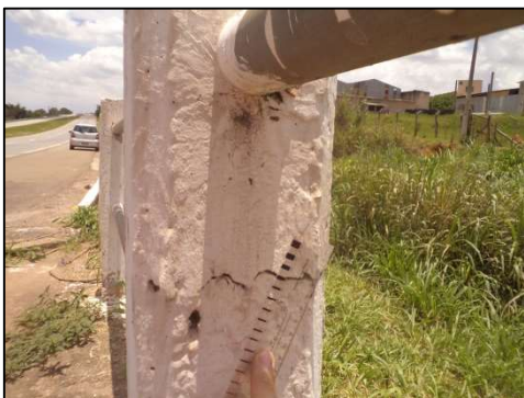
(g) Fissura com abertura de 2,0 mm no guarda-corpo.
