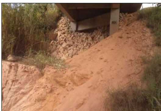
(a) Talude desprotegido e erosão em uma das extremidades da ponte.
