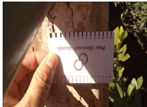
(h) Fissura de corrosão com 1,4 mm de abertura no guarda-corpo.
