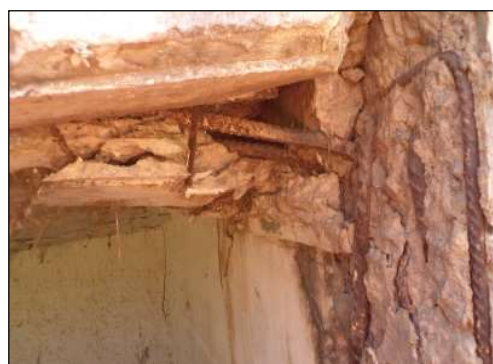
(d) No detalhe, flexão da laje na extremidade, com ruptura do concreto e exposição de armadura.
