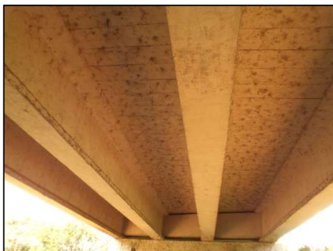
(a) Vista inferior do tabuleiro.
