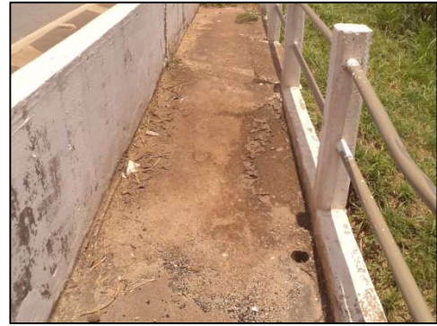
(j) Acúmulo de detritos na passarela, devido a problemas de drenagem.
