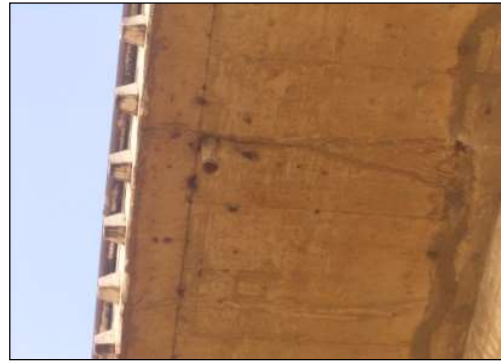
(h) Percolação de água pela face inferior da laje, devido à falha na pingadeira e no dreno.
