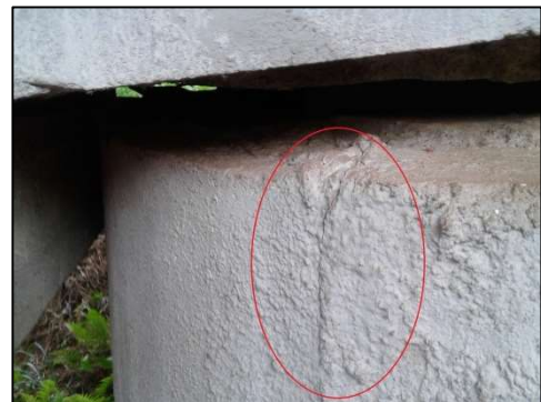
(d) Fissura vertical no topo de um pilar, devido à concentração de esforços.
