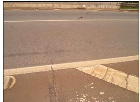
(h) Junta de dilatação obstruída pelo revestimento asfáltico.
