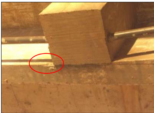
(e) Armadura exposta em uma longarina, ao lado de um bloco de ancoragem do cabo de protensão.
