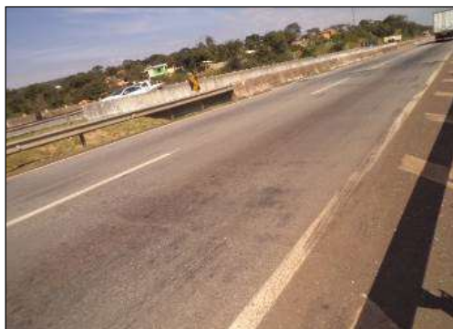
(c) Trilhas de roda e ondulações no pavimento da pista de acesso.
