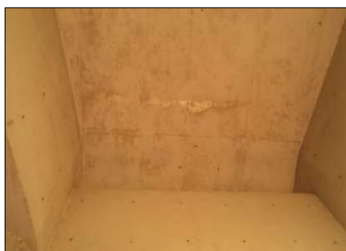
(g) Manchas de infiltração na face inferior da laje.
