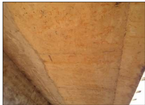
(f) Manchas na face inferior da laje, indicando de corrosão de armadura.
