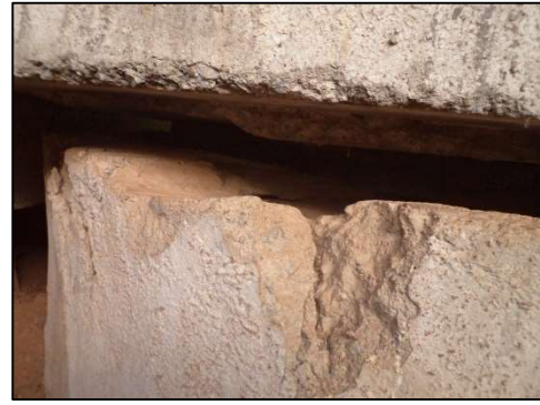
f) Trinca e deslocamento do concreto no topo do pilar, devido à concentração de esforços de compressão.
