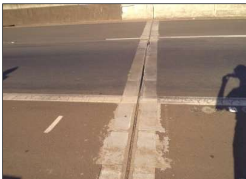
(c) Junta de dilatação com material de vedação parcialmente rompido.
