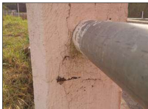
(h) Corrosão de armadura no guarda-corpo.
