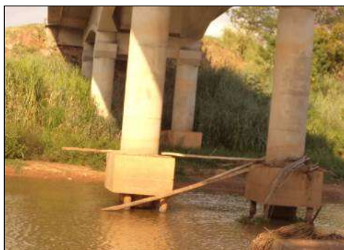
(a) Acúmulo de detritos nos blocos de reforço e parte expostas das estacas raiz nos apoios sobre o rio.
