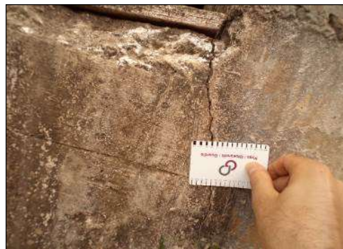
(h) Verificação da abertura da trinca com a utilização do fissurômetro.
