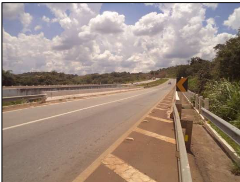
(c) Estreitamento de pista na ponte.
