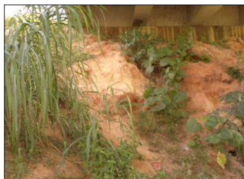
(b) Erosão no talude da pista próximo ao encontro do lado de Juatuba.
