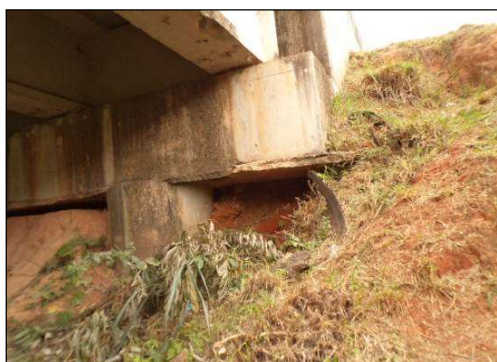
(a) Erosão no talude da pista próximo ao encontro do lado de Betim.
