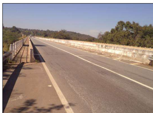
(b) Vista geral – sentido Bom Despacho - Belo Horizonte. No detalhe, trilhas de roda e ondulações na saída da ponte.
