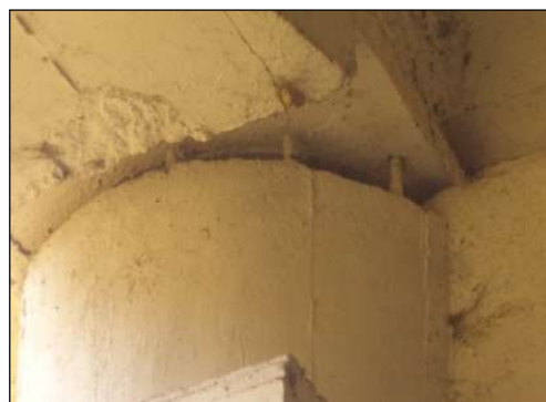
(d) Falha de execução do reforço de um pilar, com armadura exposta no topo.
