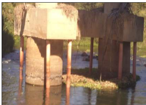
(c) Concreto desagregado no topo das estacas raiz.
