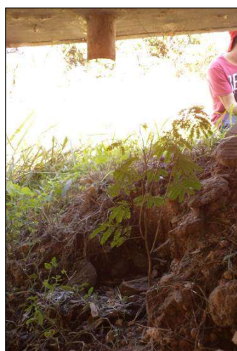
(c) Erosão no talude provocado pelo lançamento do dreno no aterro.
