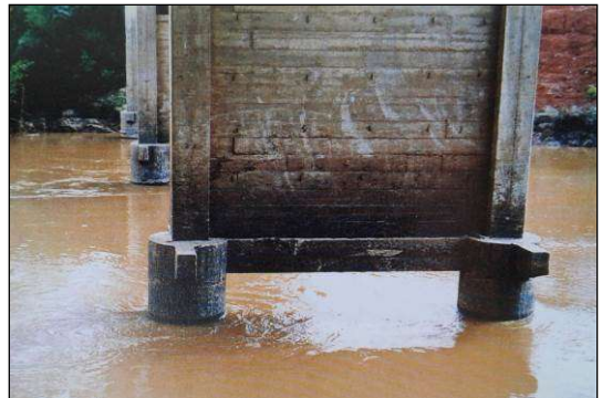
(f) Erosão no concreto (apoios submersos)
