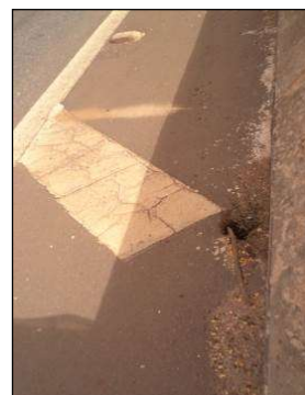
(j) Acúmulo de detritos na pista, provocando a obstrução dos drenos.
