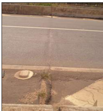
(g) Junta de dilatação obstruída pelo revestimento asfáltico.
