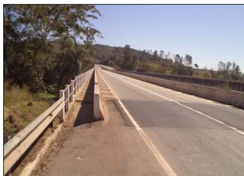
(c) Estreitamento de pista na ponte e remendo executado sobre a junta.
