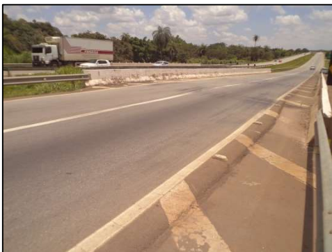
(c) Pequenas ondulações no pavimento da pista de acesso.
