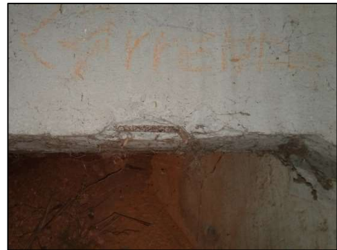
(b) Deslocamento pontual em uma viga de contraventamento dos pilares.
