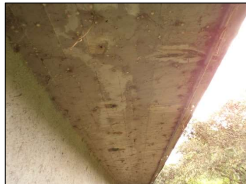
(h) Falha na pingadeira e nos drenos, com água percolando pela laje.
