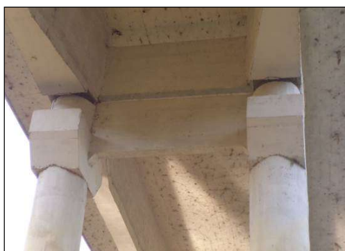
(a) Vista inferior do tabuleiro.
