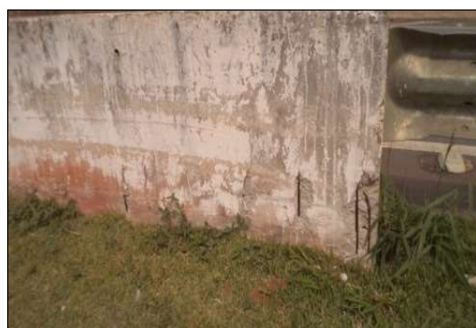
(d) Corrosão de armadura na barreira New Jersey
