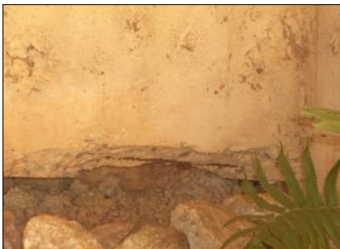
(c) Deslocamento pontual, com corrosão de armadura, em uma viga de contraventamento dos pilares.
