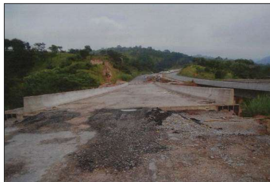
(b) Alargamento e reforço da laje concluídos, além da troca dos antigos guarda-rodas e guarda-corpos pelas barreiras New Jersey.
