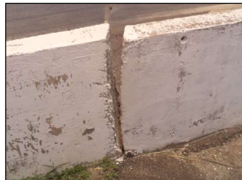
(d) Desalinhamento da barreira New Jersey no encontro.
