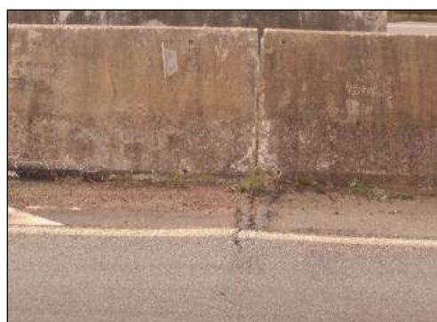
(j) Crescimento de vegetação sobre a junta de dilatação obstruída.
