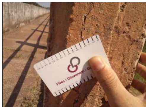
(h) Fissura com abertura de 0,65mm no guarda-corpo.
