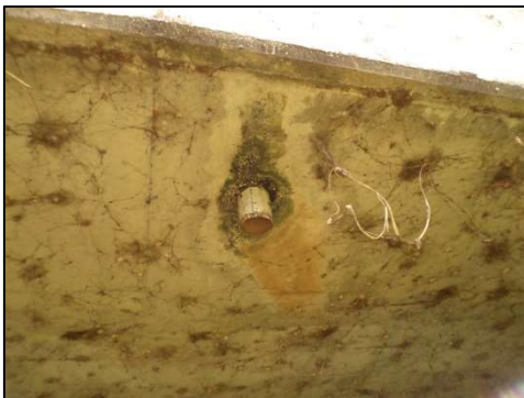
(g) Falha no funcionamento dos drenos, com água percolando pela laje.
