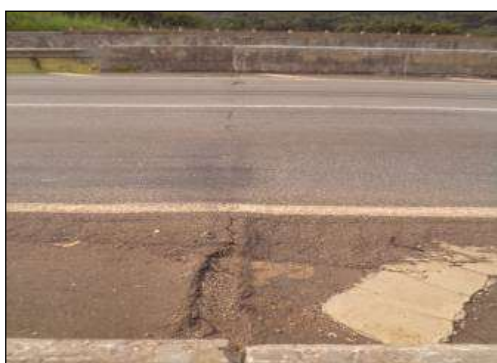
(i) Junta de dilatação obstruída pelo revestimento asfáltico.
