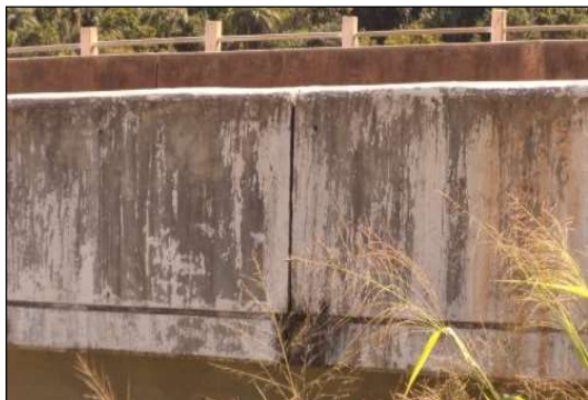
(e) Manchas e infiltração de água na barreira New Jersey.
