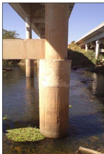
(a) Desvio de geometria no tubulão sob o pilar P11.
