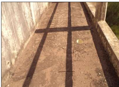
(c) Armadura exposta na face superior da laje na passarela.
