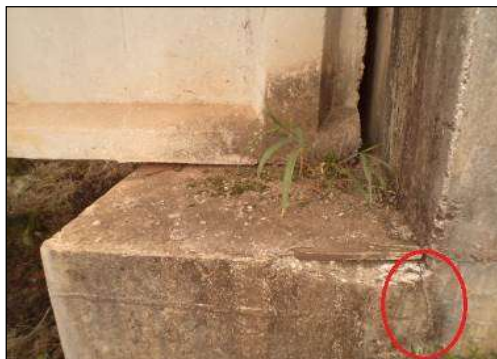
(g) Trinca no encontro do lado de Betim.
