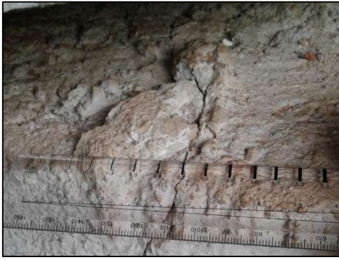
e) Fissura no topo do pilar, com abertura de 0,7 mm.
