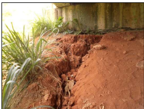
c) Erosão no talude do lado de Bom Despacho.
