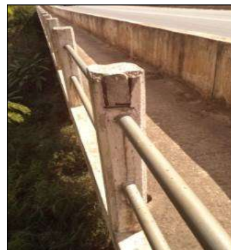
(f) Corrosão de armadura e deslocamento no guarda-corpo.
