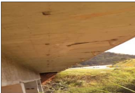
(g) Falha nos drenos, com água percolando pelo balanço lateral da laje.
