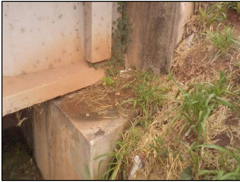
(g) Detritos e umidade no apoio de uma longarina no encontro.
