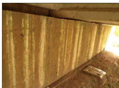
(b) Excesso de umidade e manchas de eflorescência no encontro do lado de Juatuba.
