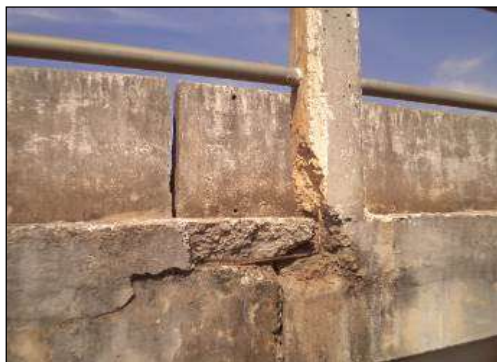
(g) Falha de concretagem, com deslocamento no guarda-corpo.
