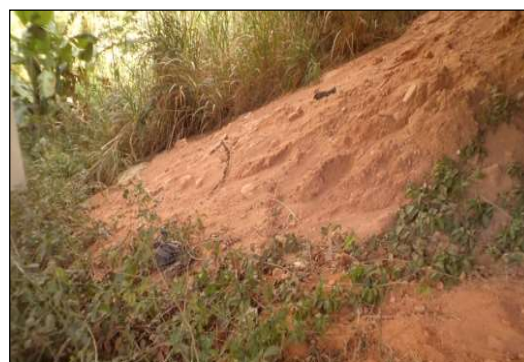
(b) Talude desprotegido na outra extremidade da ponte.
