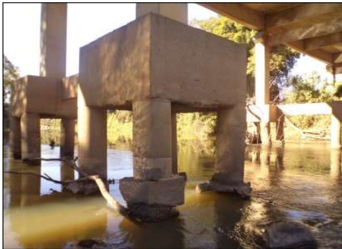
(a) Desgaste superficial por erosão nos encamisamentos das estacas expostas e nos blocos de fundação
