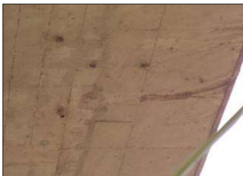
(e) Manchas de infiltração na face inferior da laje, indicando falha no sistema de drenagem.
