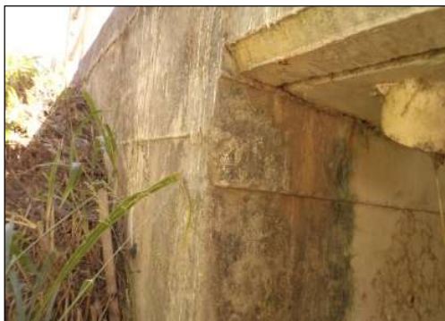
(k) Manchas de infiltração de água em uma cortina.
