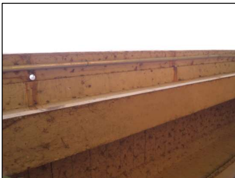
(e) Manchas de infiltração na laje e na longarina.
