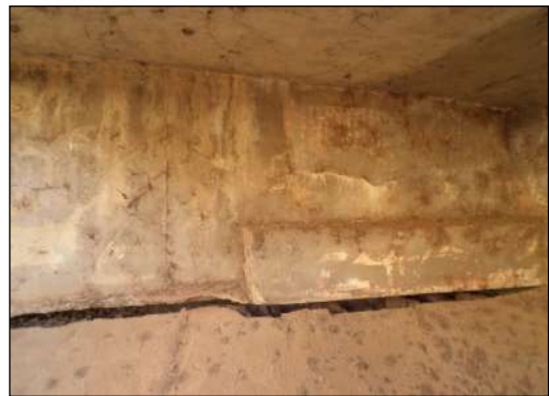
(j) Manchas de infiltração na cortina e sinais de um leve afundamento do aterro.
