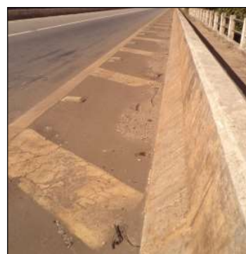
(n) Acúmulo de detritos na pista.
