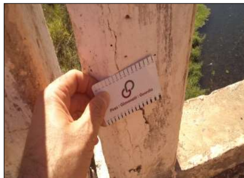
(f) Fissura com abertura de 0,4 mm no guarda-corpo, devido à corrosão de armadura.
