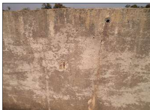
(f) Corrosão de armadura, manchas e fissura vertical na barreira New Jersey
