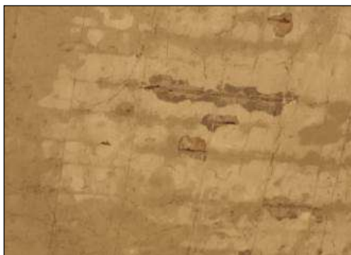
(i) Armadura exposta e deslocamentos na face inferior da laje.
