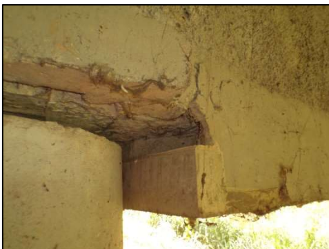
(c) Falha de concretagem, com armadura exposta nas longarinas, sob os pilares.
