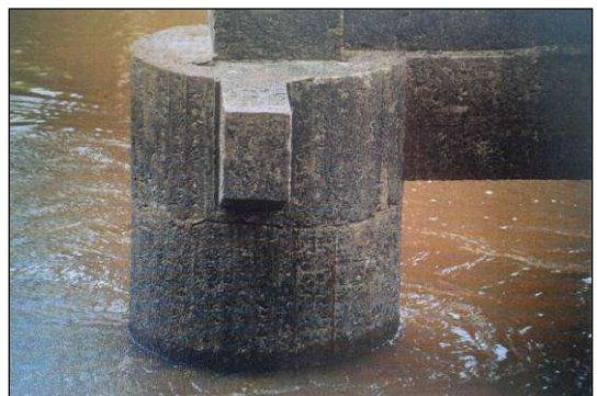
(h) Detalhe da junta de concretagem e erosão no tubulão.
