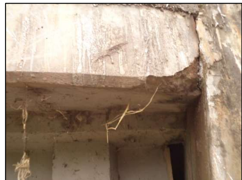
(f) Deslocamento na extremidade da laje no contato com o encontro.
