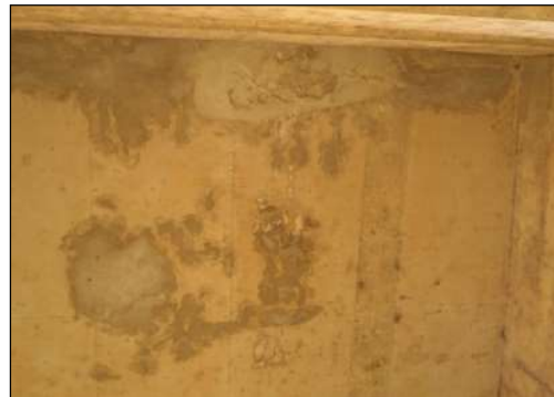
(j) Concreto deteriorado na face inferior da laje.
