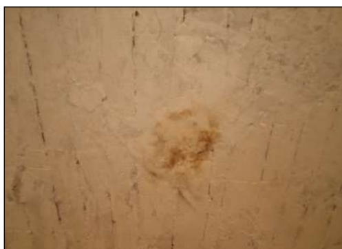
(g) Manchas de infiltração de água na face inferior da laje.
