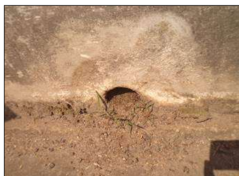
(j) Acúmulo de detritos na passarela, provocando a obstrução dos drenos.
