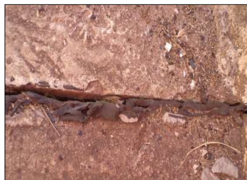
(j) Material de vedação da junta de dilatação deteriorado.
