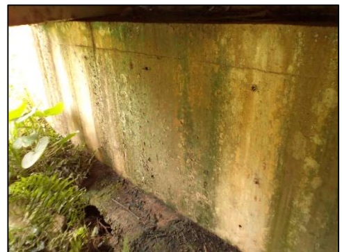
(d) Manchas de eflorescência no encontro.
