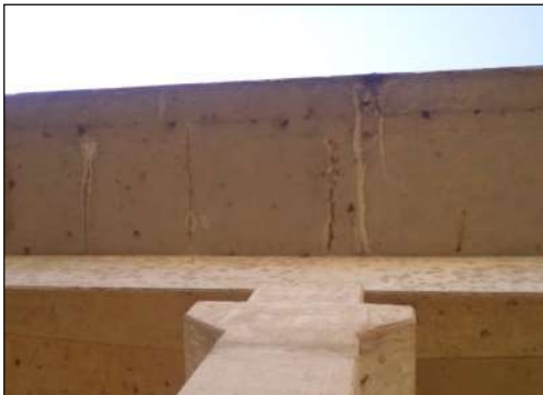
(g) Percolação de água sob a laje devido à falha na pingadeira.
