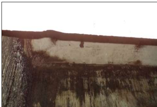
(i) Umidade, manchas escuras e população de morcegos na cortina.
