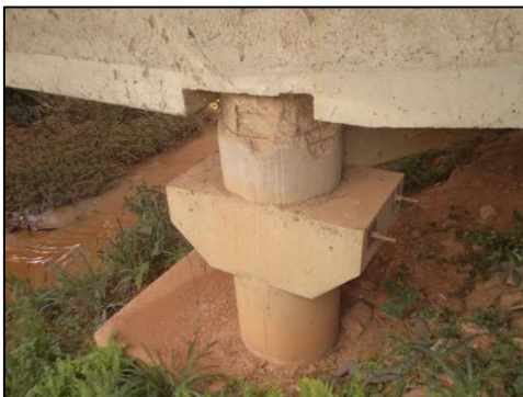
(c) Deslocamentos no topo de um pilar, com armadura do reforço exposta.
