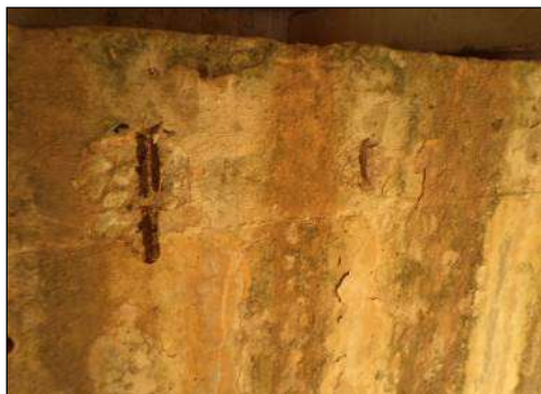
(c) Corrosão de armadura no encontro do lado de Juatuba.
