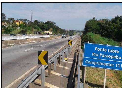
(a) Vista geral da ponte – sentido Belo Horizonte – Bom Despacho. No detalhe, estreitamento de pista no acostamento.
