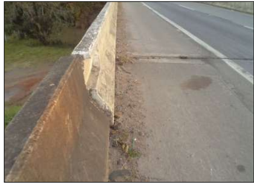
(d) Desalinhamento da barreira New Jersey e degrau no encontro do tabuleiro com o terrapleno.
