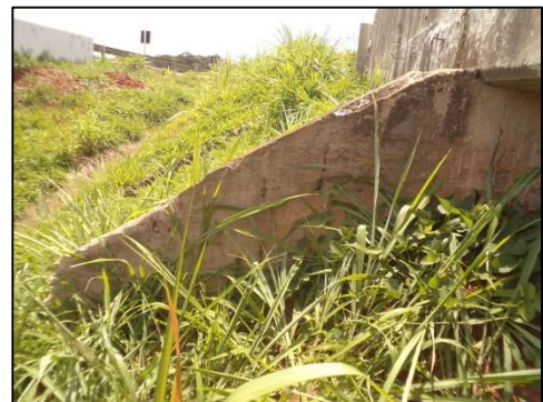
(l) Corrosão de armadura em uma cortina.
