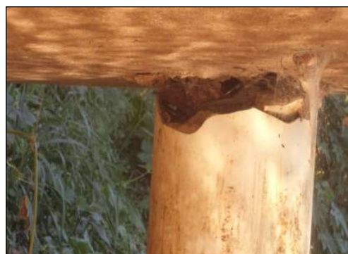
(f) Falha de concretagem e concreto desagregado no topo de uma estaca raiz.
