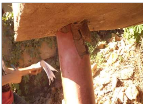
(e) Concreto desagregado no topo de uma estaca raiz.
