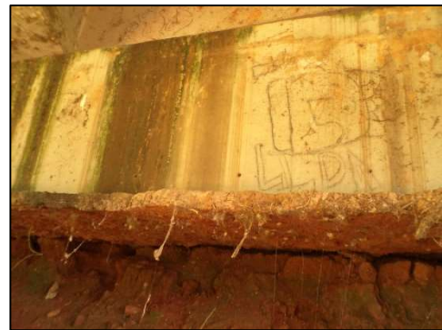
(b) Erosão no talude do lado de Belo Horizonte, provocando o solapamento do solo sob o encontro.
