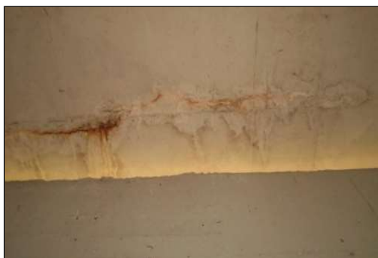
(g) Manchas de infiltração no vão da laje.
