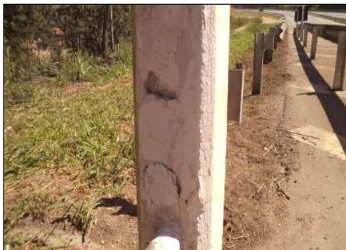
(g) Corrosão de armadura e deslocamento no guarda-corpo.
