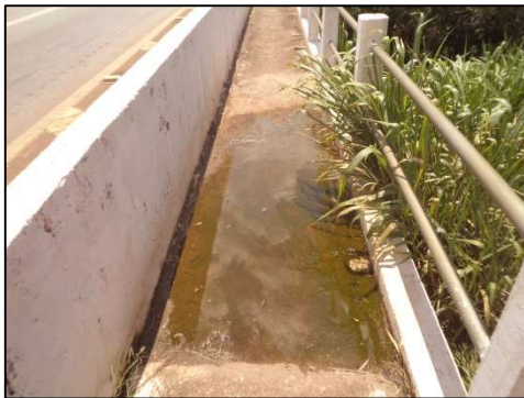
(m) Acúmulo de água no piso da passarela.
