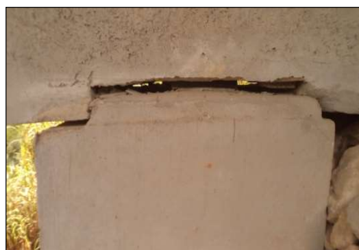
(b) Falha na execução do reforço dos pilares e das longarinas, com restrição à movimentação da superestrutura.
