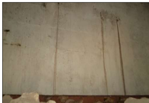
(h) Infiltração de água em uma das cortinas.
