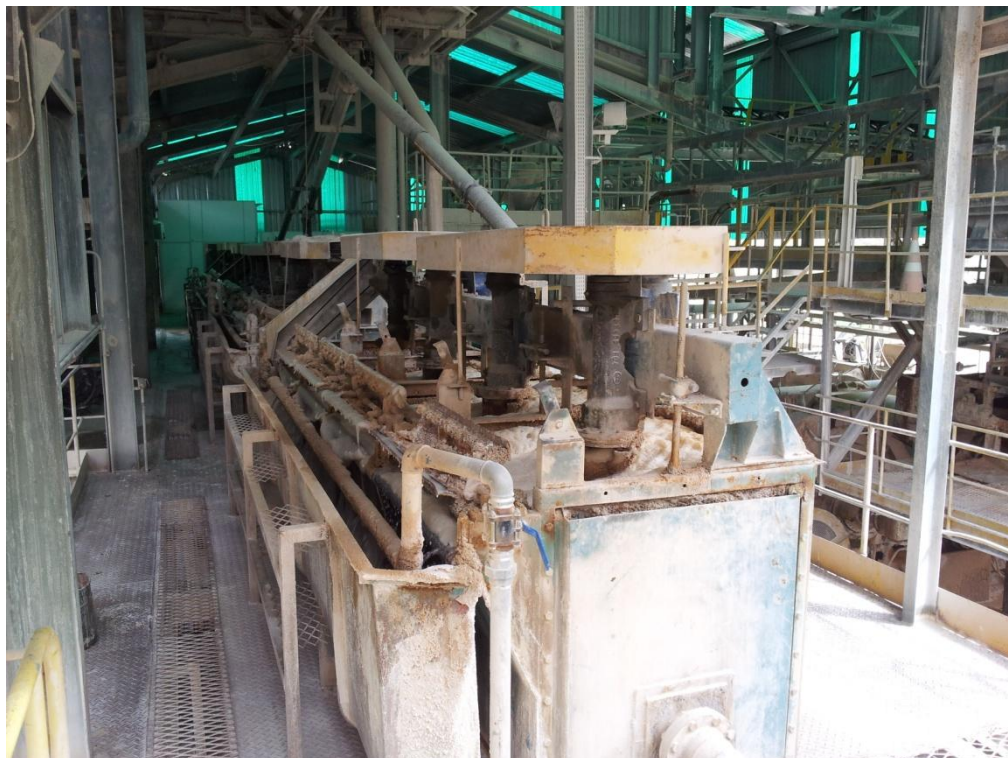
Figura 5.25 – Bancos de flotação na usina de beneficiamento de magnesita.
