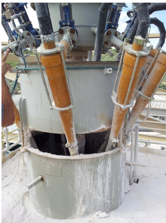
Figura 5.24 – Bateria de hidrociclones do processo industrial.
