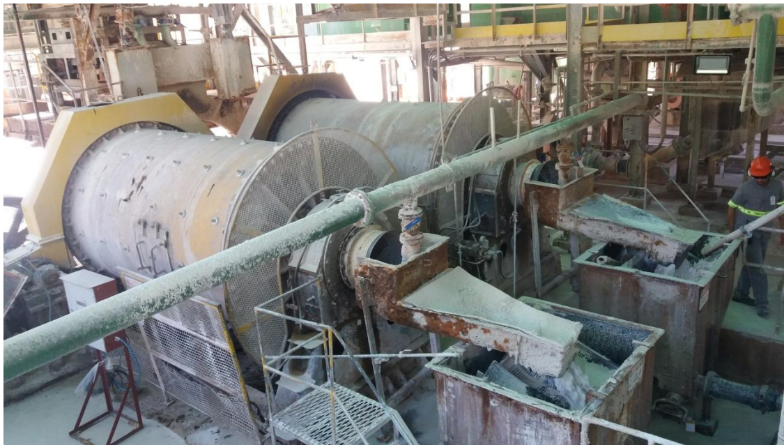
Figura 5.5 – Moinhos 1 (superior) e 2 (inferior) em operação.
