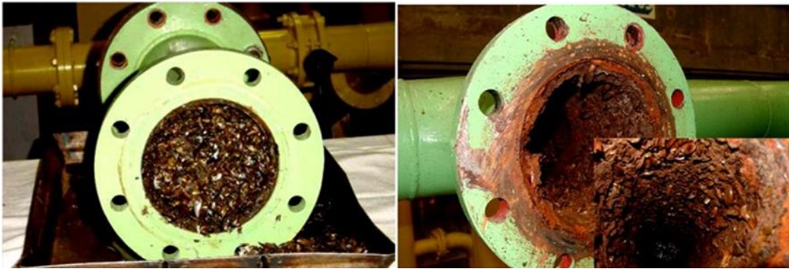
FIGURA 4.2 – Tubulação infestada por L. fortunei (mexilhão dourado) FONTE – CARDOSO, 2011
