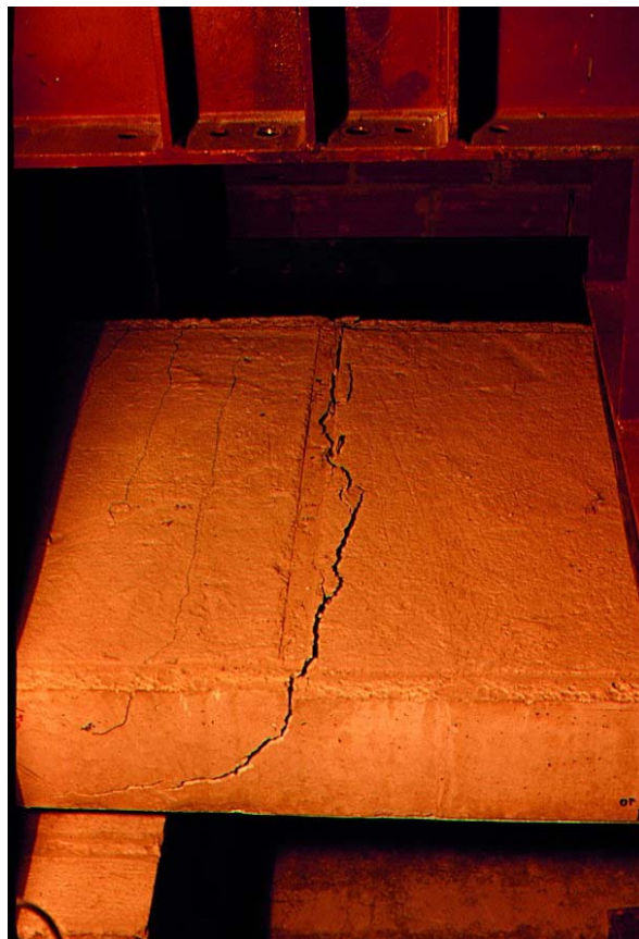
Figura D3 – Detalhe da fissura principal devido ao momento atuante no apoio interno.
