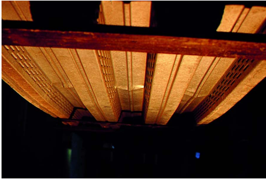
Figura D2 – Detalhe da flambagem local da fôrma metálica
