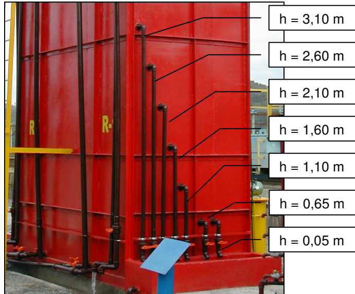
Figura 7.1: Altura dos pontos de coleta de amostragem do lodo dos reatores UASB
