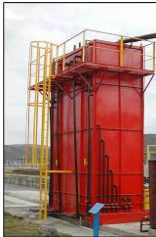
Figura 8.2: Vista dos reatores UASB
