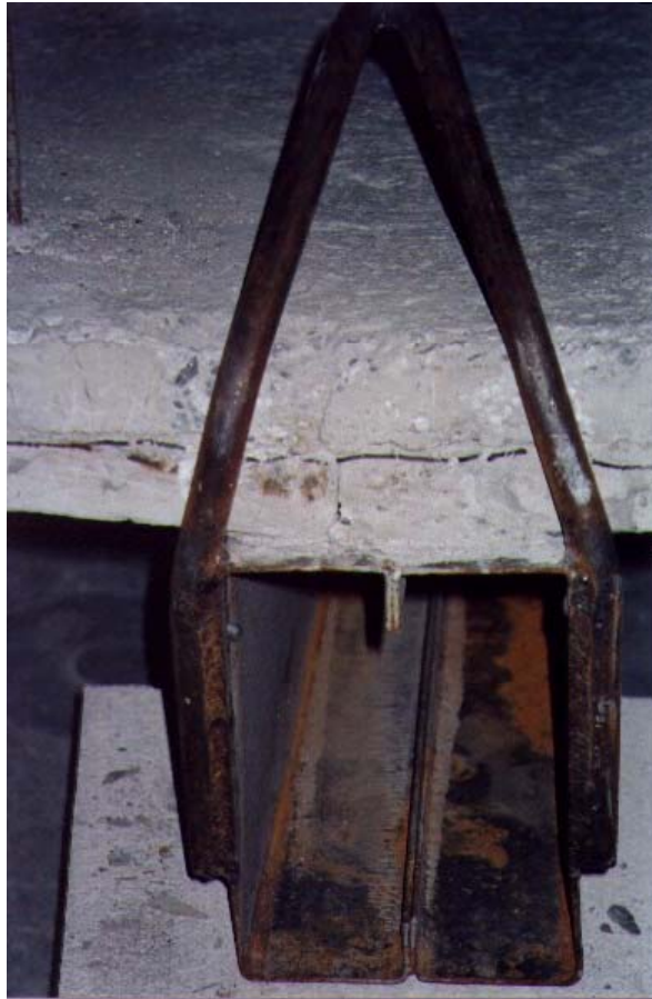
Foto 4.12- Detalhe da separação entre o capeamento e a pré-laje na extremidade da viga.
