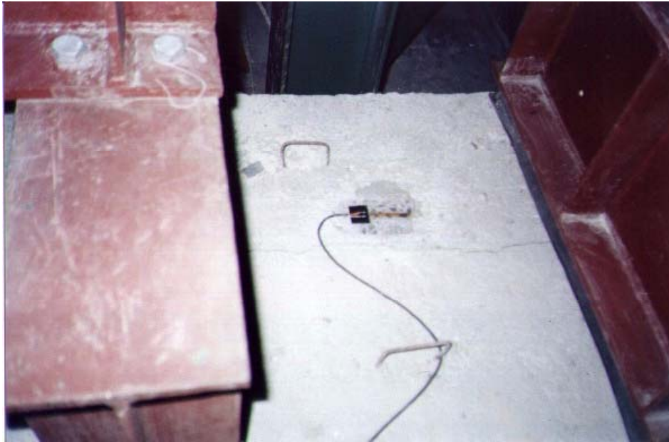
Foto 4.8- Ruptura do concreto no modelo 3.
