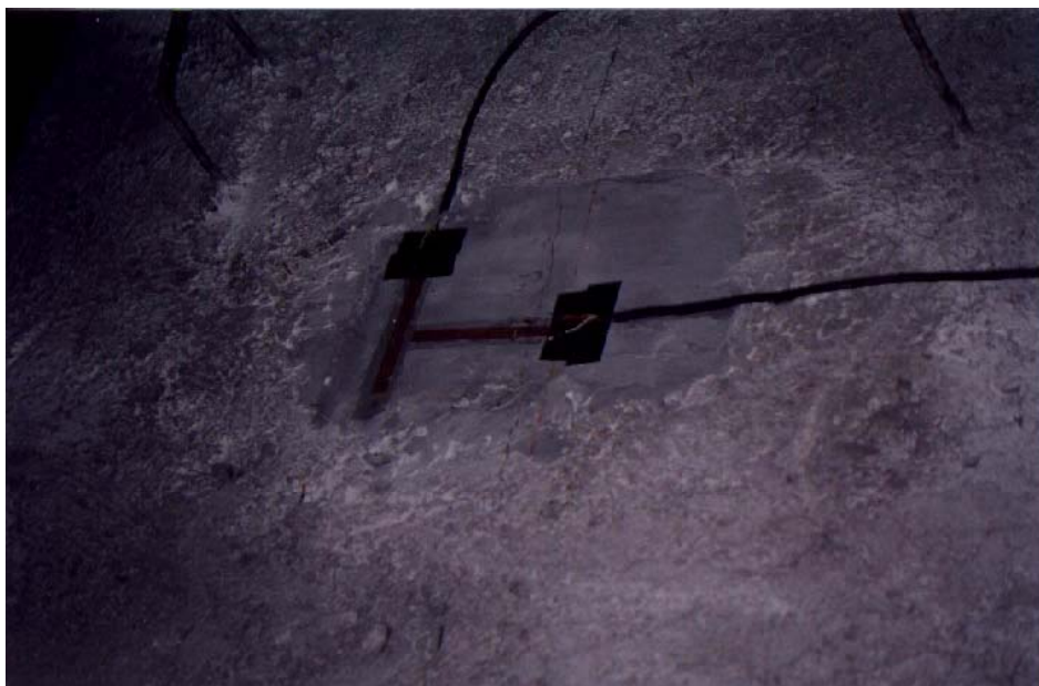
Foto 4.9- Ruptura do concreto no modelo 6.
