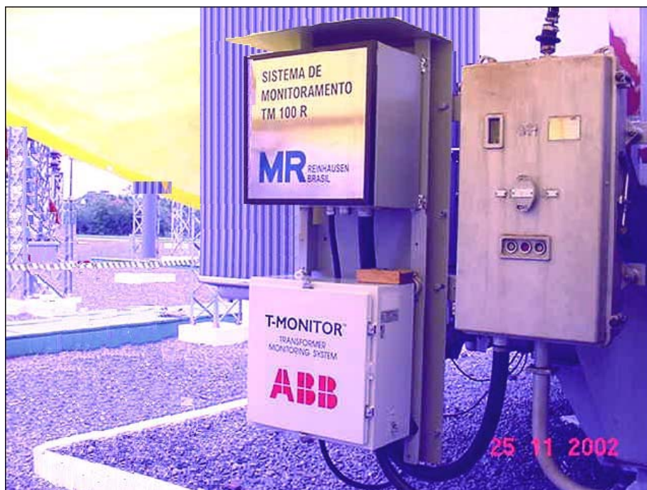
Figura 4.4 – Caixas do Monitoramento Fixadas no Transformador. Fonte: [CEMIG,2006].
