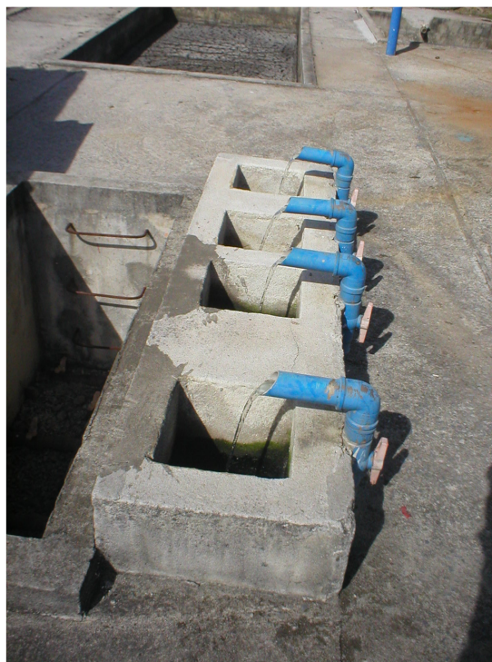
Figura 4.10 - Saída do efluente do reator UASB - local de medição da vazão no sistema
