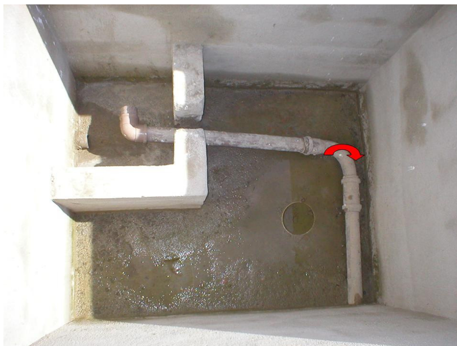
Figura 4.8 - Saída do efluente final do sistema por meio de uma caixa de alvenaria
