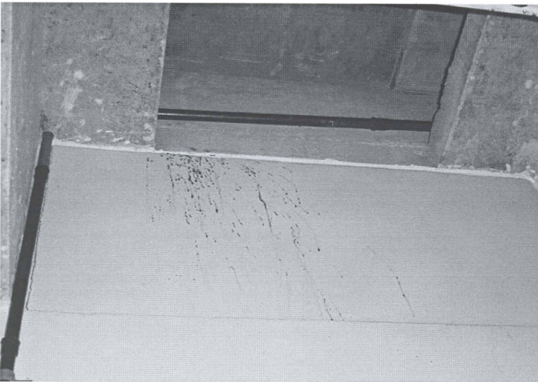
Fig. 6 - Guano nas paredes do laboratório de Doenças das Aves - EV/UFMG.
