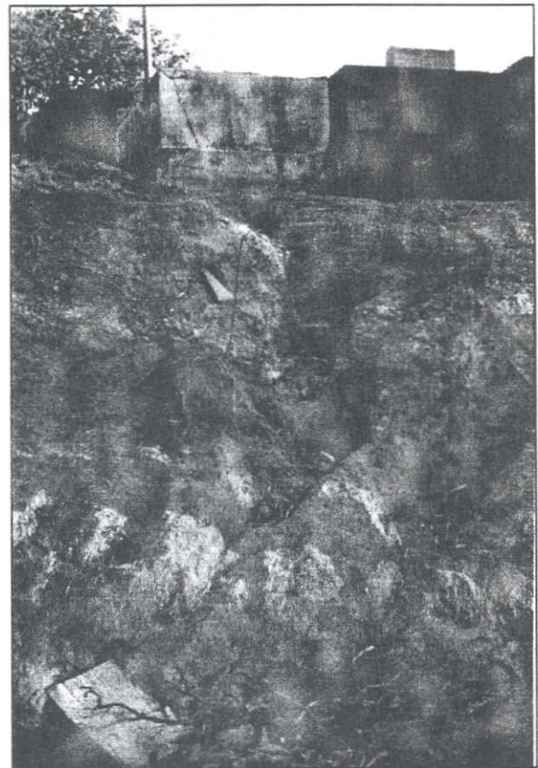
FIGURA 5 – Sulco de erosão e exposição a base da catatumba. Cemitério da Saudade.
