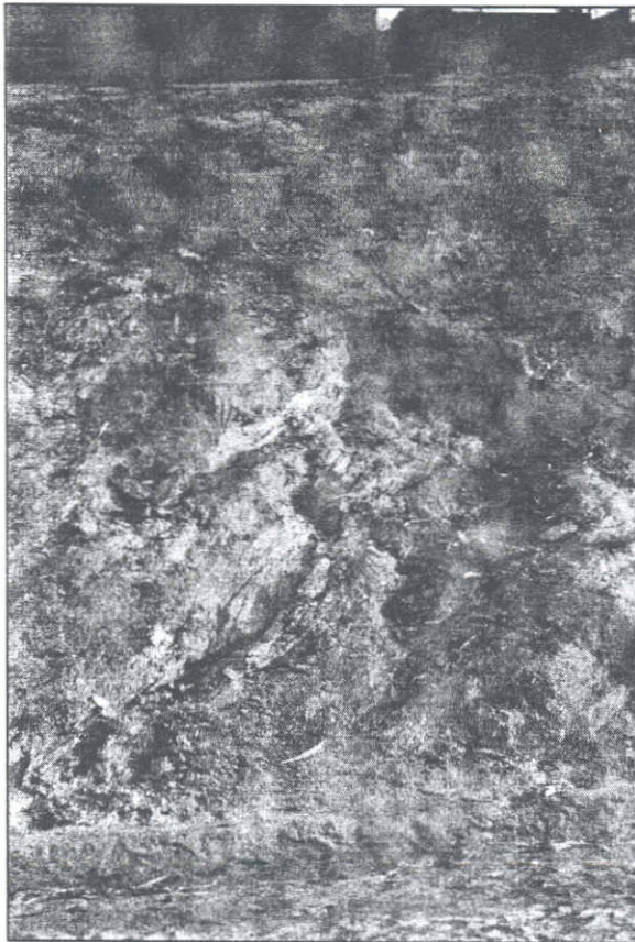
FIGURA 4 – Exposição dos filitos (Gr. Sabará). Ausência de vegetação para controle de erosão. Cemitério da Saudade.
