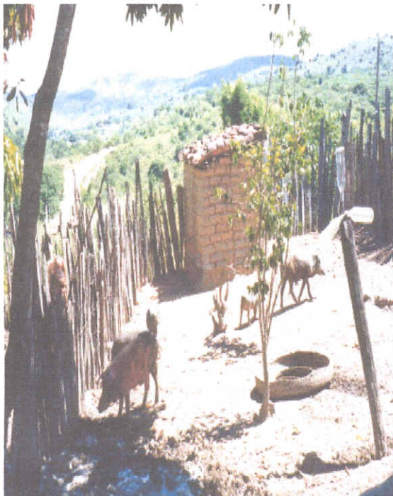
Figura 29: Sanitário instalado dentro do chiqueiro, Rubim, MG.
