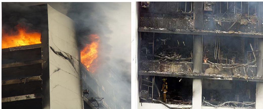
Fig.1.1 – Incêndio ocorrido no edifício da ELETROBRÁS, Rio de Janeiro, 2004.
